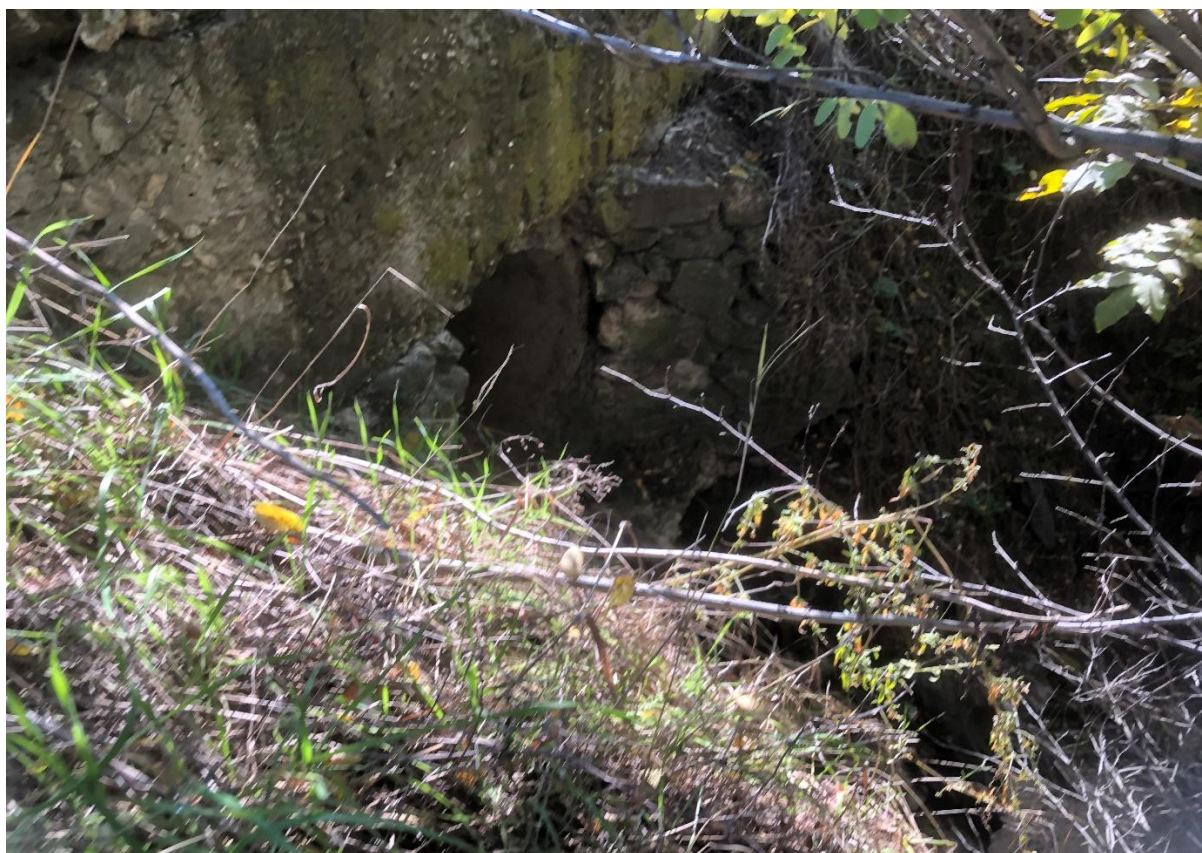
Foto 8 Conducta existentă de evacuare a apei în rigole \varnothing 0,8\text{m} pe aripa dreaptă a alunecării de teren la PK40+40 (Сущ. труба сброса воды в овраг \varnothing 0,8\text{m} на правом крыле оползня на ПК40+40)
