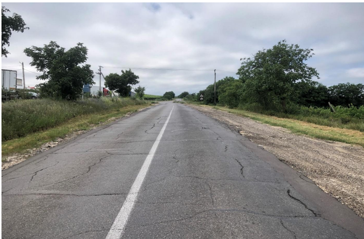
Foto 7 Suprafață de drum deformată în apropierea zonei de alunecare de teren la PK39+00 (Деформированное покрытие дороги вблизи оползневого участка на ПК39+00.)
