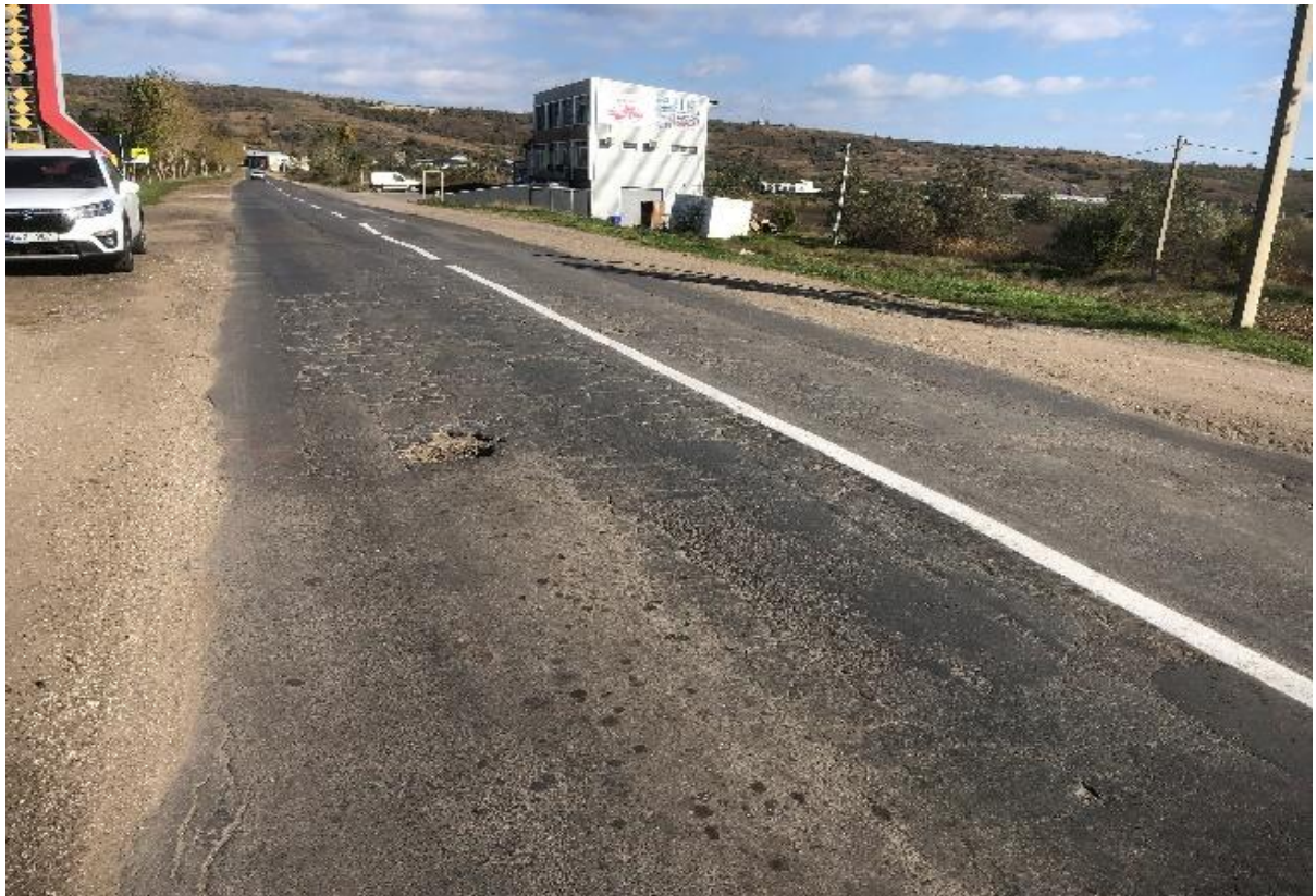
Foto 12 Rețea de fisuri pe carosabil, deformări și gropi individuale cu adâncimea de până la 10 cm, pe tronsonul PK84+00. (Сеть трещин на покрытие, прогибы и отдельные выбоины глубиной до 10 см, на участке трассы ПК84+00)
