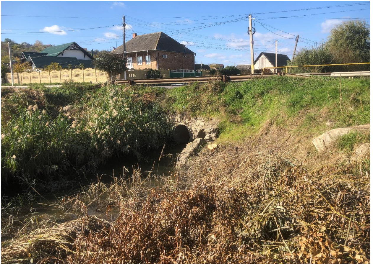
Foto 15 Conductă existentă la ieșirea PK85+24, deschideri prăbușite (Существующая труба на выходе ПК85+24, разрушены открылки)
