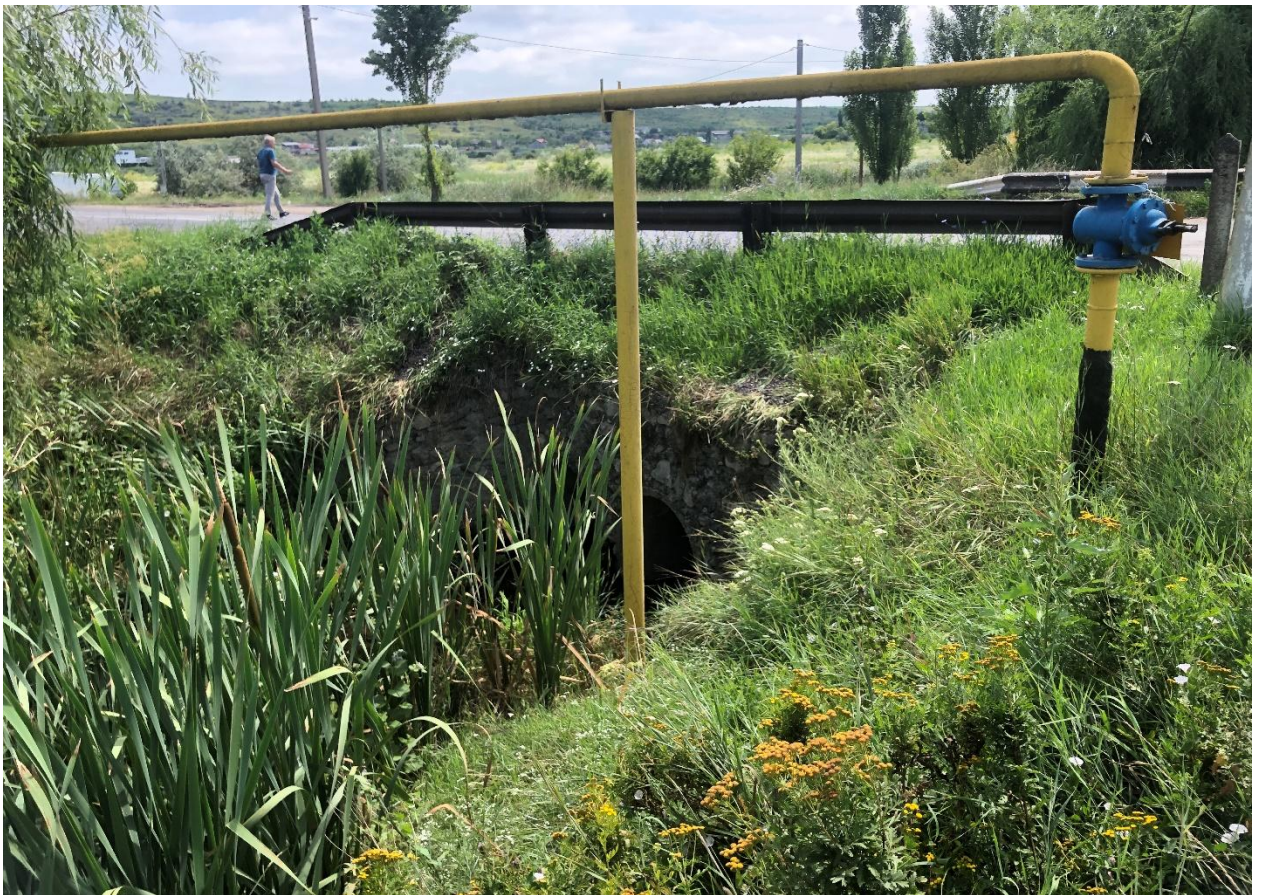
Foto 14 Podet existent 3(d=1,3)m la PC 85+24, intrare. (Существующая труба с тремя звеньями (Ø1,3м) на ПК85+24 км, вход)
