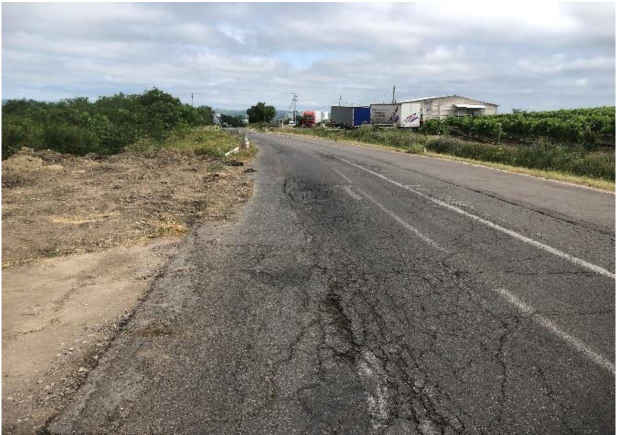
Foto 9 O secțiune de drum de urgență deformată de procesele de alunecare de teren. La PC 41+20 există deformări ale carosabilului, denivelări, fisuri frecvente sub formă de mici zgârieturi de alunecare de teren. (Аварийный участок дороги деформированный оползневыми процессами. Наблюдаются прогибы покрытия, сколы, частые трещины в виде мелких оползневых заколов на ПК 41+20)
