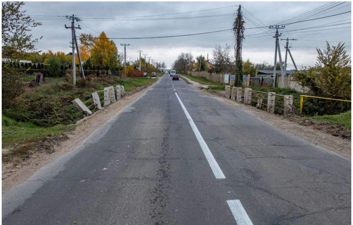
Foto 2 Pod de urgență la PC 24+64, vedere din satul Costești, barieră pietonală distrusă. (Аварийный мост на ПК24+64, вид со стороны с. Costești, разрушенное пешеходное ограждение)
