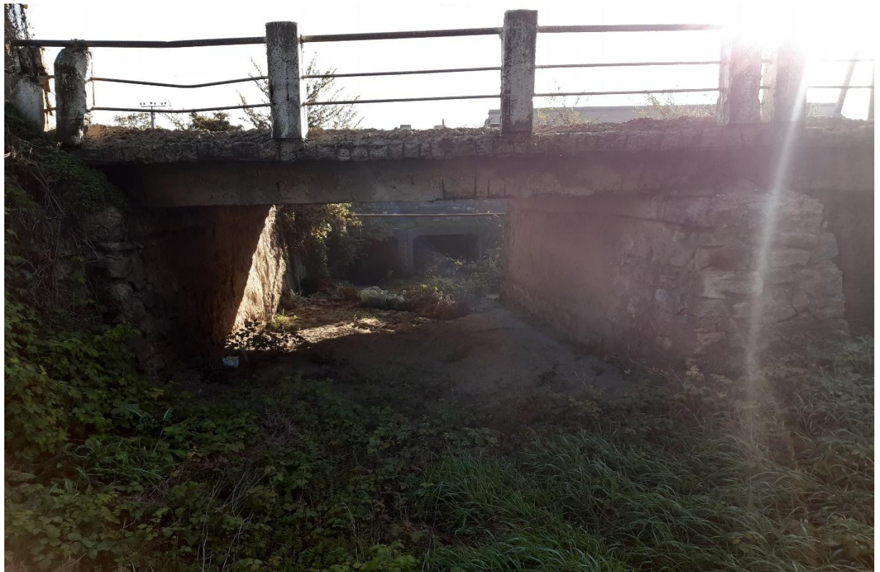
Foto 4 Podul de urgență, deformarea elementelor structurale ale cadrului podului, armătura deteriorată de coroziune pot fi observate. Stâlp de pod deformat și armătură inferioară (Аварийный мост, видны деформирование элементы конструкции каркаса моста, арматура, поврежденная коррозией. Деформированное опора моста и укрепление по дну)
