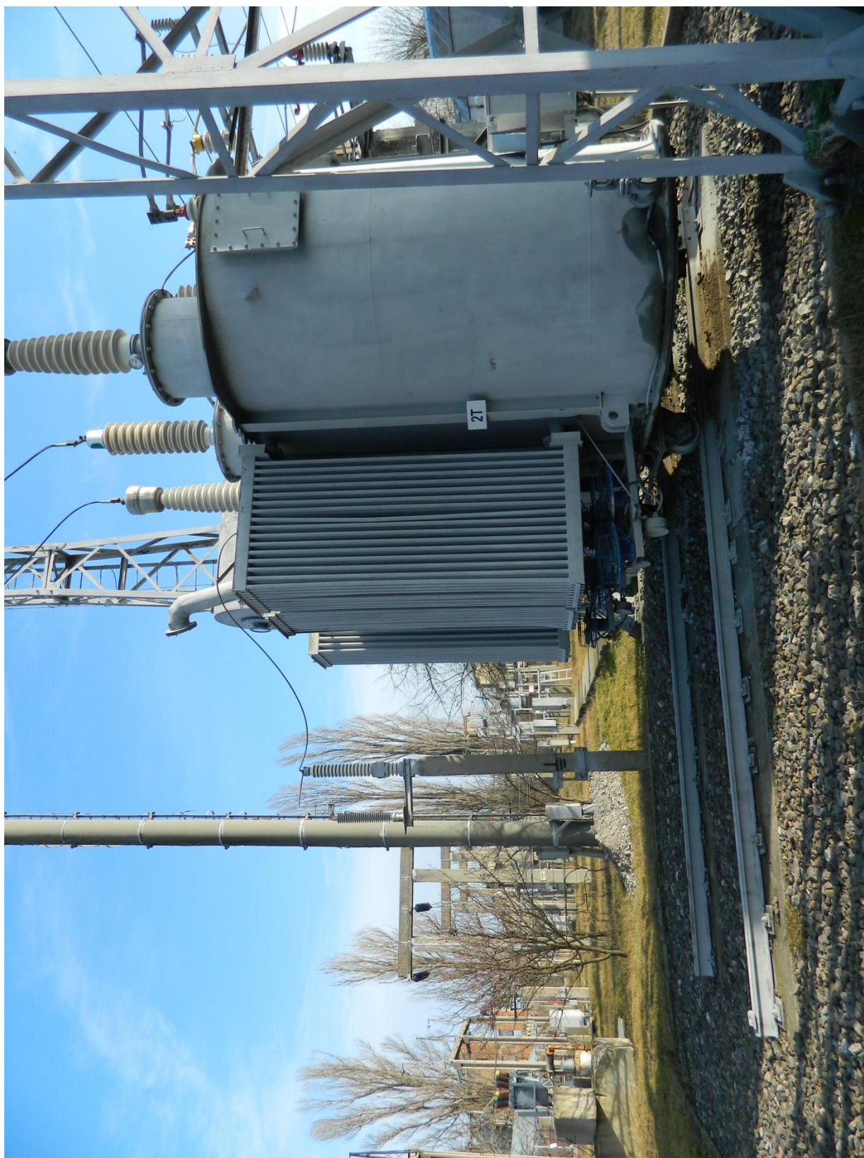
5. Transformatorul existent, vederea din partea de 110 kV.
