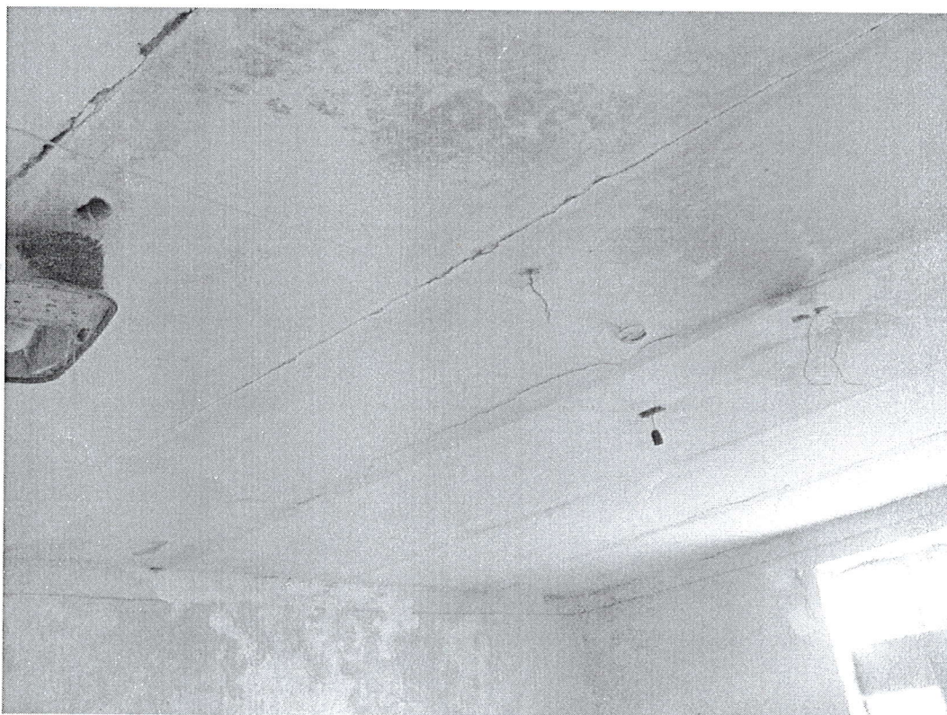
Anexa 8: Degradarea elementelor de construcții în urma curgerii acoperișului la blocul de studii.
