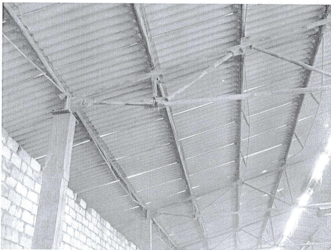
Anexa 23: Îmbinarea elementelor fermelor de metal a depozitului de pe terenul fostei școli de meserii nr.15 din or. Cantemir.
