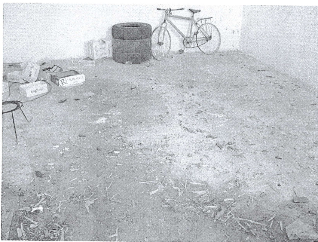
Anexa 18: Starea tehnică a încăperilor căminului fostei școli de meserii nr.15 din or. Cantemir.
