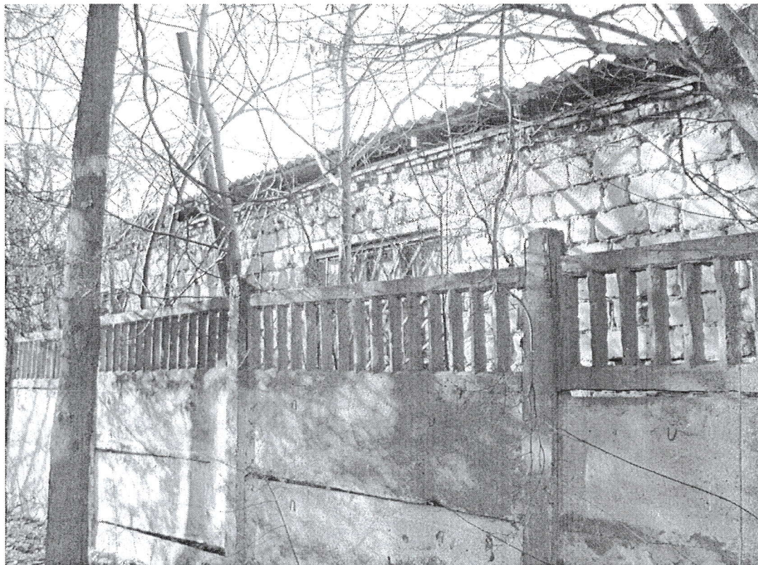
Anexa 6: Fațada laterală și din spate a blocului de studii a fostei școli de meserii nr.15 din or. Cantemir.
