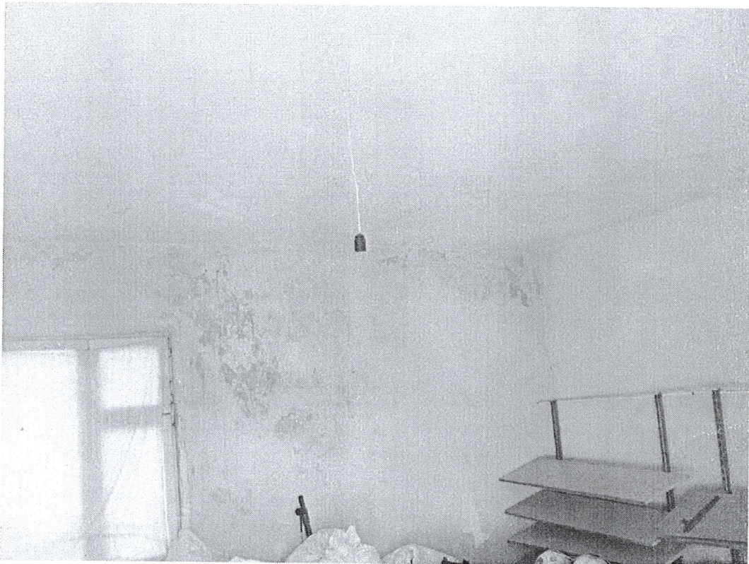
Anexa 11: Degradarea elementelor de construcții a blocului administrativ de la curgerea acoperișului.
