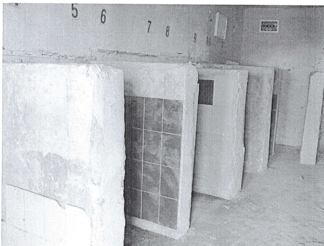
Anexa 14: Starea tehnică a încăperilor atelierului pentru instruirea practică.
