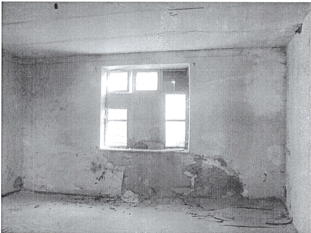
Anexa 7: Starea tehnică a încăperilor blocului de studii.
