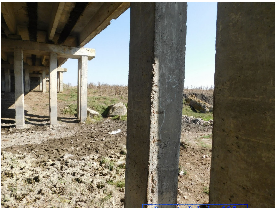
Foto 56. Pila 3. Piloții 1. Exfolierea betonului. Armături fără strat de acoperire. Crăpături verticale.
