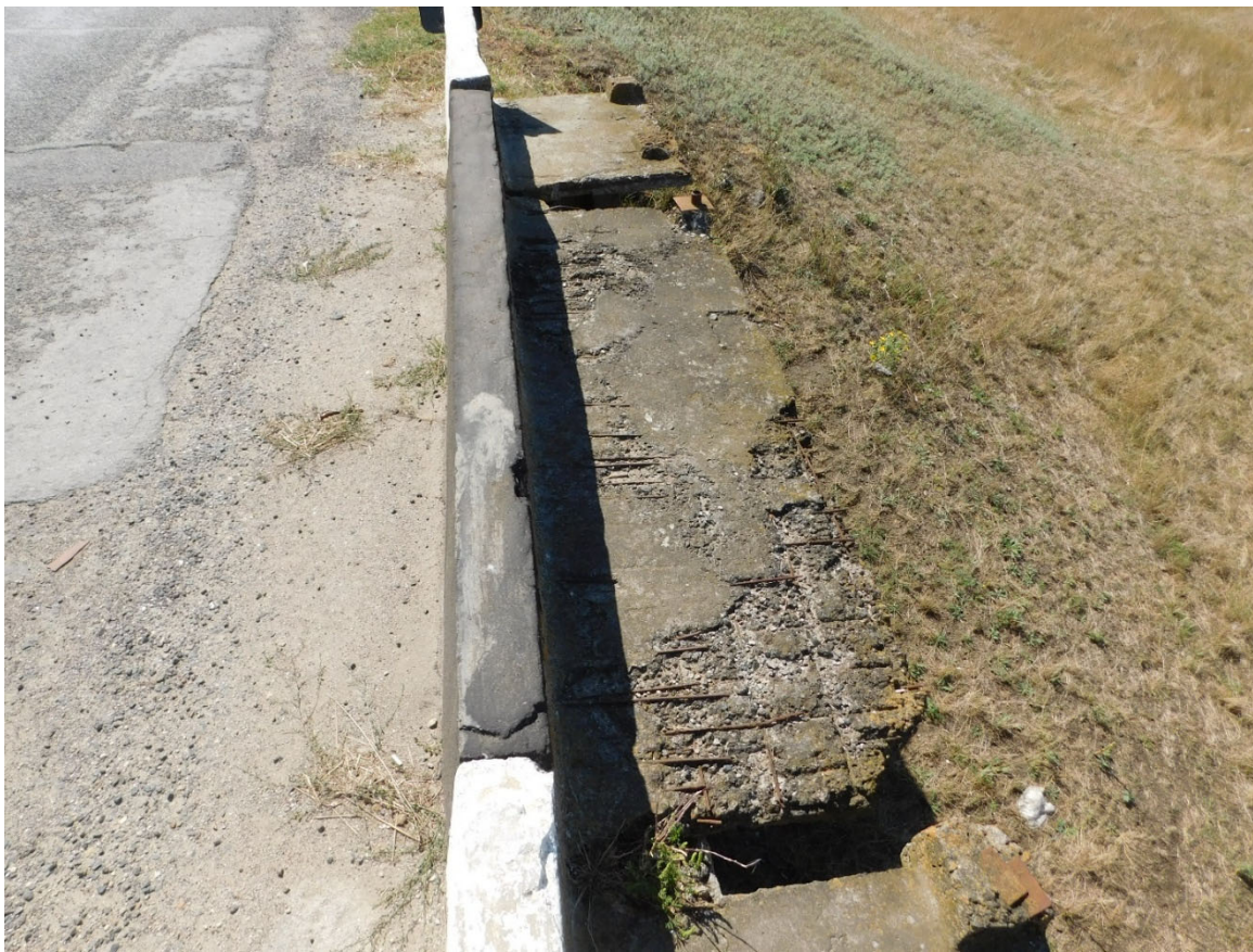
Foto 11. Trotuarul drept. Degradarea plăcii de trotuar. Lipsa parapetului pietonal.
