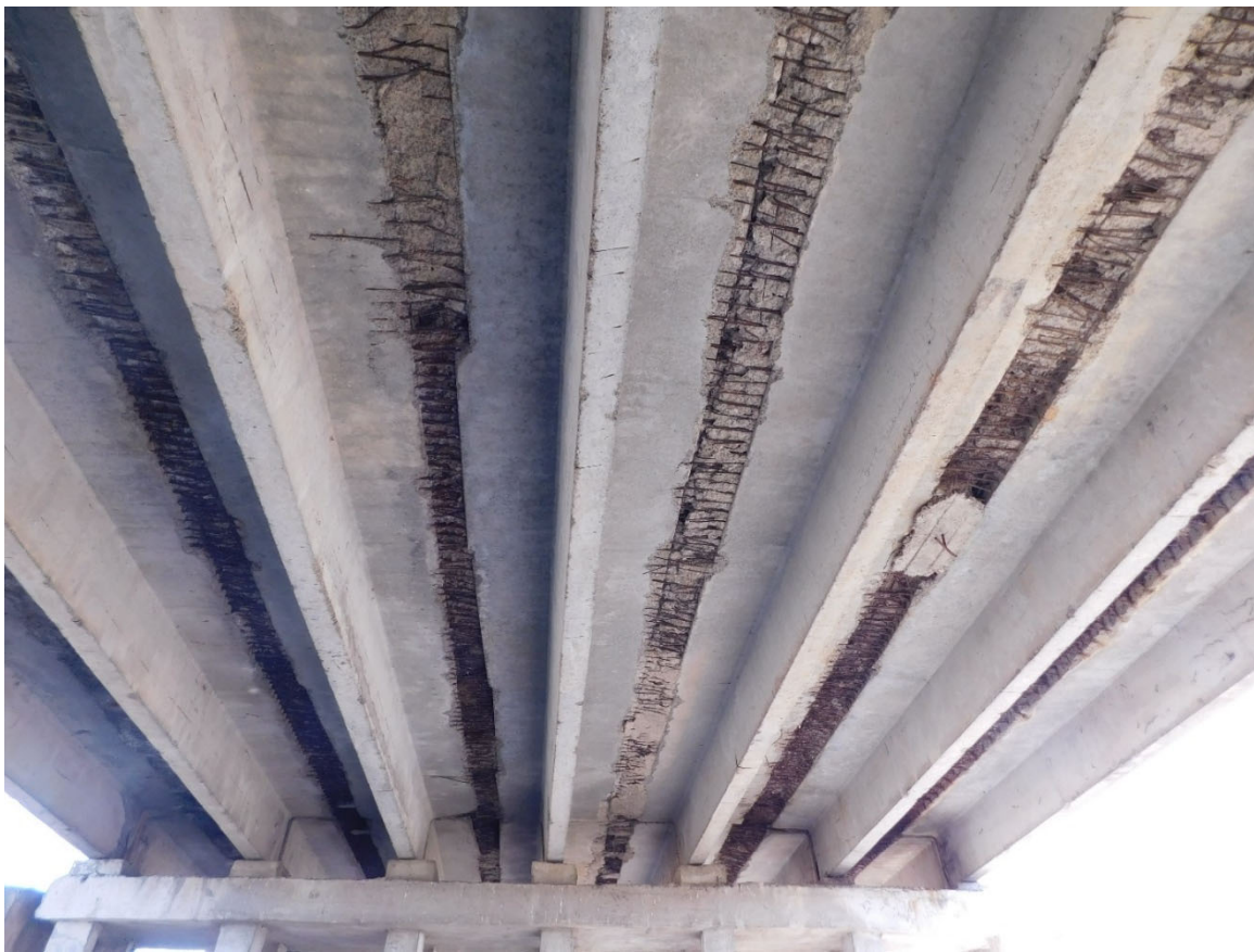
Foto 19. Deschiderea 3-4. Nodul de îmbinare a plăcilor dintre grinzi. Coroziunea avansată a betonului și a armaturii, cu modificarea secțiunii plăcii și armaturii.
