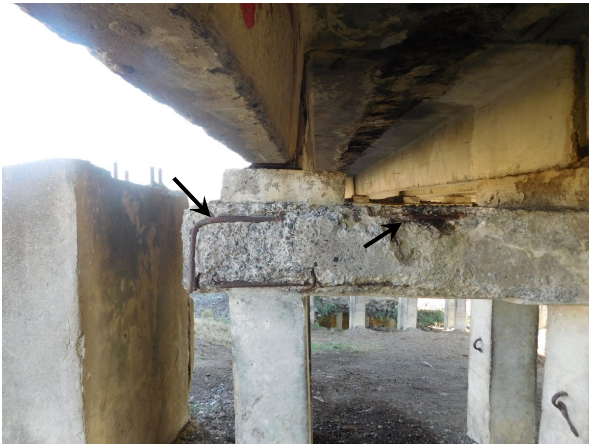
Foto 53. Pila 2. Rigla. Armături fără strat de acoperire. Coroziunea armaturii. Degradarea betonului riglei cu reducerea secțiunii. Agregate la suprafață. Sparghețul în amonte de pila 2, cu o crăpătură verticală pe betonul elevației.
