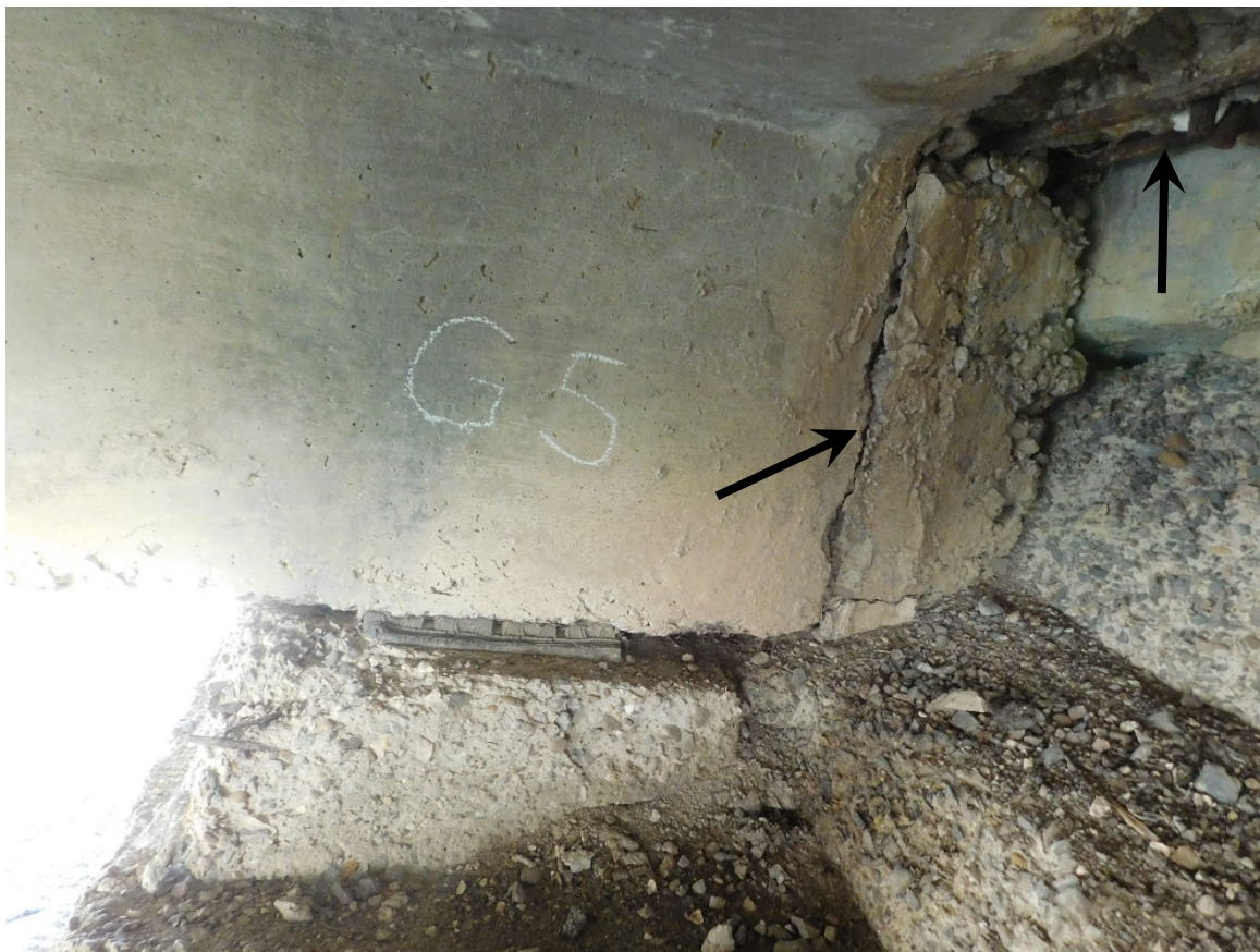
Foto 41. Culeea 1. Grinda 3. Deschiderea 1-2. Alungirea incorectă a nervurii și plăcii grinzii. Degradarea cuzinetului. Armături fără strat de acoperire. Degradarea zidului de gardă.
