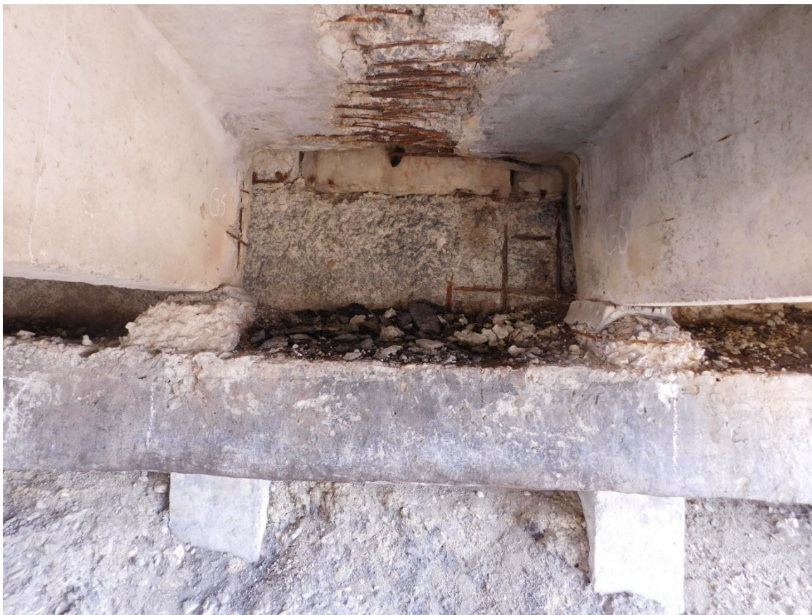
Foto 51. Culeea 7. Degradarea cuzinețelor. Degradarea zidului de gardă cu micșorarea secțiunii. Suprastructura 5-6. Grinzile 5 și 6. Coroziunea betonului și a armaturii nodului de îmbinare a plăcilor grinzilor.
