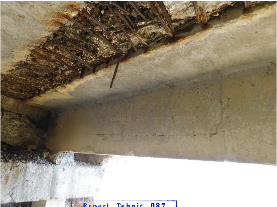
Foto 26. Deschiderea 6-7. Nodul de îmbinare a plăcilor dintre grinzi. Coroziunea avansată a betonului și a armaturii, cu modificarea secțiunii plăcii și armaturii.
