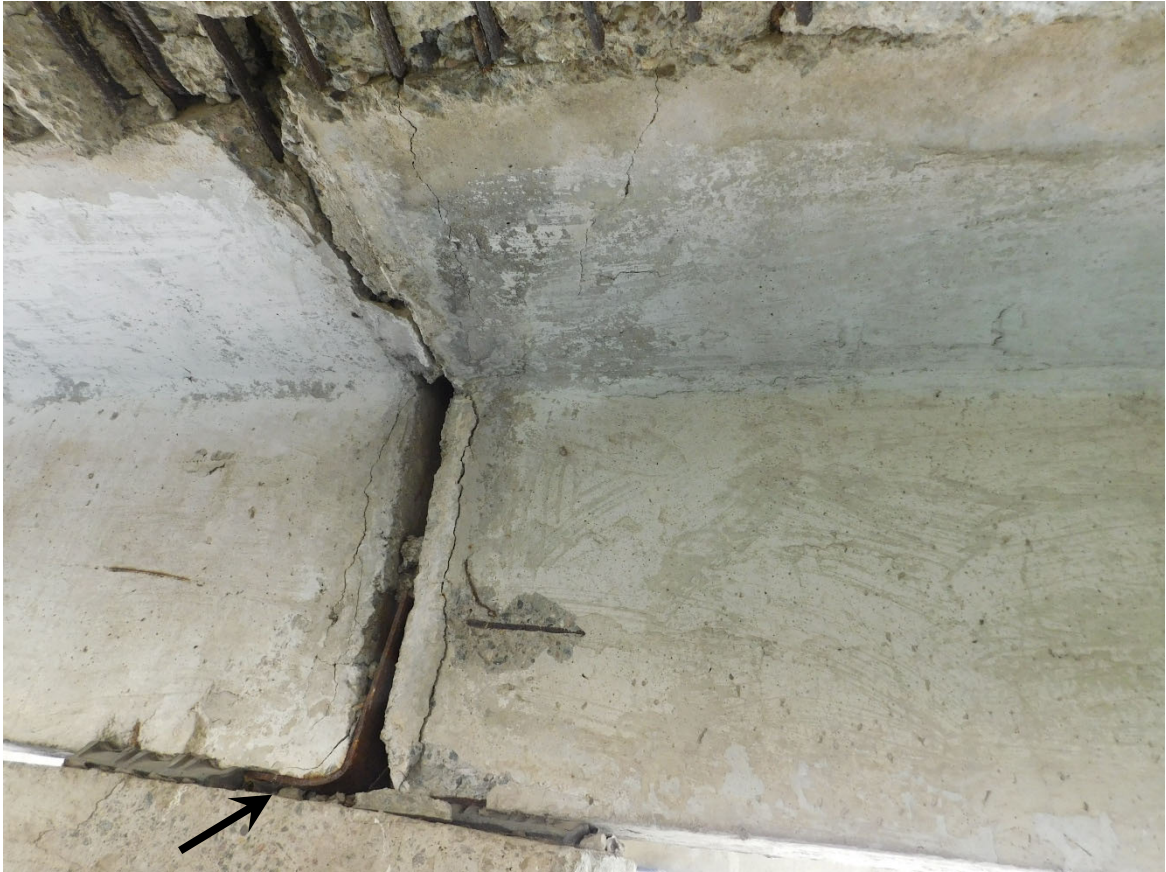
Foto 43. Pila 2. Grinda 2. Deschiderea 1-2. Rezemarea incorectă a grinzii (rezemare pe colțul grinzii).
