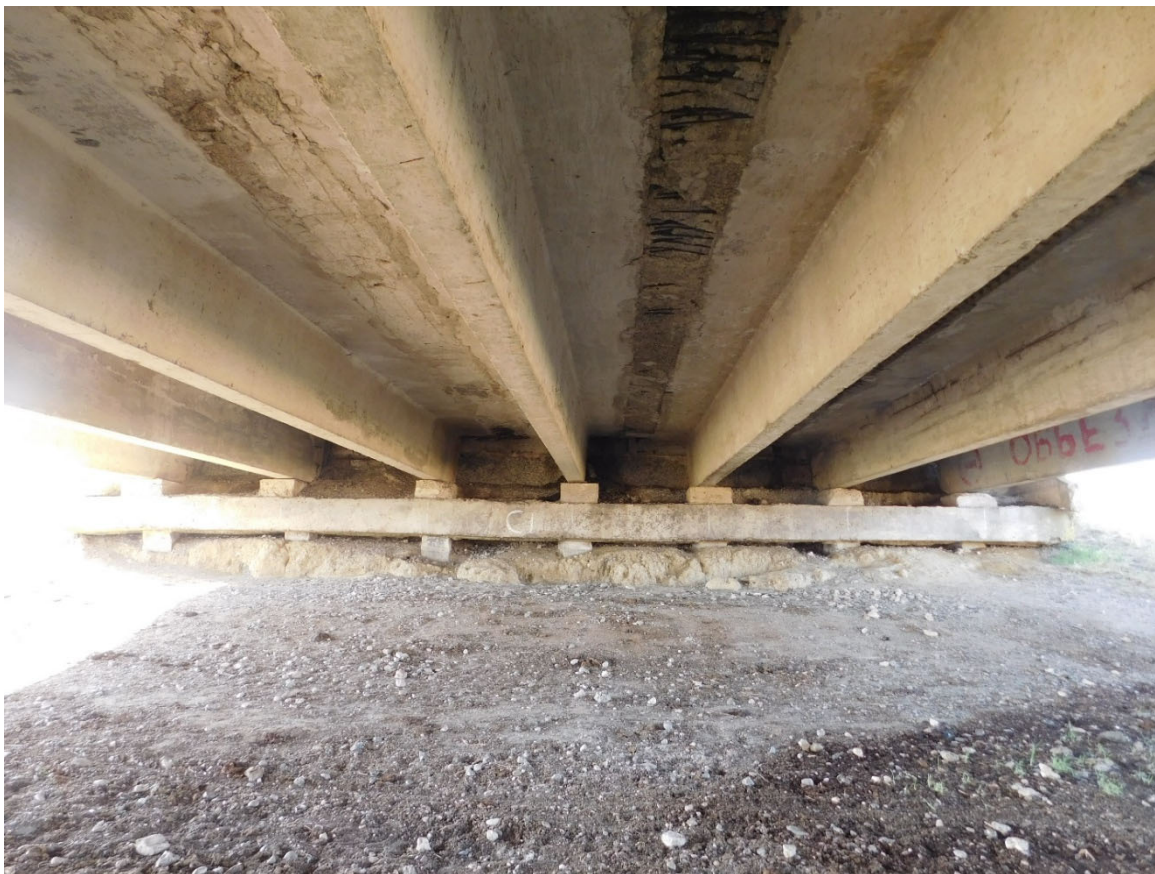
Foto 59. Culeea 1. Lipsa lucrărilor de protecție a taluzurilor. Eroziunea umpluturii sfertului de con, cu dezvelirea riglei și piloților culeei.
