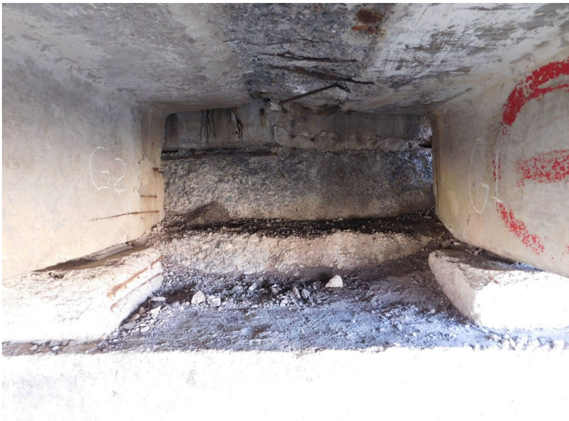
Foto 49. Culeea 1. Degradarea betonului și coroziunea armaturii cuzineților. Exfolierea betonului și coroziunea armaturii grinzii 6(6-7). Degradarea betonului și coroziunea armaturii zidului de gardă.
