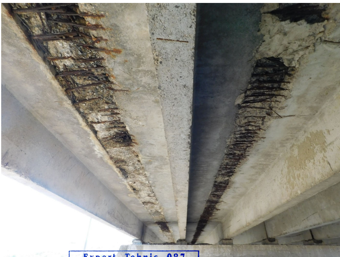
Foto 22. Deschiderea 6-7. Nodul de îmbinare a plăcilor dintre grinzi. Coroziunea avansată a betonului și a armaturii, cu modificarea secțiunii plăcii și armaturii.
