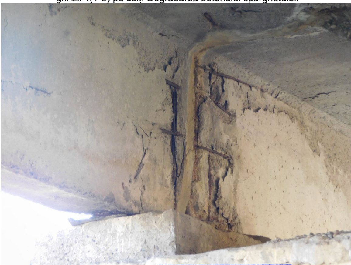
Foto 46. Pila 3. Exfolierea betonului și coroziunea avansată a armaturii grinzilor în zona de rezemare.
