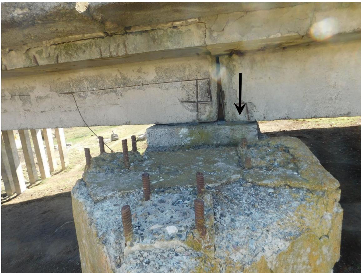
Foto 45. Pila 2. Exfolierea betonului și coroziunea avansată a armaturii grinzilor în zona de rezemare. Dezașări între axele de rezemare a grinzilor și axa riglei. Rezemarea incorectă a grinzii 1(1-2) pe colț. Degradarea betonului sparghețului.
