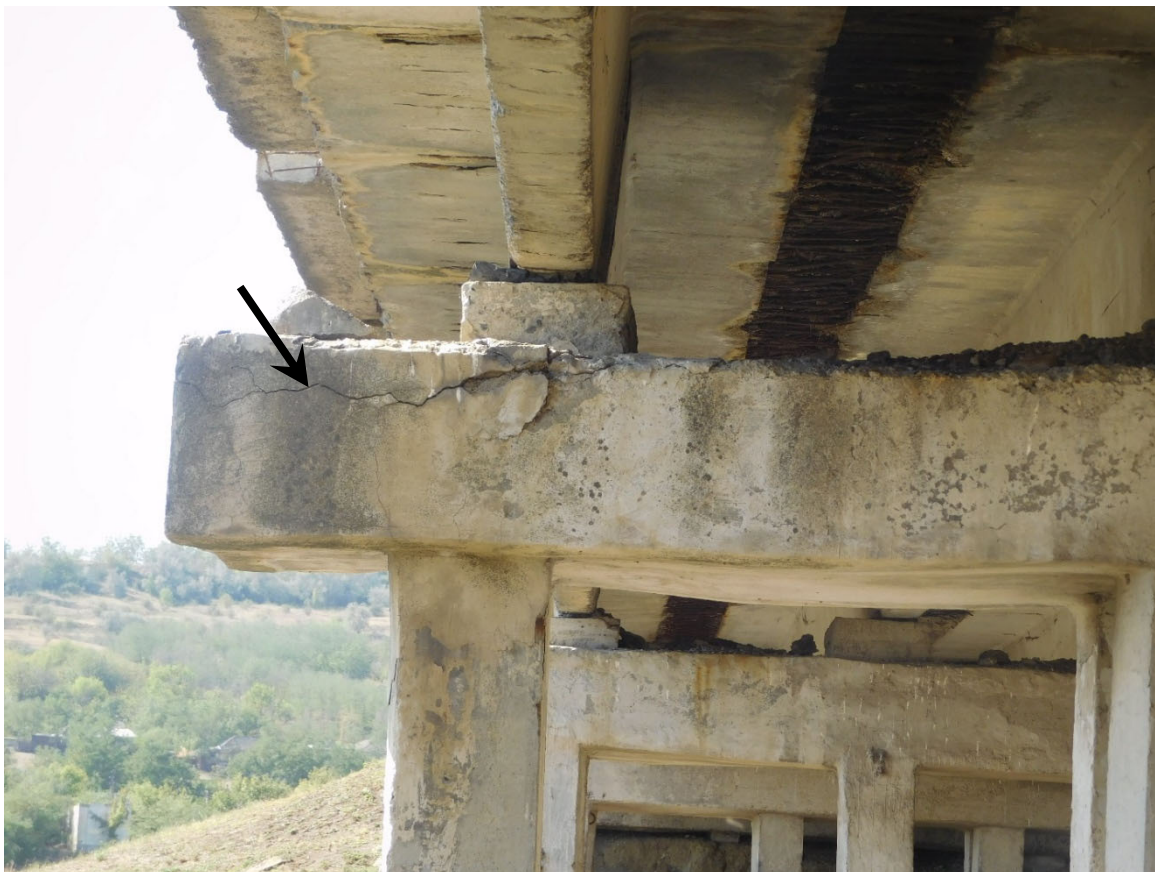
Foto 57. Pila 4. Armături fără strat de acoperire. Crăpătură orizontală pe riglă. Exfolierea betonului. Defecte de suprafață ale feței văzute (culoare neuniformă, pete negre, pete de rugină, aspect macroporos, agregate la suprafață).
