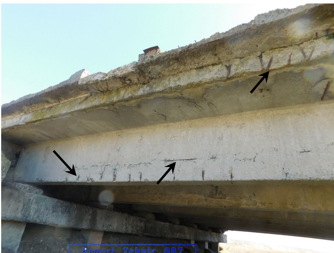
Foto 32. Culeea 7. Deschiderea 6-7. Gr. 1. Exfolierea betonului și coroziunea armaturii
