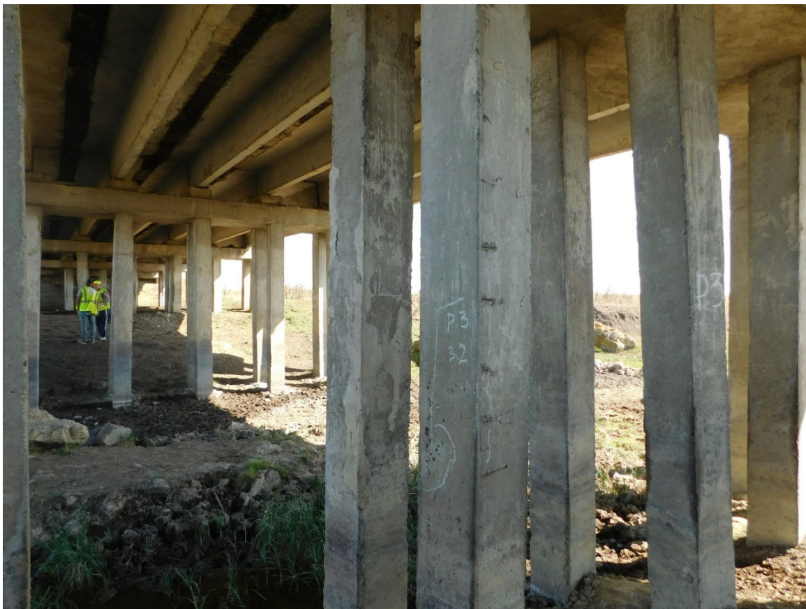
Foto 55. Pila 3. Piloții 3 și 4. Exfolierea betonului. Armături fără strat de acoperire. Crăpături verticale.
