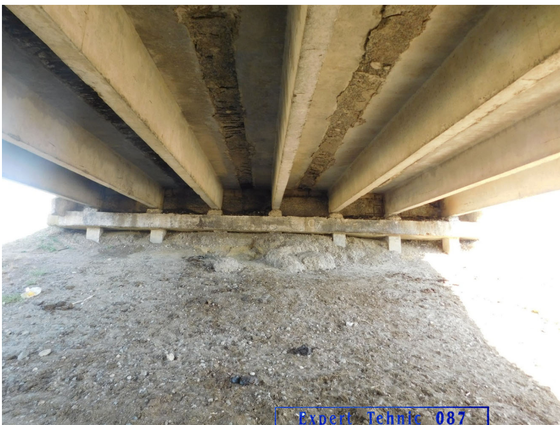
Foto 60. Culeea 7. Lipsa lucrărilor de protecție a taluzurilor. Eroziunea umpluturii sfertului de con, cu dezvelirea riglei și piloților culeei.
