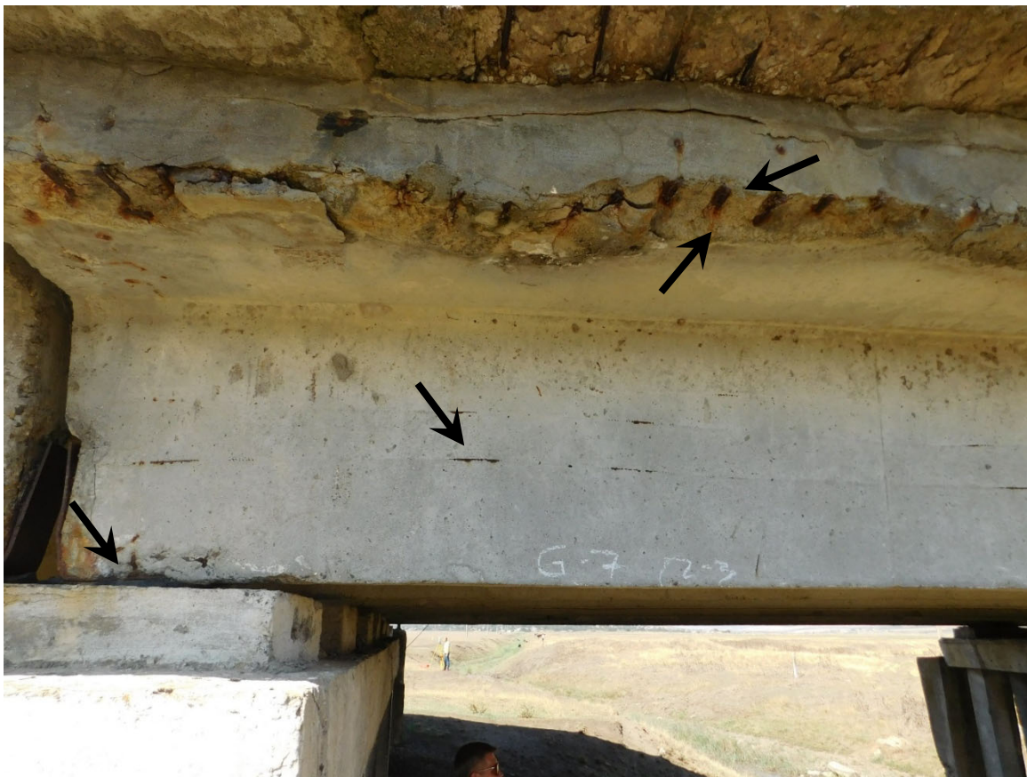
Foto 33. Culeea 7. Deschiderea 2-3. Exfolierea betonului și coroziunea avansată a armaturii grinzii 7.
