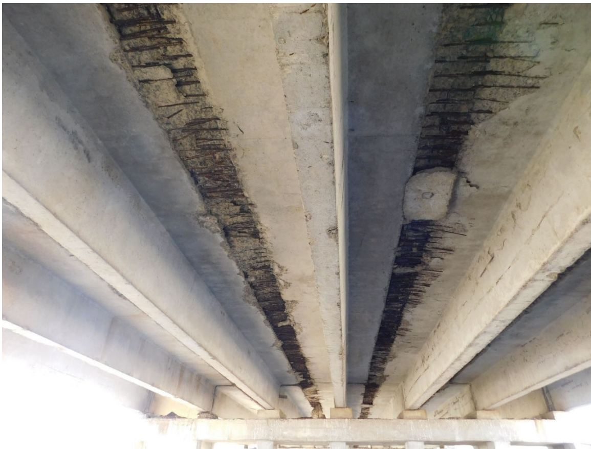
Foto 21. Deschiderea 5-6. Nodul de îmbinare a plăcilor dintre grinzi. Coroziunea avansată a betonului și a armaturii, cu modificarea secțiunii plăcii și armaturii.
