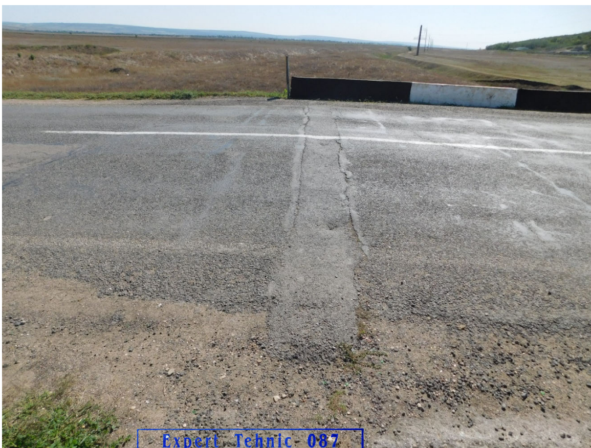
Foto 16. Rama și calea podului la sfârșit de pod. Postul 7. Crăpături, denivelări pe suprafața îmbrăcămintei asfaltice. Tășarea părții carosabile pe rampa de acces.
