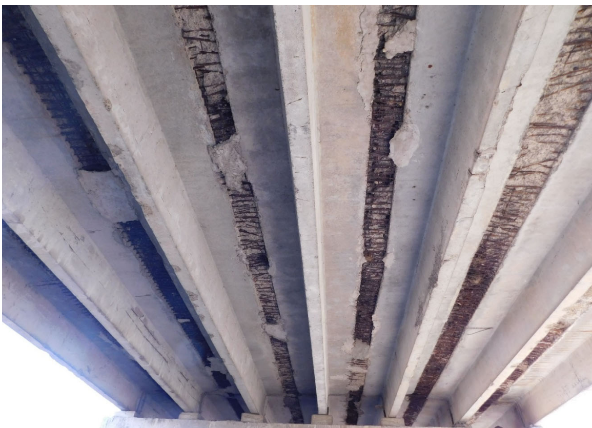
Foto 20. Deschiderea 4-5. Nodul de îmbinare a plăcilor dintre grinzi. Coroziunea avansată a betonului și a armaturii, cu modificarea secțiunii plăcii și armaturii.
