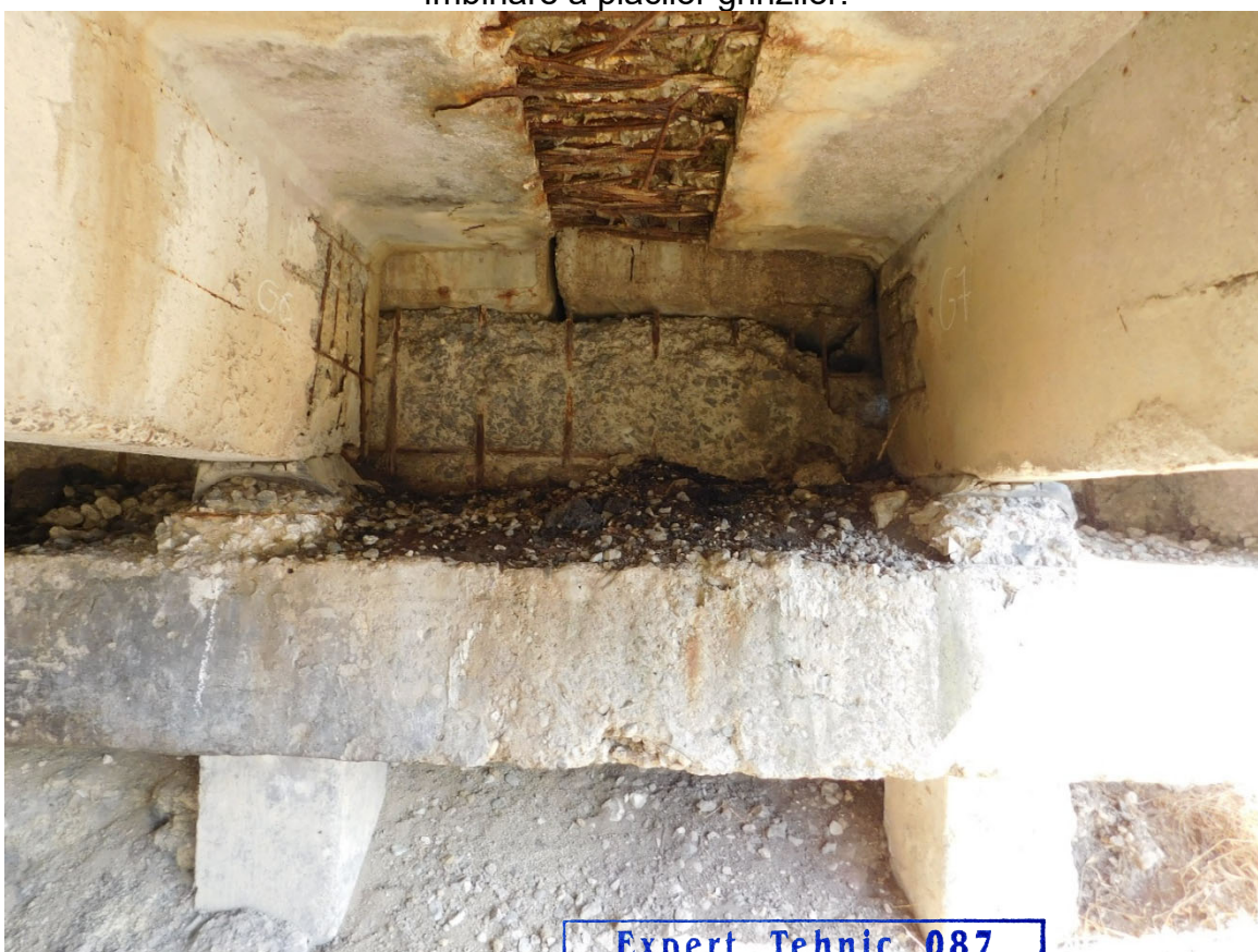
Foto 52. Culeea 7. Degradarea cuzinețelor. Degradarea betonului zidului de gardă cu micșorarea secțiunii. Coroziunea armaturii. Exfolierea betonului și coroziunea armaturii grinzilor 6 și 7(6-7). Coroziunea avansată a betonului și a armaturii îmbinării plăcilor grinzilor.
