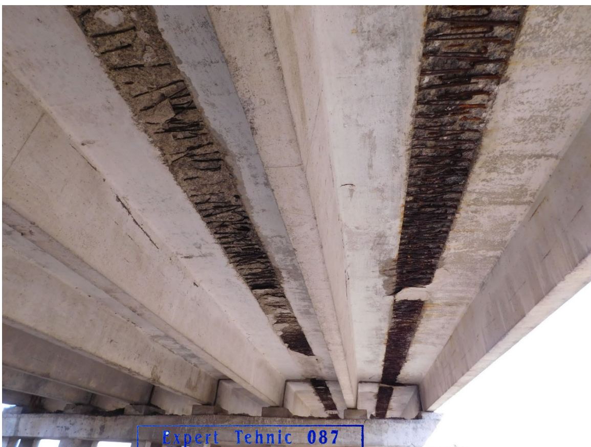
Foto 18. Deschiderea 2-3. Nodul de îmbinare a plăcilor dintre grinzi. Coroziunea avansată a betonului și a armaturii, cu modificarea secțiunii plăcii și armaturii.
