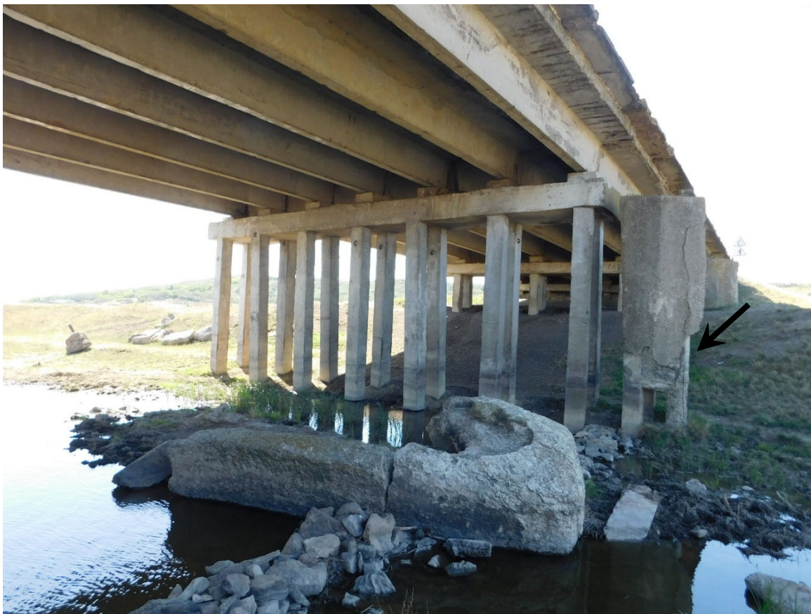
Foto 61. Deschiderea 3-4 la intrare sub pod. Pila 3. Sparghețul în amonte de pila 3, cu o crăpătură verticală pe betonul elevației, și detașarea betonului la poale. Albia r. Ciulucul Mic. Prezența obstacolelor (bolovani din beton ciclopian).
