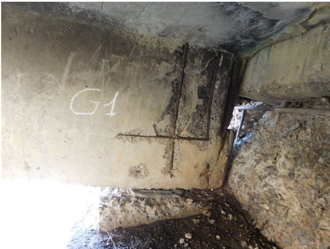
Foto 47. Culeea 7. Degradarea cuzinețelor. Exfolierea betonului și coroziunea avansată a armaturii grinzii 6(6-7). Degradarea betonului și coroziunea armaturii zidului de gardă.
