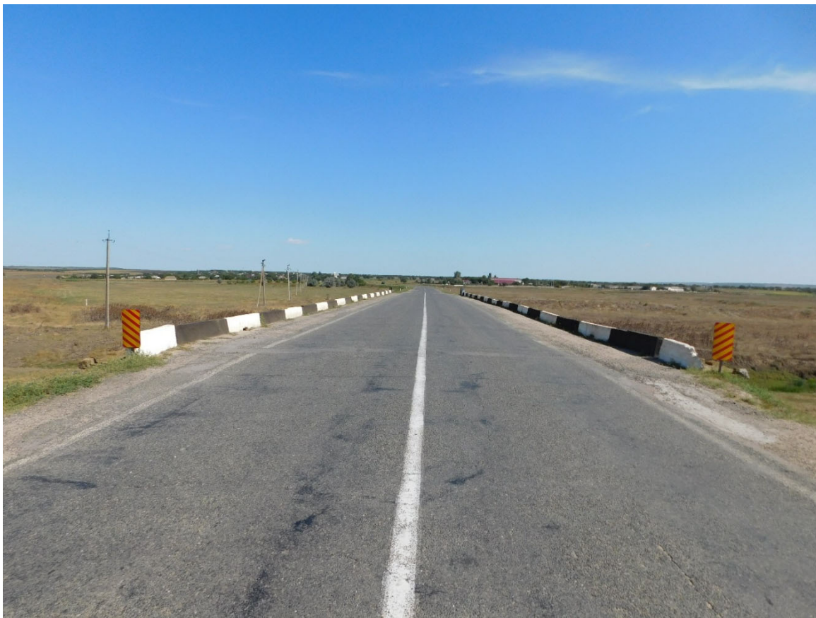
Foto 5. Calea podului. Vedere la început de pod. Parapet de siguranță rutieră cu înălțime necorespunzătoare, lipsa indicatoarelor informaționale și de restricție a vitezei.
