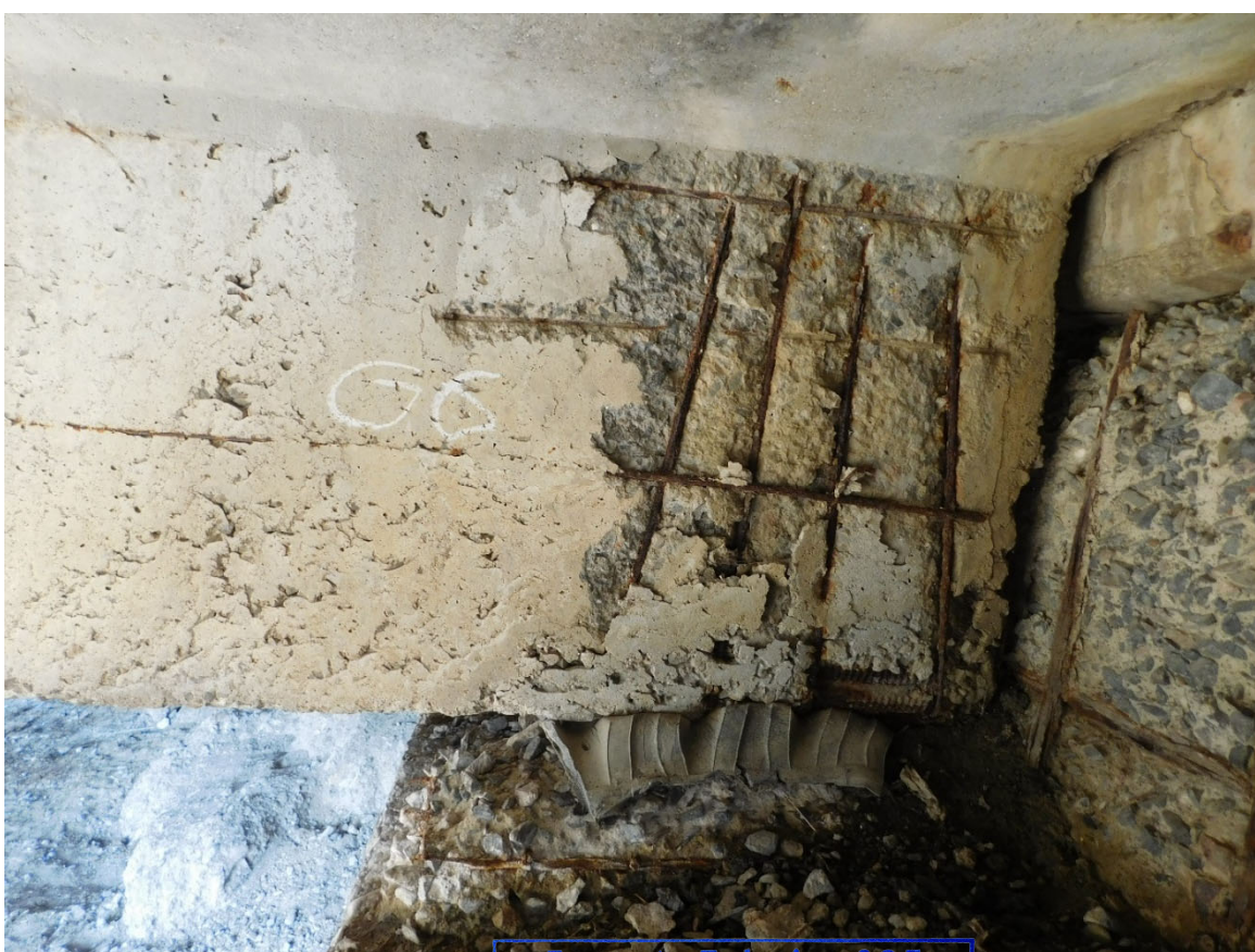
Foto 48. Culeea 7. Degradarea betonului și coroziunea armaturii cuzinețelor. Deformarea aparatului de reazem a grinzii. Exfolierea betonului și coroziunea avansată a armaturii grinzii 6(6-7). Degradarea betonului și coroziunea armaturii zidului de gardă.
