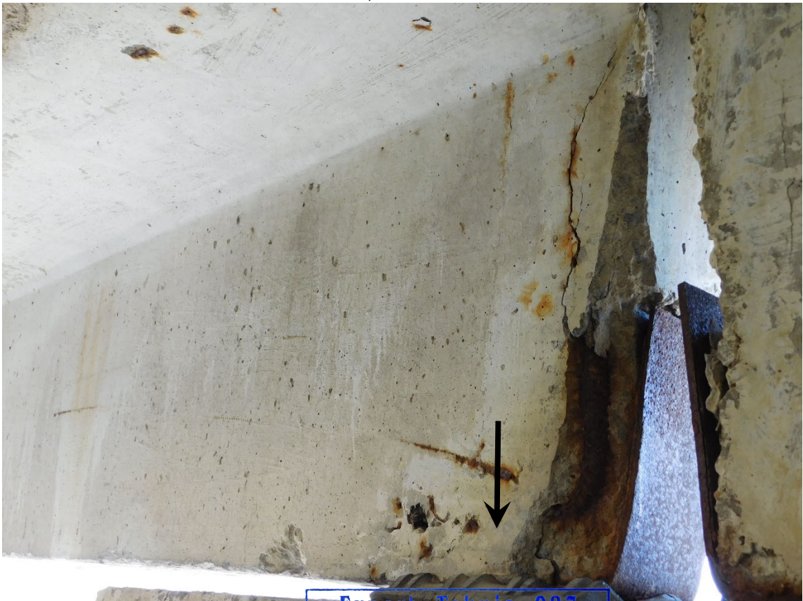
Foto 44. Pila 3. Grinda 7. Deschiderea 2-3. Rezemarea incorectă a grinzii (rezemare pe colțul grinzii).
