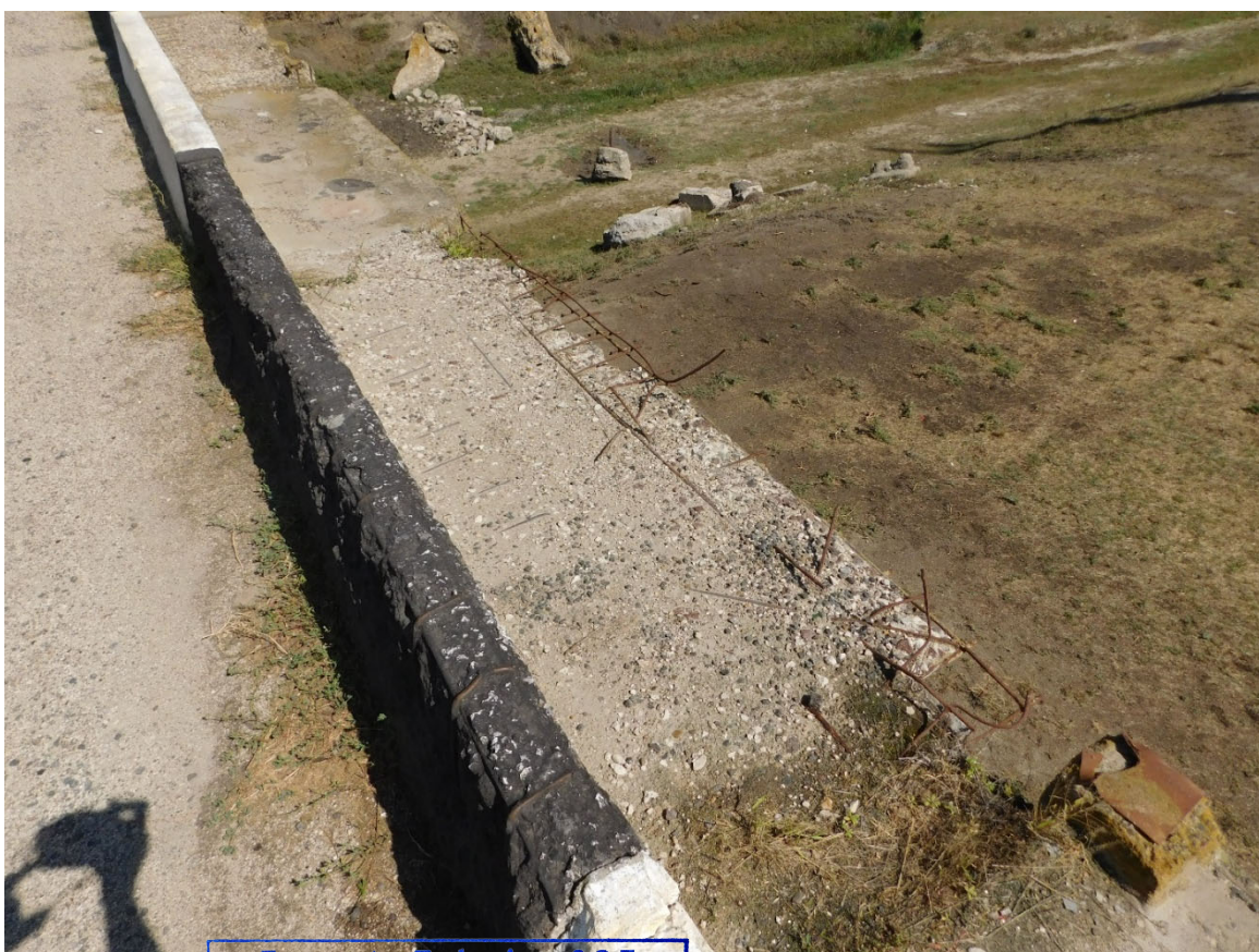
Foto 12. Trotuarul drept. Degradarea consolelor plăcilor de trotuar. Beton friabil a plăcii de trotuar. Lipsă parapetului pietonal.
