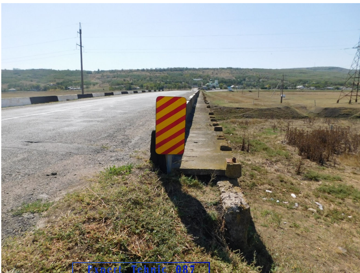
Foto 14. Calea podului. Trotuarul stâng. Acces dificil pe trotuar. Lipsa parapetului pietonal.
