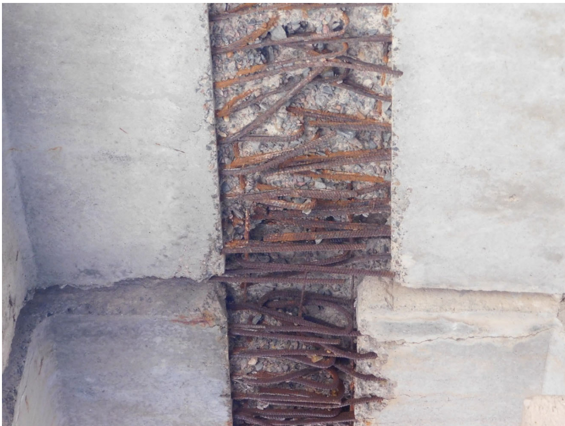
Foto 23. Deschiderea 4-5. Nodul de îmbinare a plăcilor dintre grinzi. Coroziunea avansată a betonului și a armaturii, cu modificarea secțiunii plăcii și armaturii.
