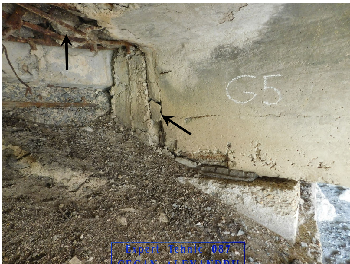
Foto 42. Culeea 1. Grinda 3. Deschiderea 1-2. Alungirea incorectă a nervurii și plăcii grinzii. Armături fără strat de acoperire. Prezența molozului.
