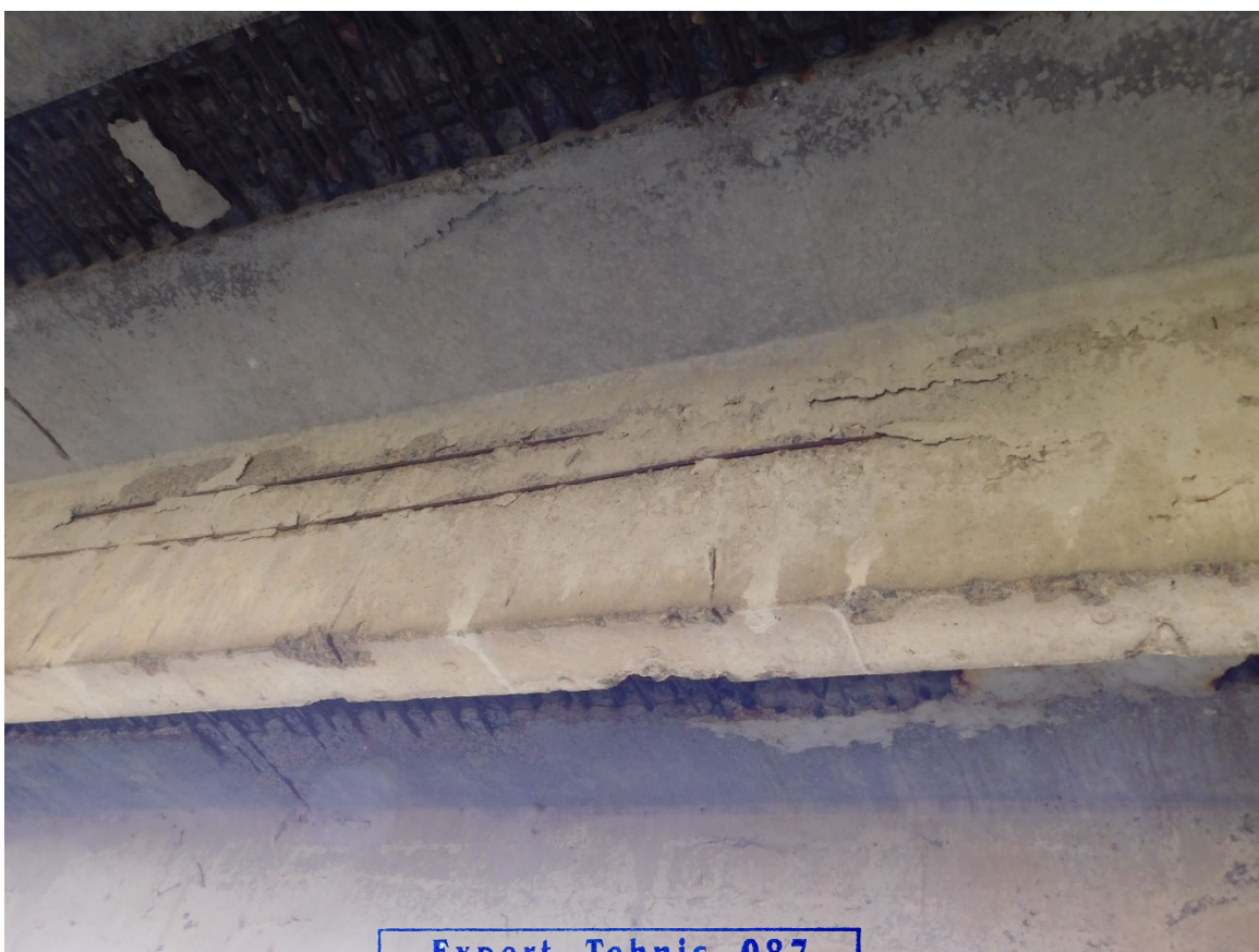
Foto 30. Deschiderea 4-5 Gr. 3. Exfolierea betonului. Armături fără strat de acoperire.
