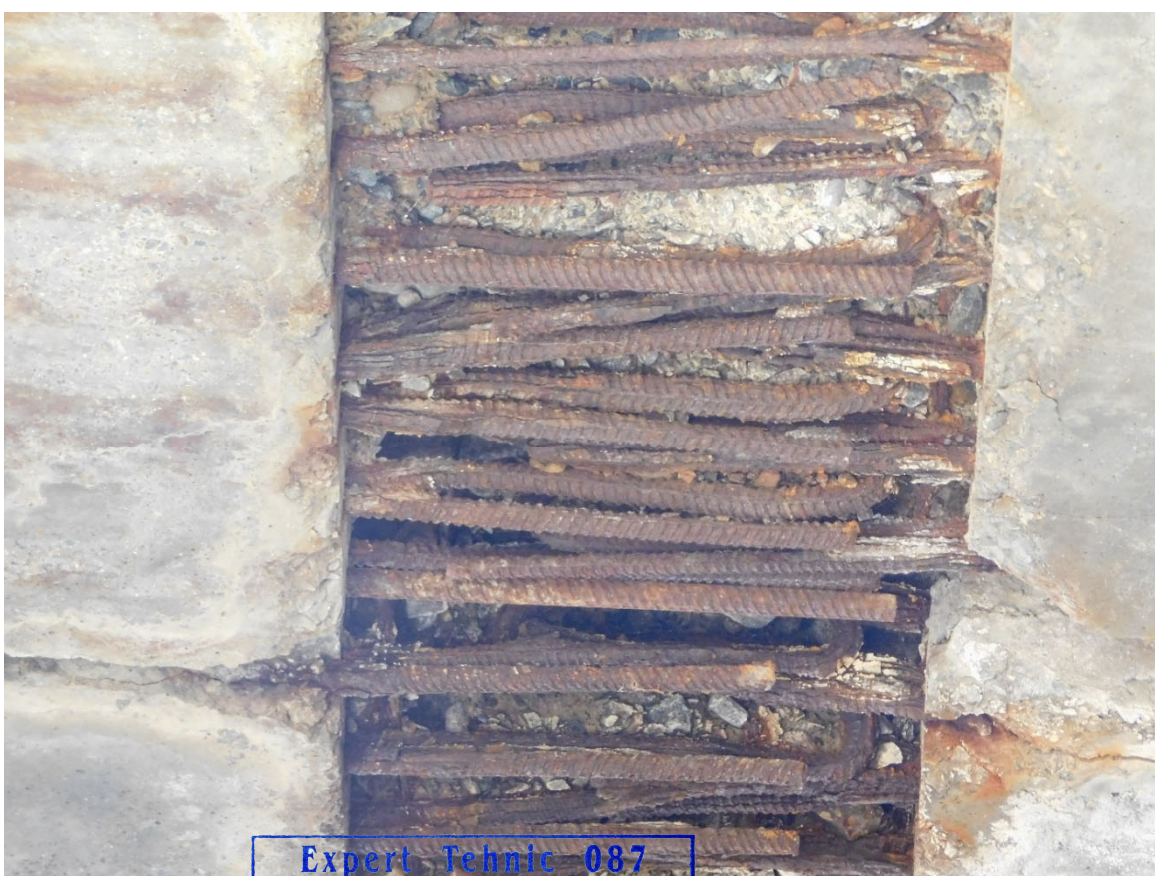
Foto 24. Deschiderea 4-5. Nodul de îmbinare a plăcilor dintre grinzi. Coroziunea avansată a betonului și a armaturii, cu modificarea secțiunii plăcii și armaturii.
