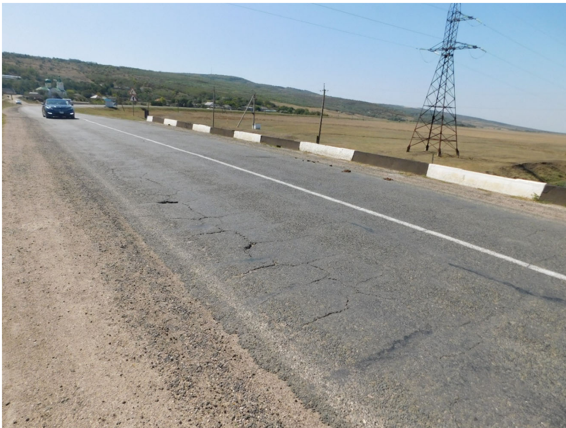
Foto 15. Calea podului. Fisuri longitudinale și transversale pe îmbrăcămintea safaltică. Prezența pietrișului cu nisip. Parapet de siguranță rutieră cu înălțime necorespunzătoare.
