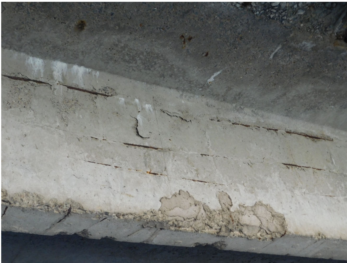
Foto 31. Deschiderea 5-6. Exfolierea betonului. Armaturi fără strat de acoperire.
