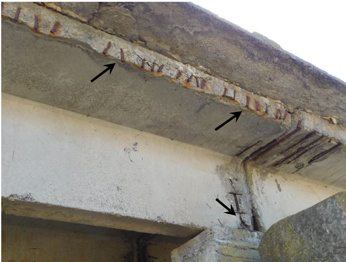
Foto 35. Podul stâng. Pila 3. Grinda 1(3-4) și Grinda 1(2-3). Exfolierea betonului și corозиunea avansată a armaturii grinzilor în zona de rezemare și la intradosul plăcii în consolă.
