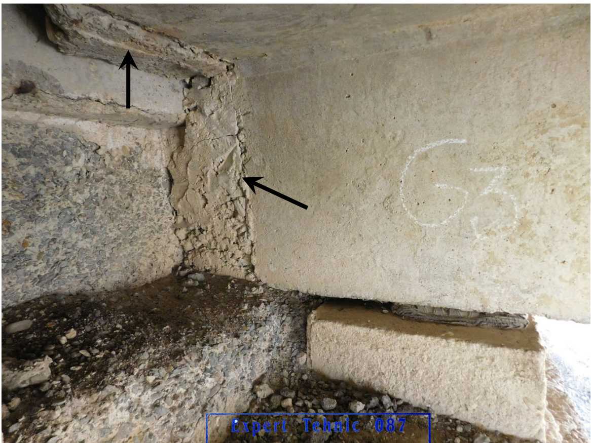
Foto 40. Culeea 1. Grinda 3. Deschiderea 1-2. Alungirea incorectă a nervurii și plăcii grinzii.
