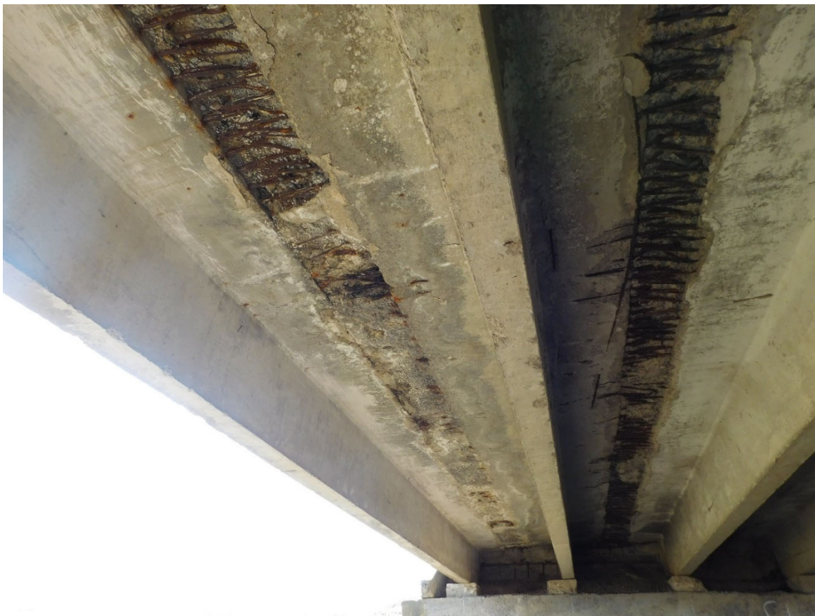
Foto 17. Deschiderea 1-2. Nodul de îmbinare a plăcilor dintre grinzi. Coroziunea avansată a betonului și a armaturii, cu modificarea secțiunii plăcii și armaturii.
