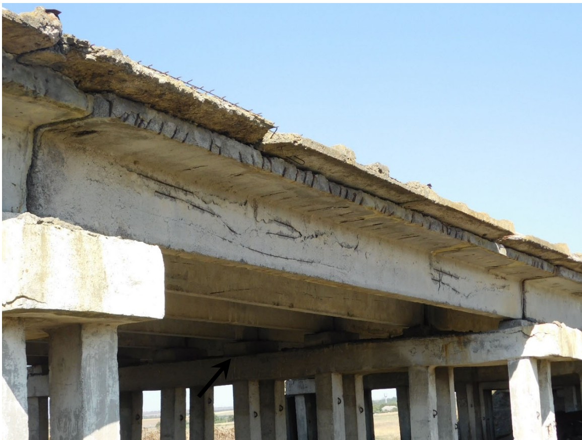
Foto 29. Deschiderea 3-4. Gr. 1. Exfolierea betonului. Armături fără strat de acoperire. Degradarea betonului plăcilor de trotuar în consolă.
