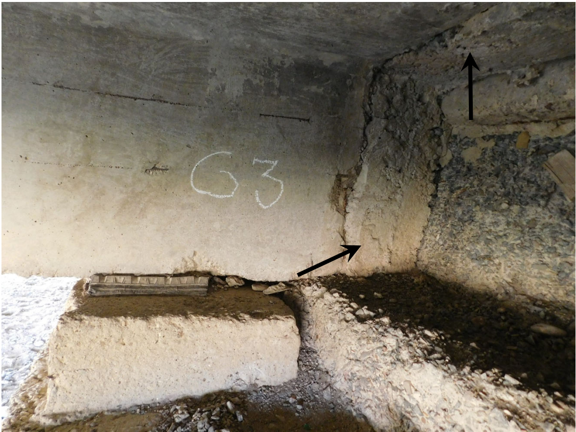
Foto 39. Culeea 1. Grinda 3. Deschiderea 1-2. Alungirea incorectă a nervurii și plăcii grinzii.
