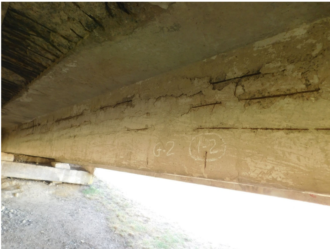
Foto 27. Deschiderea 1-2. Gr. 2. Exfolierea betonului. Armaturi fără strat de acoperire.
