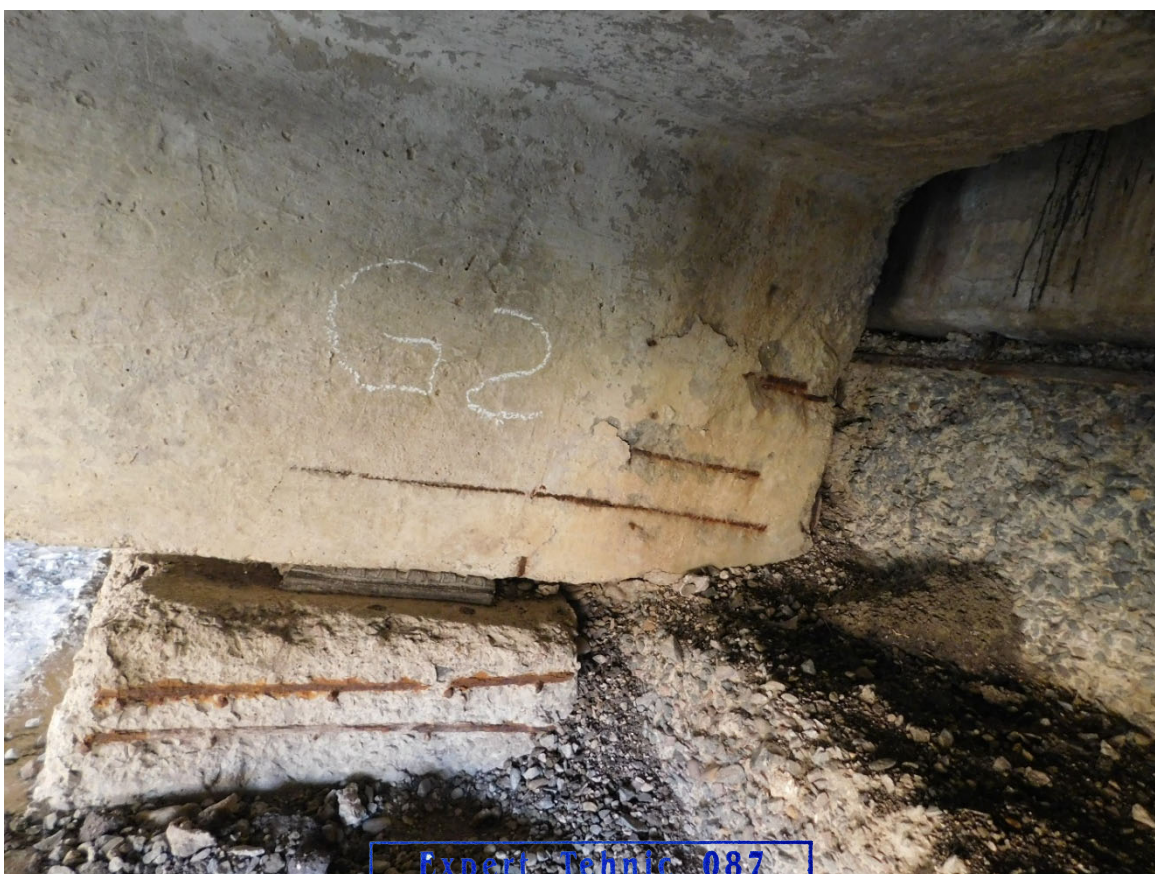
Foto 38. Culeea 1. Degradarea cuzinetului. Exfolierea betonului și coroziunea avansată armaturii grinzii în zona de rezemare. Degradarea betonului zidului de gardă.
