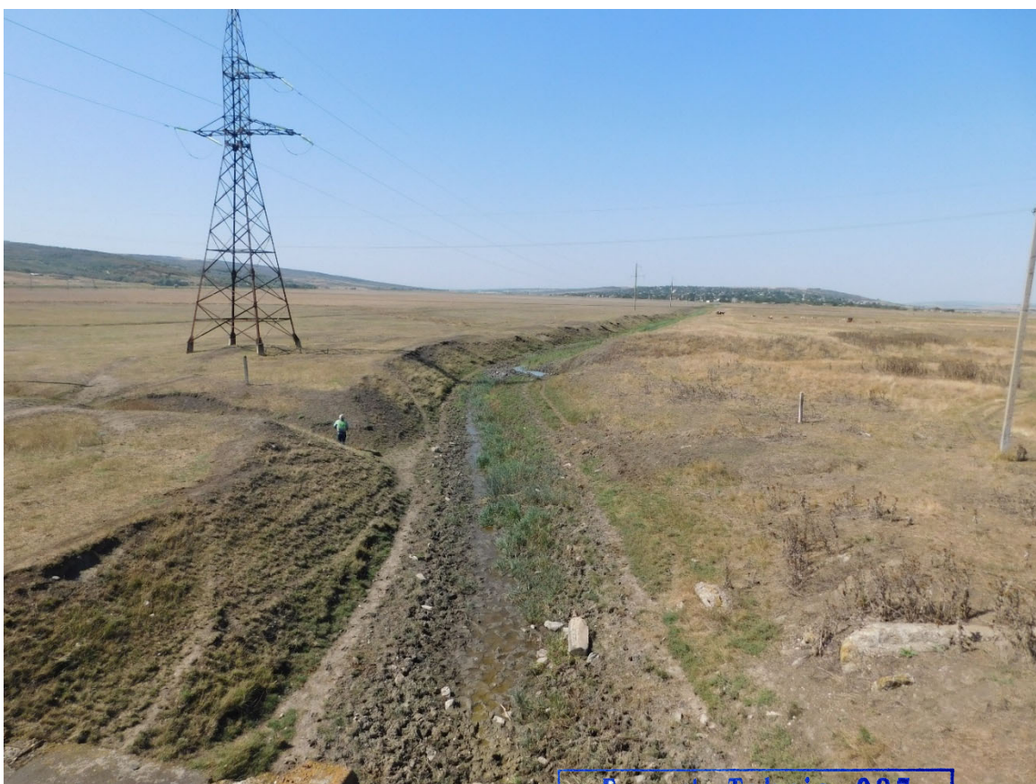
Foto 64. Albia râului Ciulucul Mic în amonte de pod. Prezența obstacolelor (bolovani din beton ciclopian).
