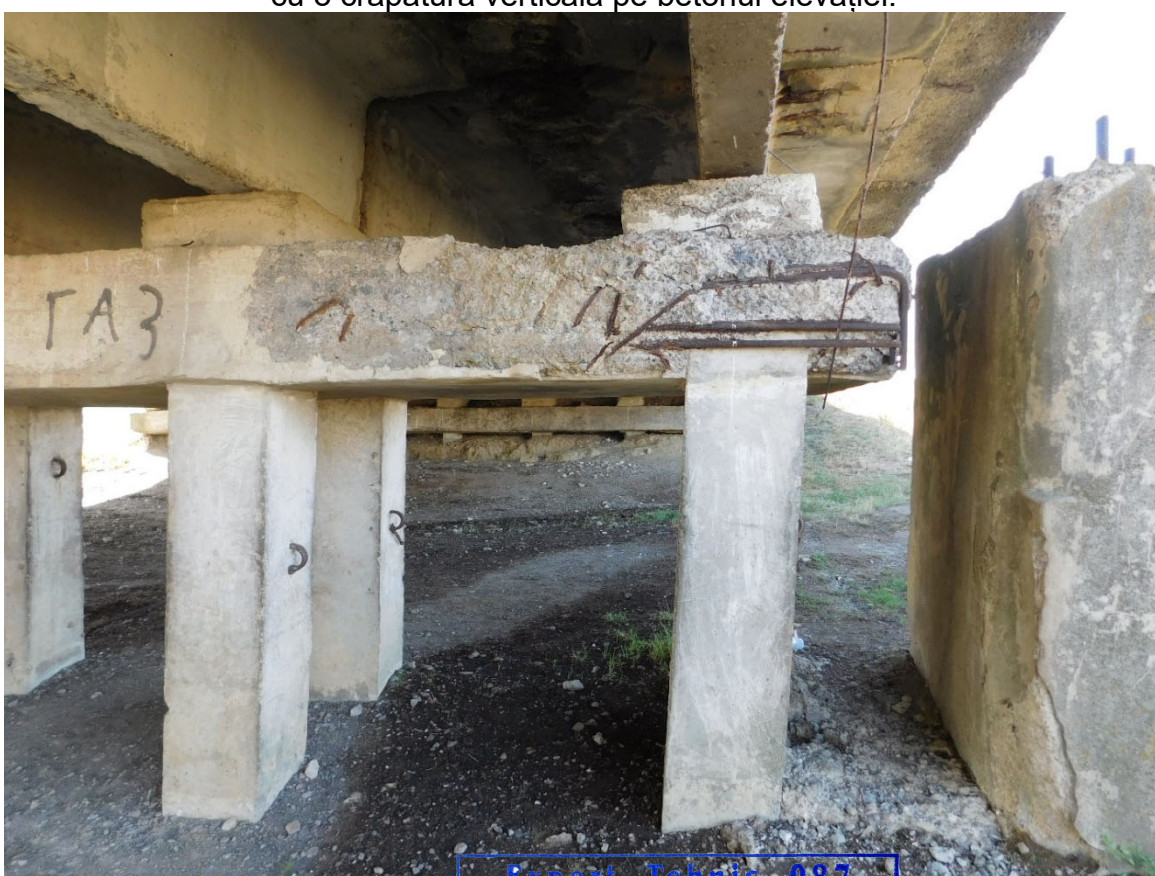
Foto 54. Pila 2. Rigla. Armături fără strat de acoperire. Coroziunea armaturii. Degradarea betonului cu reducerea secțiunii. Agregate la suprafață. Sparghețul în amonte de pila 2, cu o crăpătură verticală pe betonul elevației.
