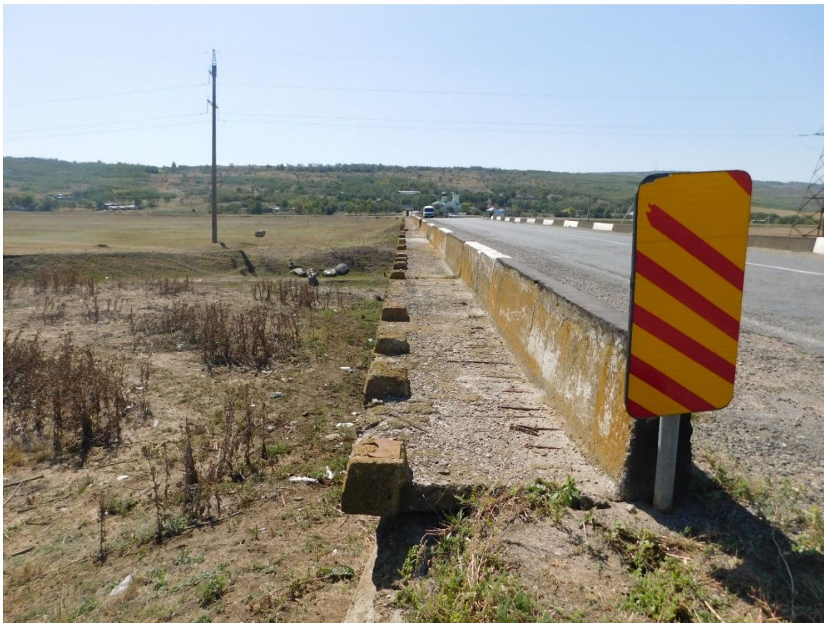
Foto 13. Trotuarul drept. Acces dificil pe trotuar. Lipsa parapetului pietonal. Beton friabil a plăcii de trotuar. Lipsa parapetului pietonal.
