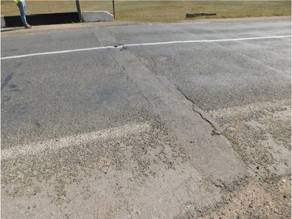
Foto 7. Calea podului. Rostul 1. Crăpături, tasări și gropi în îmbrăcămintea asfaltică.
