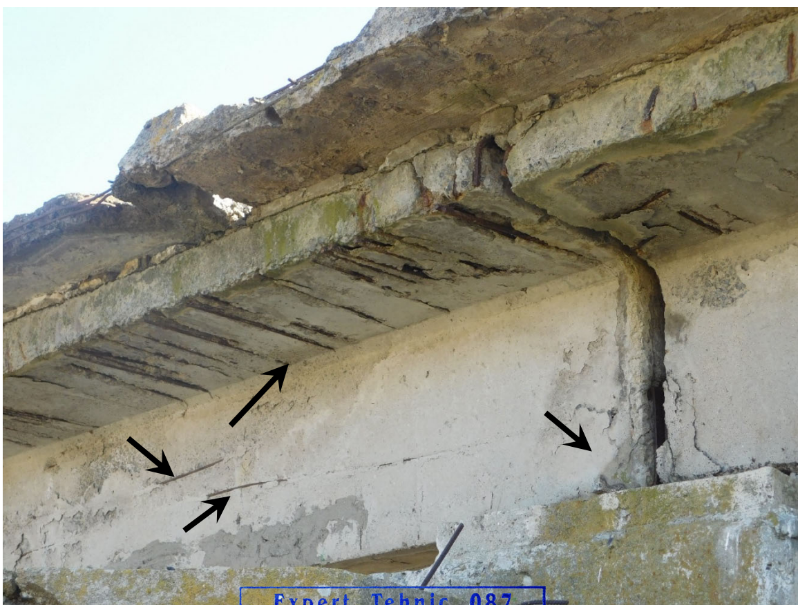
Foto 34. Deschiderea 3-4. Pila 3. Exfolierea betonului și coroziunea avansată a armaturii grinzilor în zona de rezemare și la intrarea plăcii în consolă.
