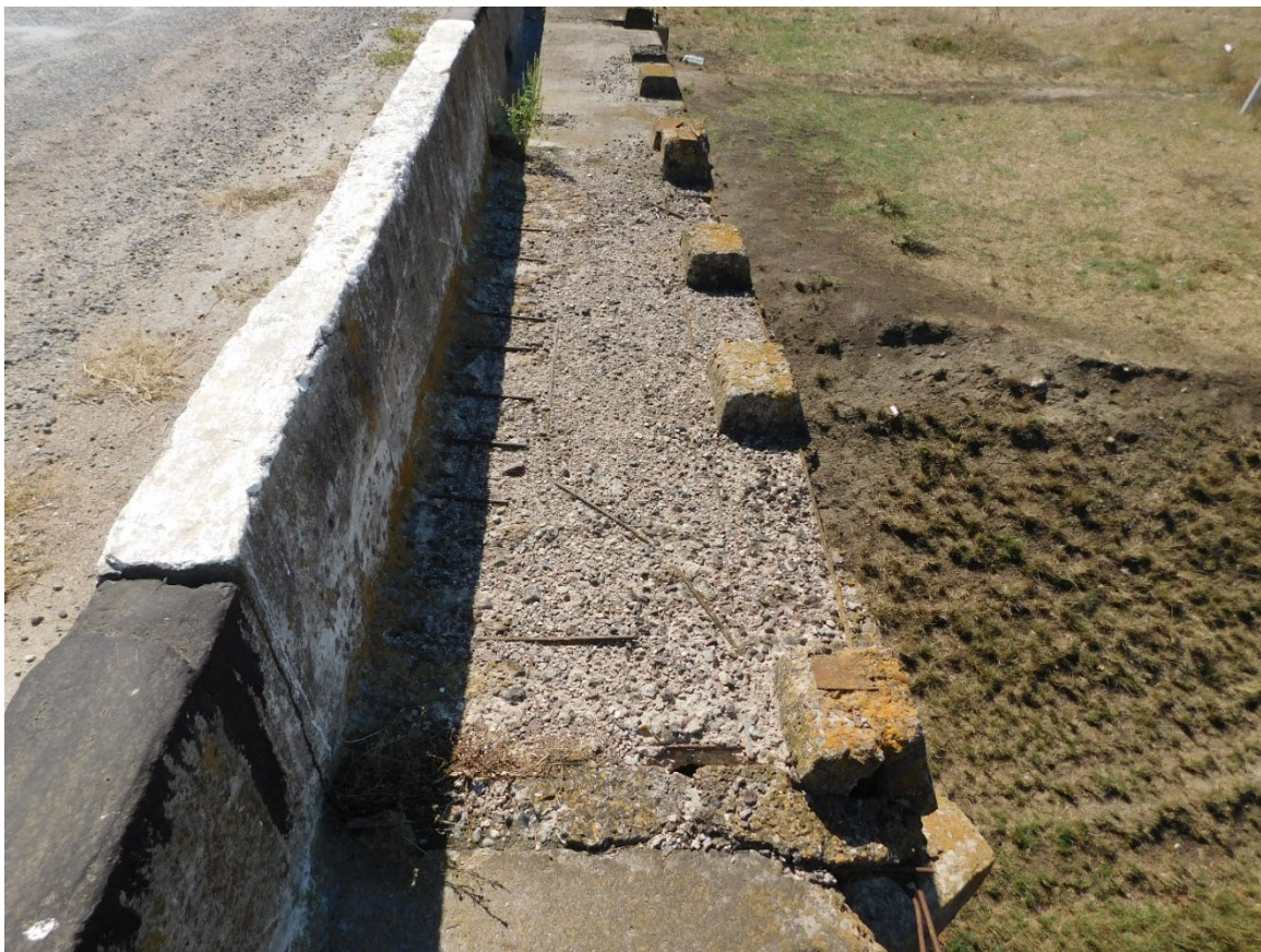
Foto 9. Trotuarul drept. Armături fără strat de acoperire. Degradarea betonului plăcii de trotuar. Beton friabil a plăcii de trotuar. Lipsa parapetului pietonal.
