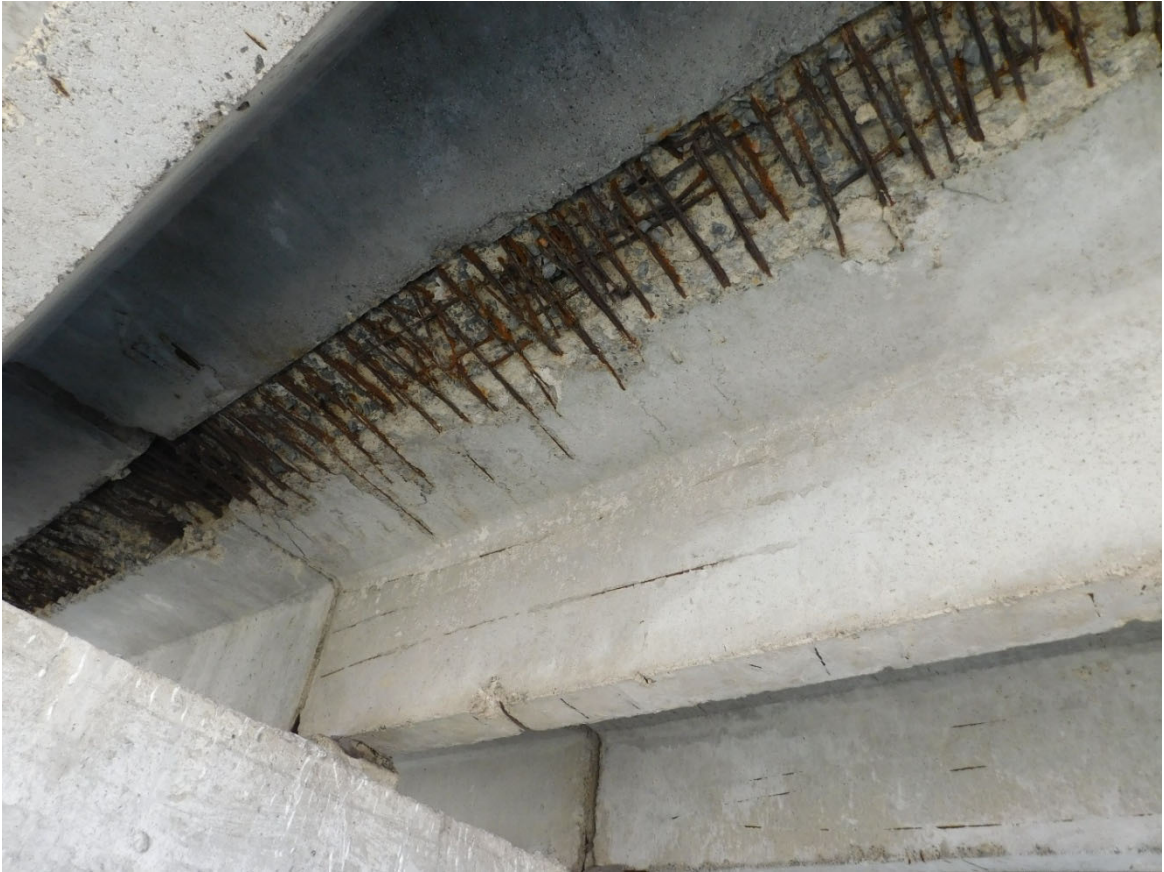
Foto 25. Deschiderea 6-7. Nodul de îmbinare a plăcilor dintre grinzi. Coroziunea avansată a betonului și a armaturii, cu modificarea secțiunii plăcii și armaturii.
