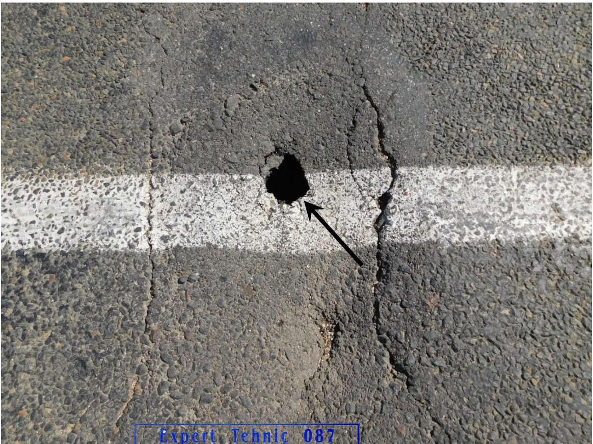
Foto 8. Calea podului. Rostul 1. Tasări și gropi în îmbrăcămintea asfaltică.
