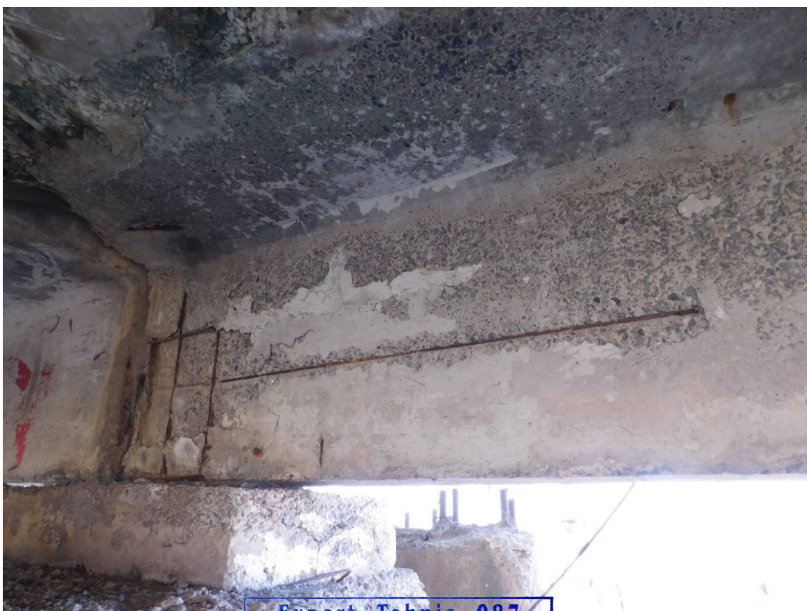
Foto 28. Deschiderea 2-3. Gr. 1. Exfolierea betonului. Armaturi fără strat de acoperire. Cuzinetul. Exfolierea betonului. Crăpături.
