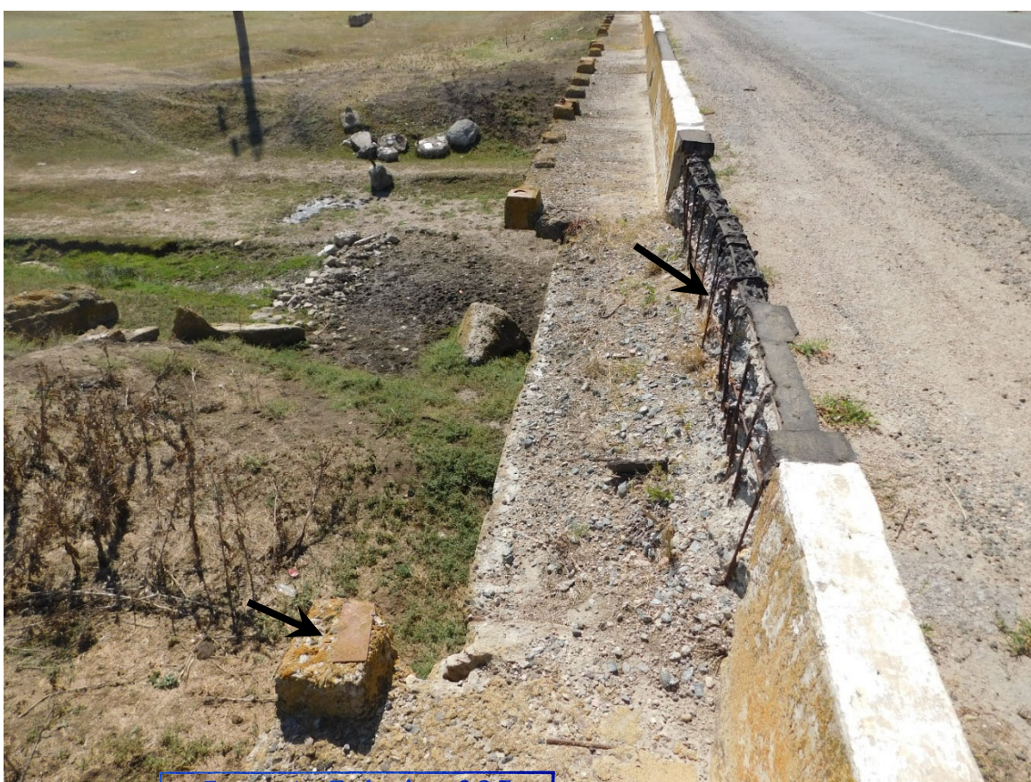
Foto 10. Trotuarul drept. Armături fără strat de acoperire. Degradarea betonului plăcii de trotuar și a parapetului de siguranță. Beton friabil a plăcii de trotuar. Lipsa parapetului pietonal.
