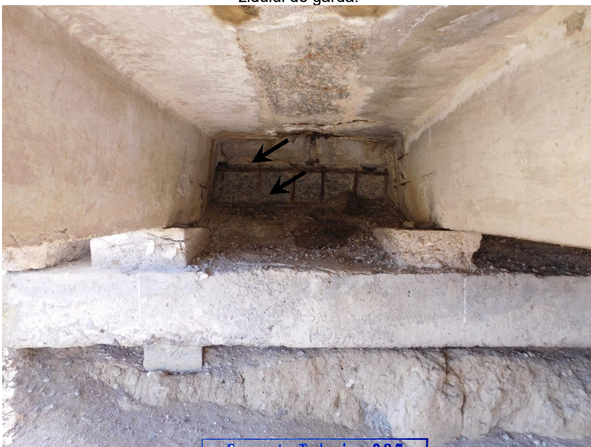
Foto 50. Culeea 1. Crăpături în cuzineți. Degradarea betonului și coroziunea armaturii zidului de gardă.
