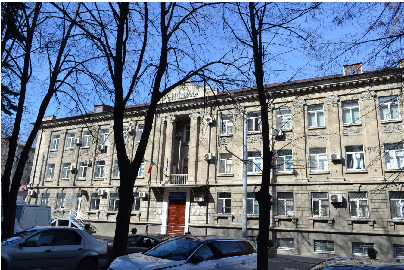
Foto 1-11. Starea tehnică a fațadelor, cornișelor clădirii.
