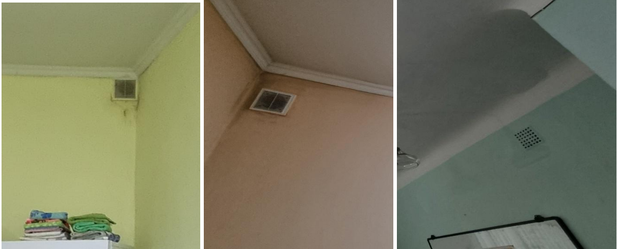
Figura 22. Vedere a sistemului de ventilare
