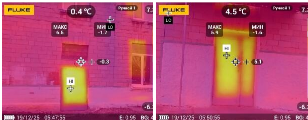
Figură 17. Termograma tâmplăriei
