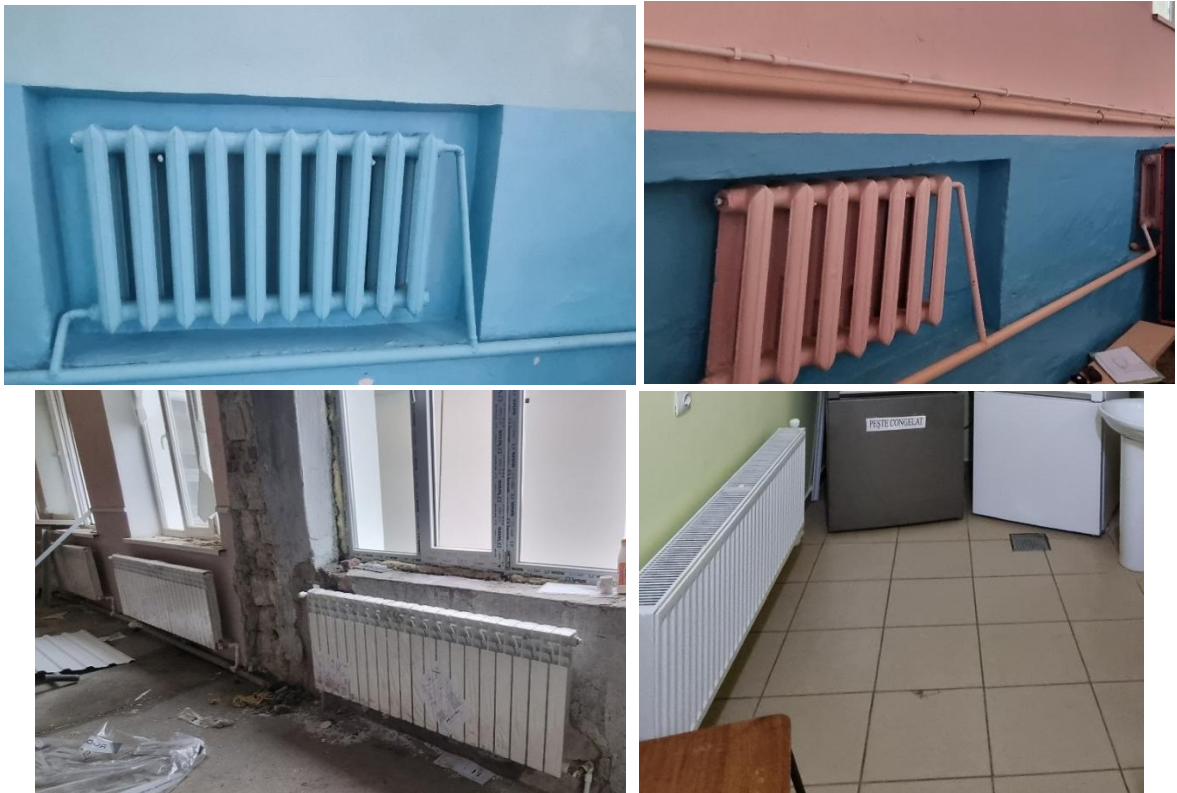
Figura 20. Vedere a sistemului de distribuție a energiei termice pe interior
