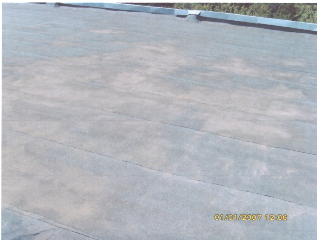
c: Anexa 6: Deformații/inconveniențe alcătuire/execuție acoperiș.
