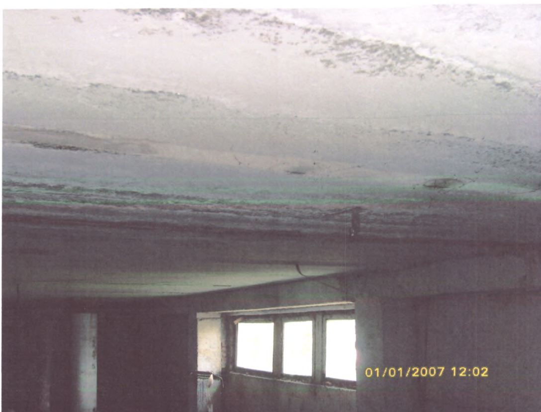
c: Anexa 5: Structură planșeu acoperiș - Construcția de sănătate, asistență socială cu nr. cadastral 00300209.961.01 (lit. B) din complexul IMSP CENTRUL MEDICILOR DE FAMILIE MUNICIPAL BĂLȚI de pe str. Decebal, 101/V, mun. Bălți.
