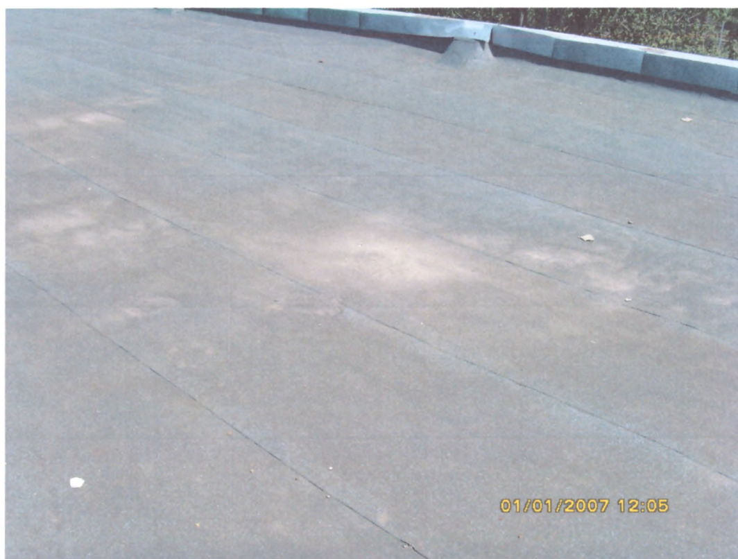
a: Anexa 6:Deformații/inconveniențe alcătuire/execuție acoperiș.
