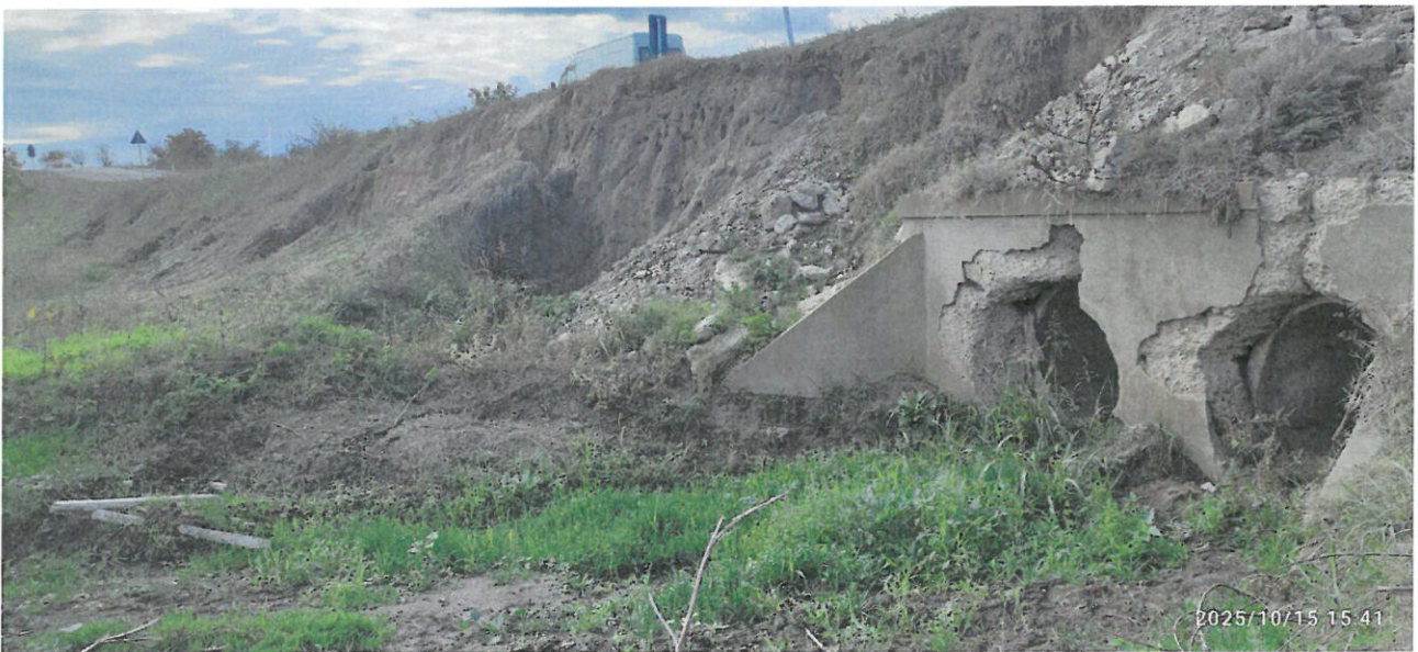
Capătul aval cu erodarea taluzului
