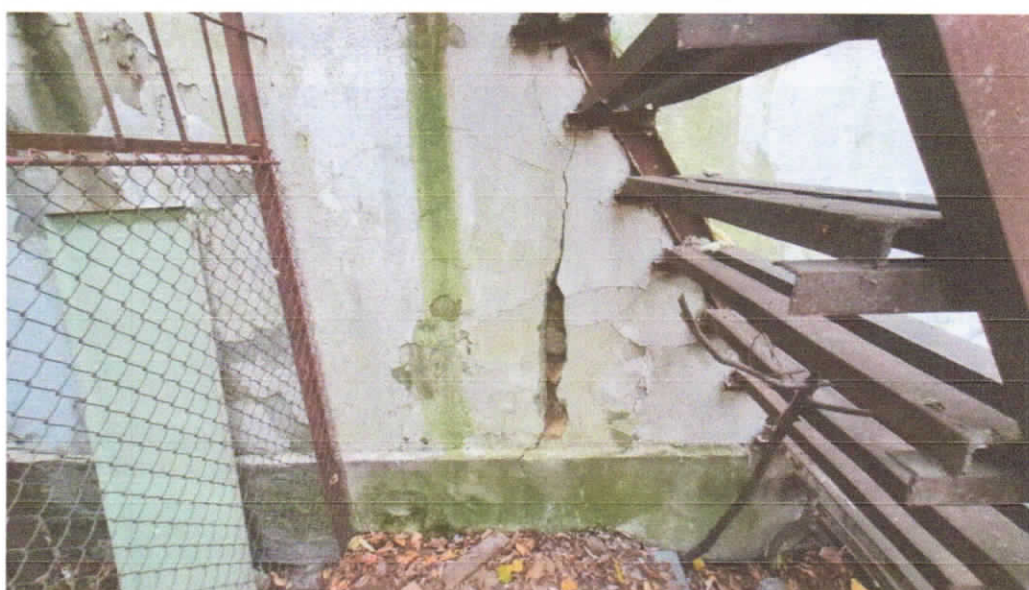
Foto nr. 156; 157. Starea tehnică a scării anexei clădirii.
