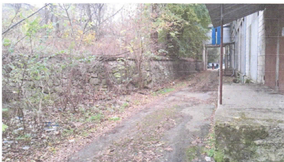
Foto nr. 32; 33; 34. Pereul din asfalt-beton deteriorat (fisurat). Scurgerea apelor pluviale de pe acoperiș prin burlanele de evacuare în imediata apropiere a pereților de soclu.
