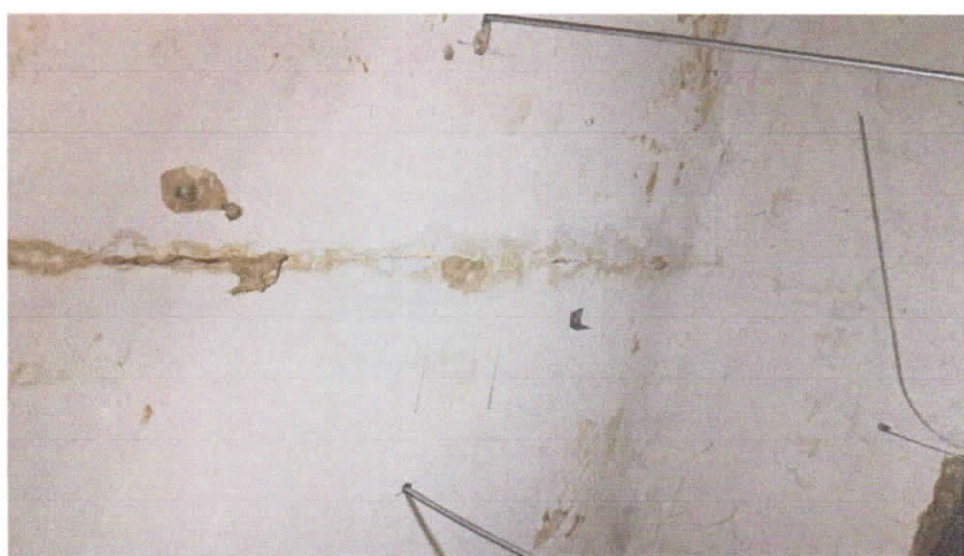
Foto nr. 78; 79; 80. Starea tehnică a elementelor structurale ale acoperișului. Deteriorări ale tencuielii planșeului în urma spargerii straturilor acoperișului și panourilor de planșeu, și pătrunderii apelor meteorice.
