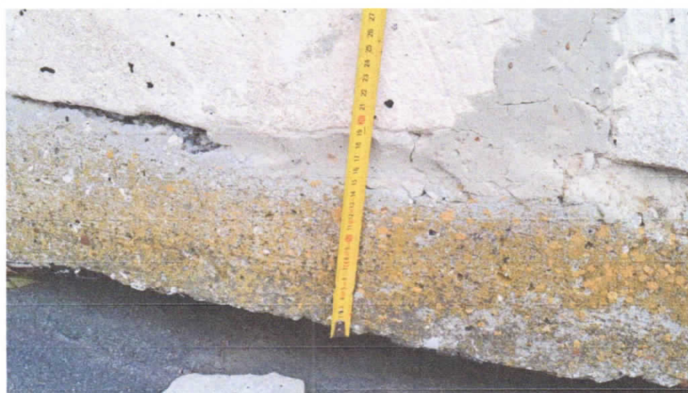
Foto nr. 133; 134; 135. Starea tehnică a parapetului acoperișului.
