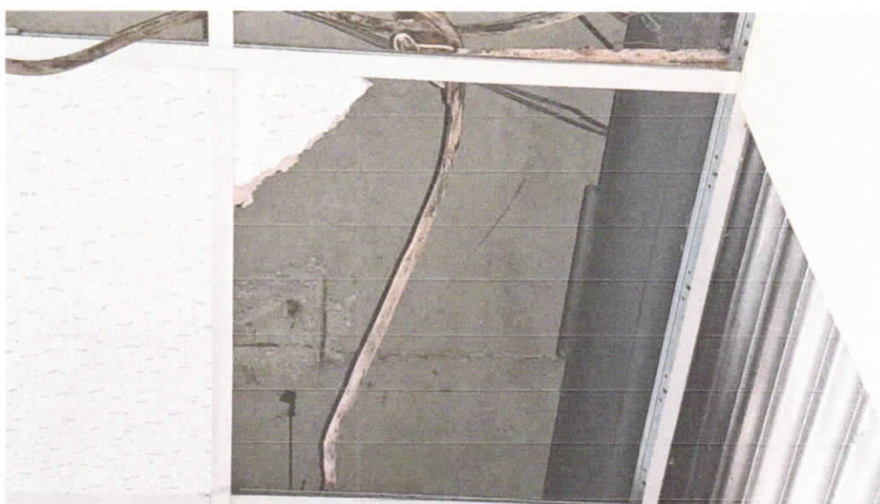
Foto nr. 105; 106; 107. Starea tehnică a elementelor structurale ale planșeului intermediar (deasupra parterului). Deteriorări ale betonului și armăturii grinzilor și planșeului.
