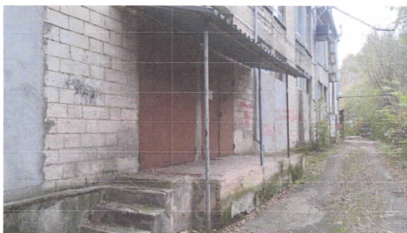
Foto nr. 4; 5; 6. Intrările de serviciu la parter amplasate în partea de Nord-Est a clădirii. Deteriorări și degradări ale pragurilor de intrare, elementelor de oțel ale scărilor și copertinelor, învelitorii copertinelor.
