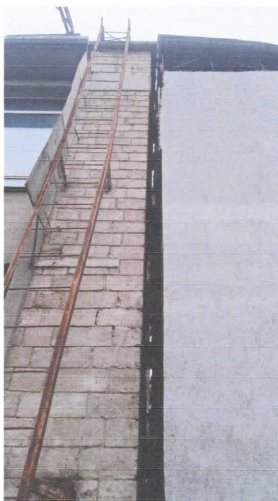
Foto nr. 151; 152. Starea tehnică a anexei clădirii (vederi generale).
