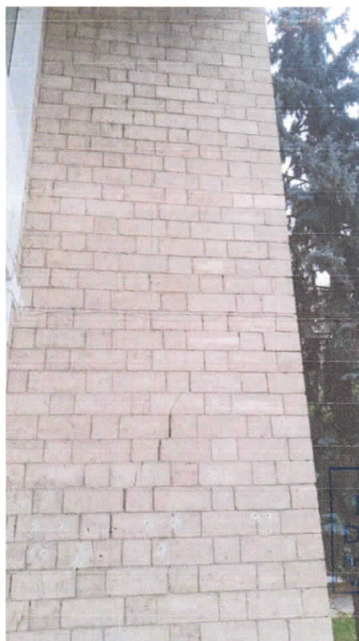
Foto nr. 23; 24. Fisură oblică pe suprafața exterioră a peretelui structural transversal.
