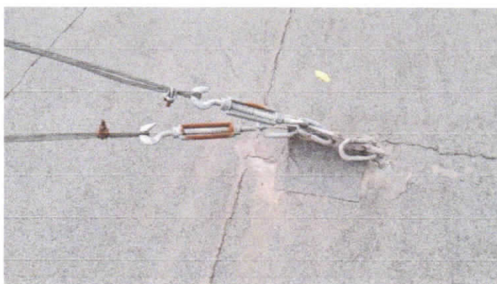
Foto nr. 116; 117; 118. Starea tehnică a acoperișului.
