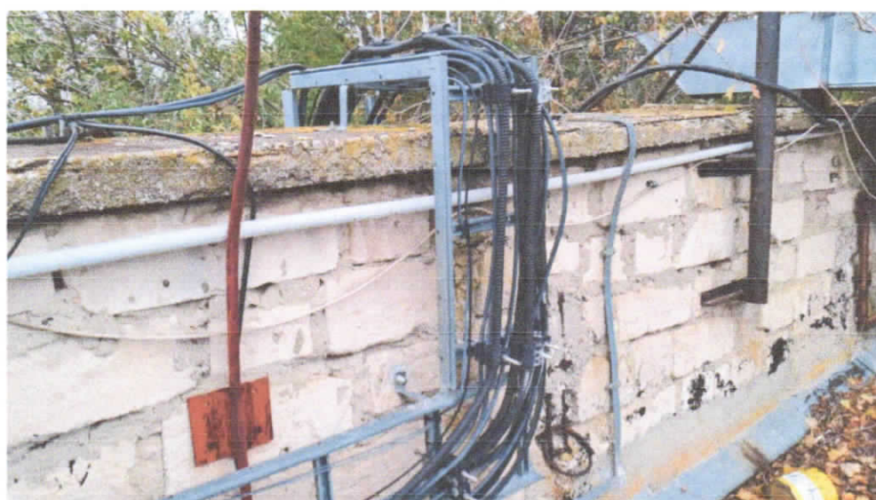
Foto nr. 122; 123; 124. Starea tehnică a acoperișului.
