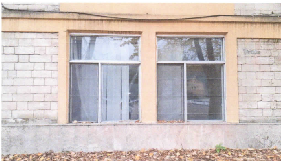
Foto nr. 111; 112. Deteriorări ale finisajelor interioare la parter, căderi de tencuială cauzate de umezirea pereților favorizată de elementul de cornișă.
