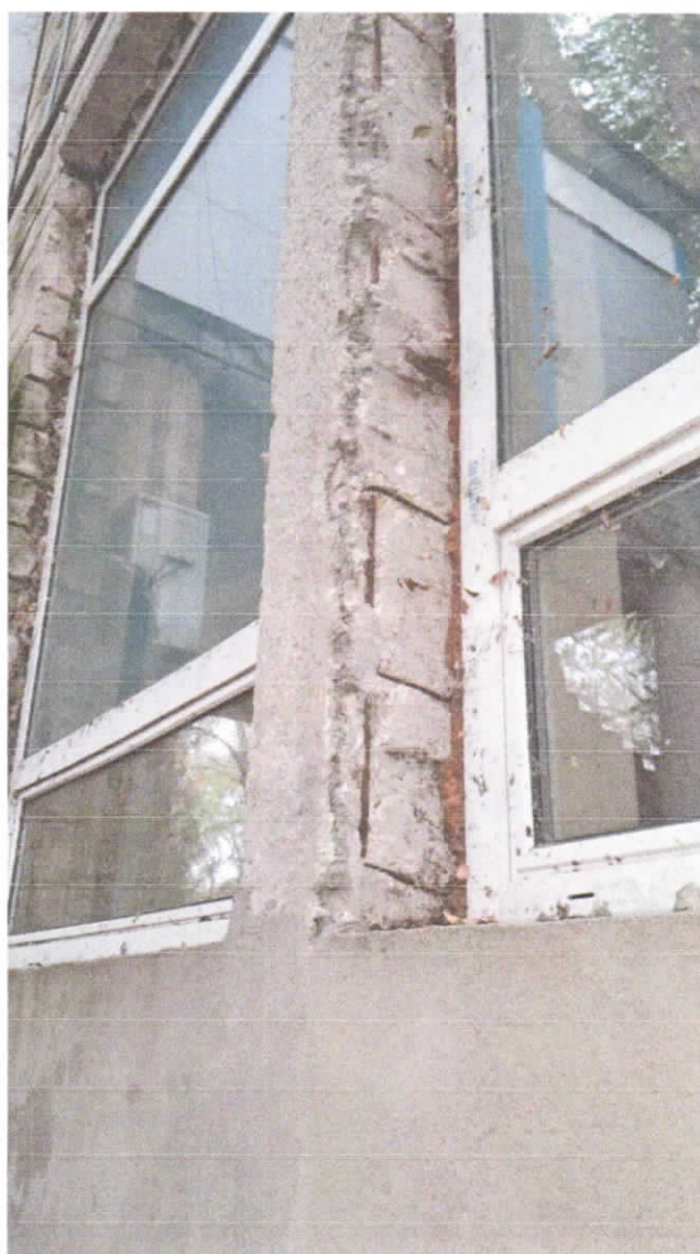
Foto nr. 44; 45. Degradări ale stratului de protecție și deteriorări prin dezgolirea armăturii porțiunilor pereților intergol executate din beton armat monolit.
