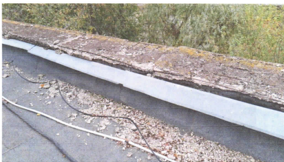
Foto nr. 145; 146; 147. Starea tehnică a parapetului acoperișului.
