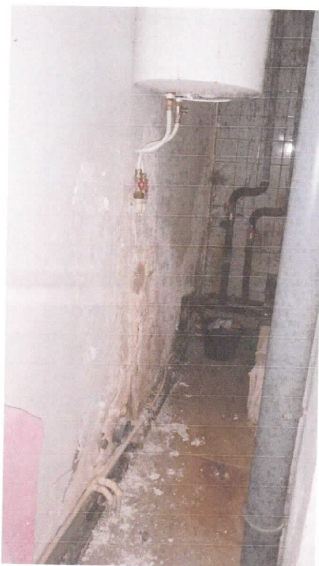
Foto nr. 28; 29. Distrugerea finisajului și stratificarea tencuielii în lipsa hidroizolării pereților de la demisol de la infiltrarea apelor pluviale și de la scurgeri ale rețelilor ingineresti din interiorul demisolului.
