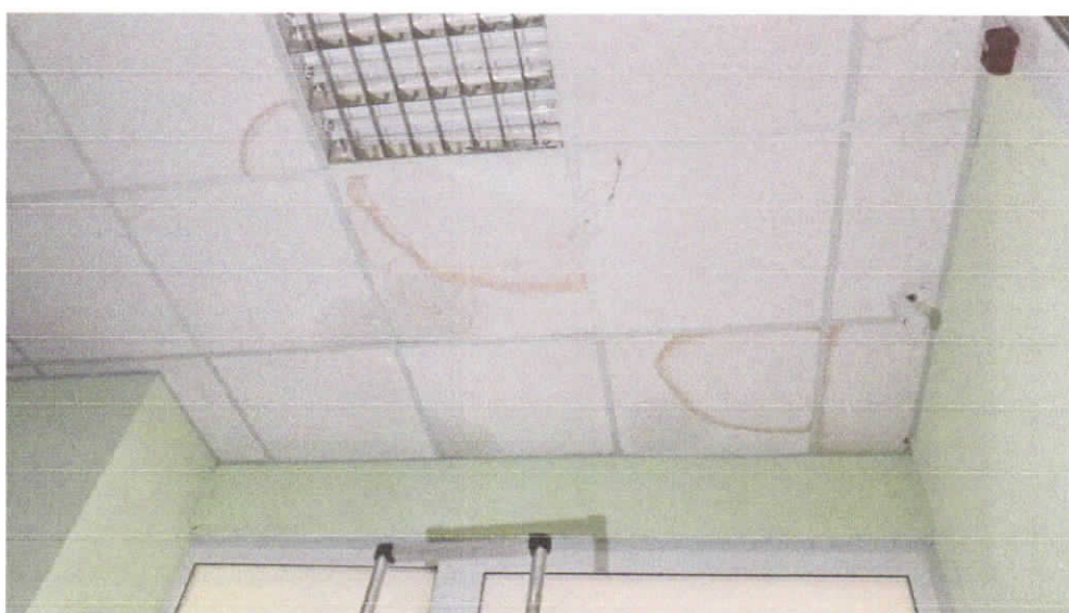
Foto nr. 72; 73; 74. Urme de umezeală pe suprafața tavanului suspendat din cauza pătrunderii apelor meteorice prin acoperișul deteriorat.
