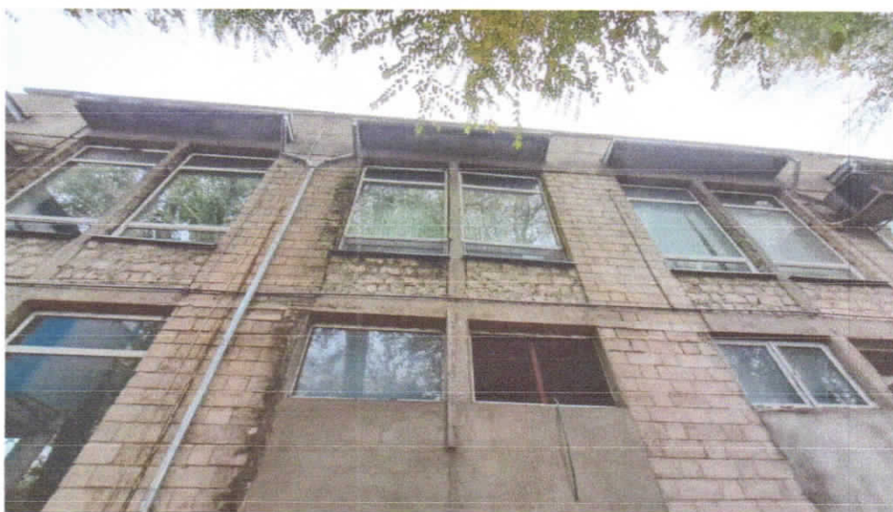
Foto nr. 48; 49; 50. Degradări ale stratului de protecție și deteriorări prin dezgolirea armăturii porțiunilor pereților intergol executate din beton armat monolit.
