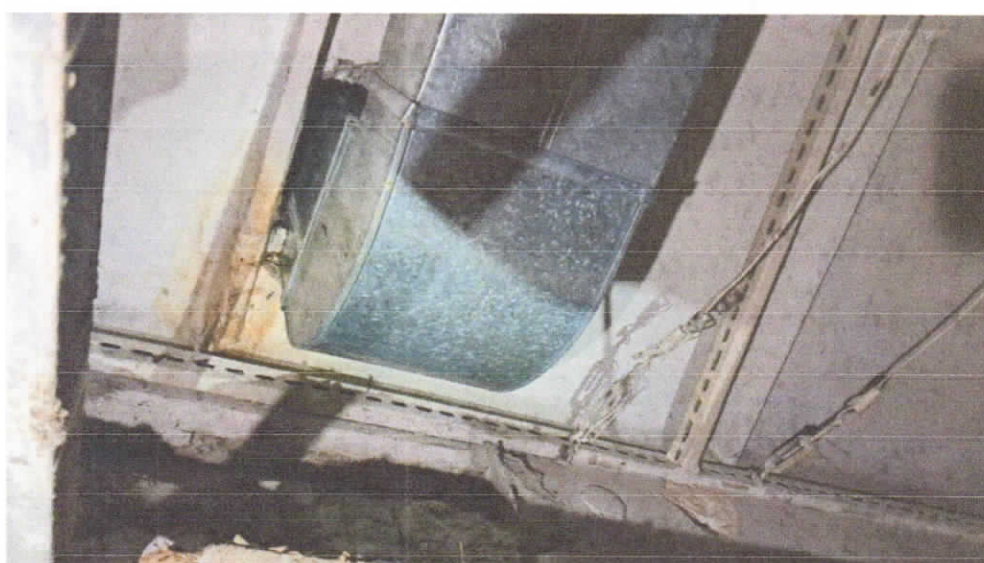
Foto nr. 60; 61; 62. Vederi generale în interiorul etajului clădirii. Scurgeri de apă prin golurile tubulaturii de ventilare din planșeul de acoperiș.
