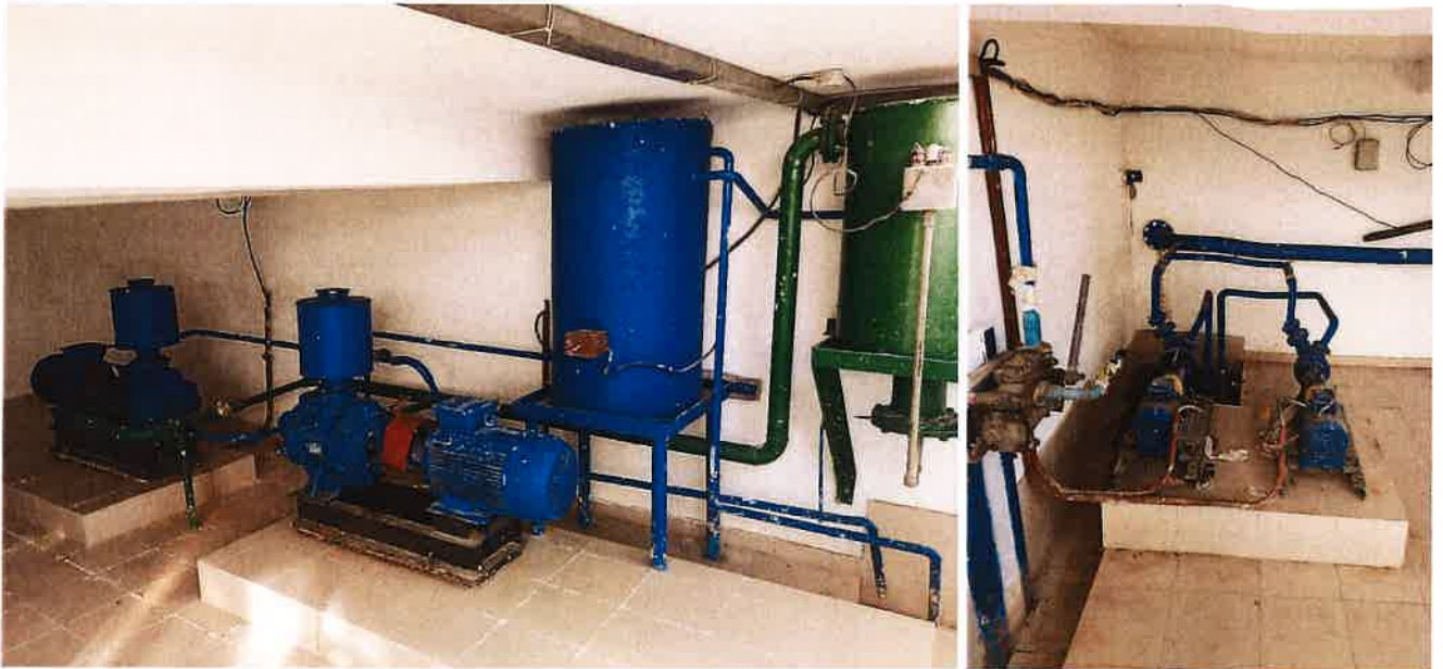
Figura 3.5. Sistem de vacuum (stânga) și sistem de pompare apă drenaj (dreapta) (SP-5)
