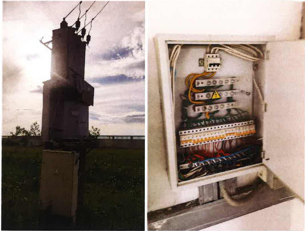
Figura 3.19. Transformatorul și panoul de distribuție principal (SP-2)
