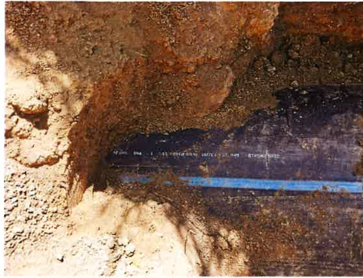
Figura 3.10. Conductă în stare bună pe traseul SP-5 până la SP-2
