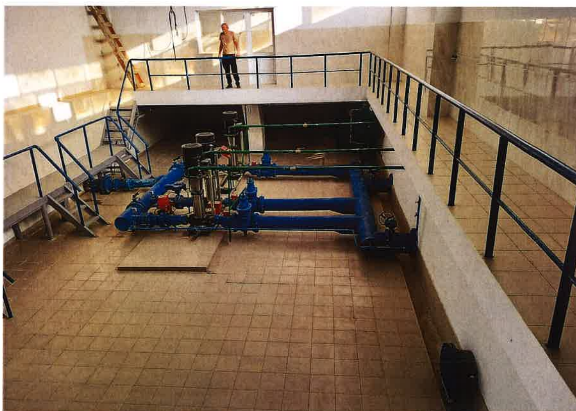
Figura 2.6. Stația de pompare SP-5. Vedere din interior
