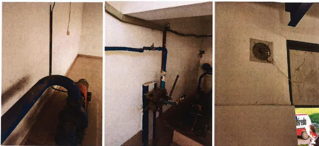
Figura 3.2. Zonă cu mucegai. Sistem de ventilare existent (SP-5)
