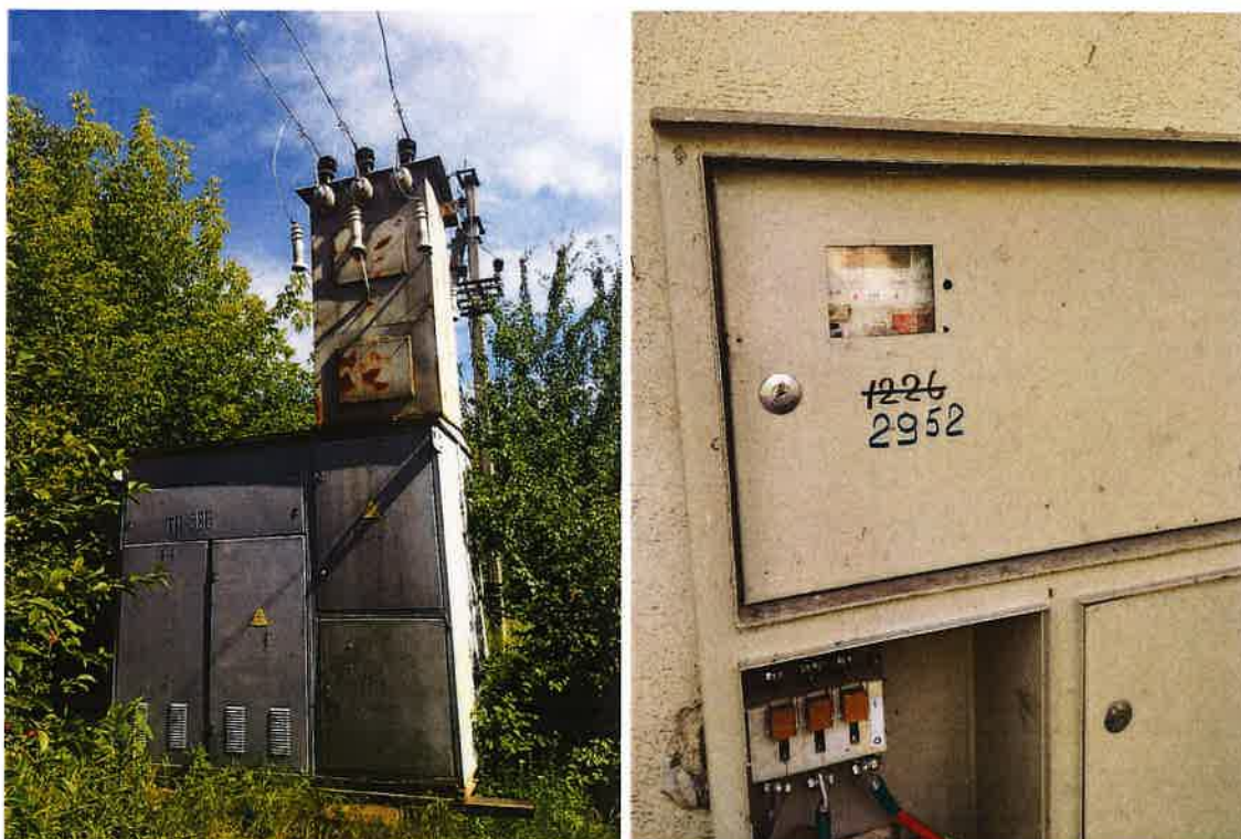
Figura 3.7. Transformatorul și panoul de distribuție principal
