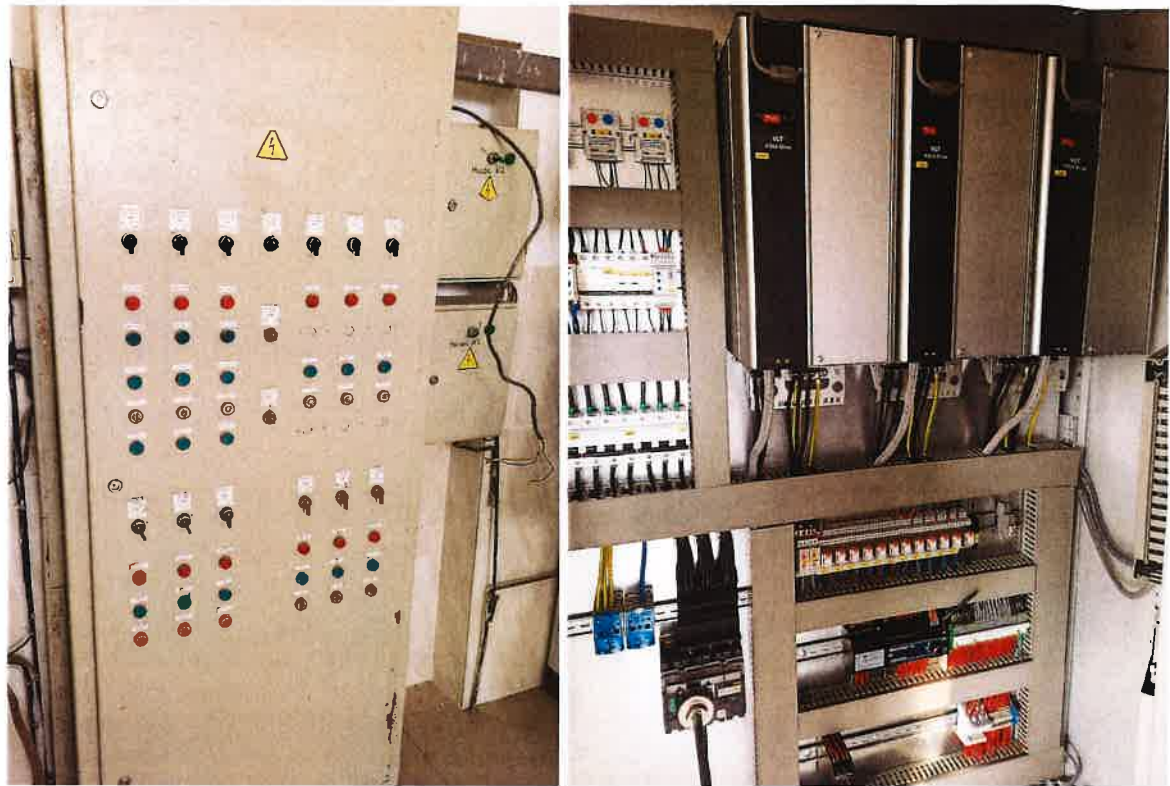
Figura 3.9. Panouri de automatizare din cadrul SP-5. Existent / vechi (stânga). Nou (dreapta)
