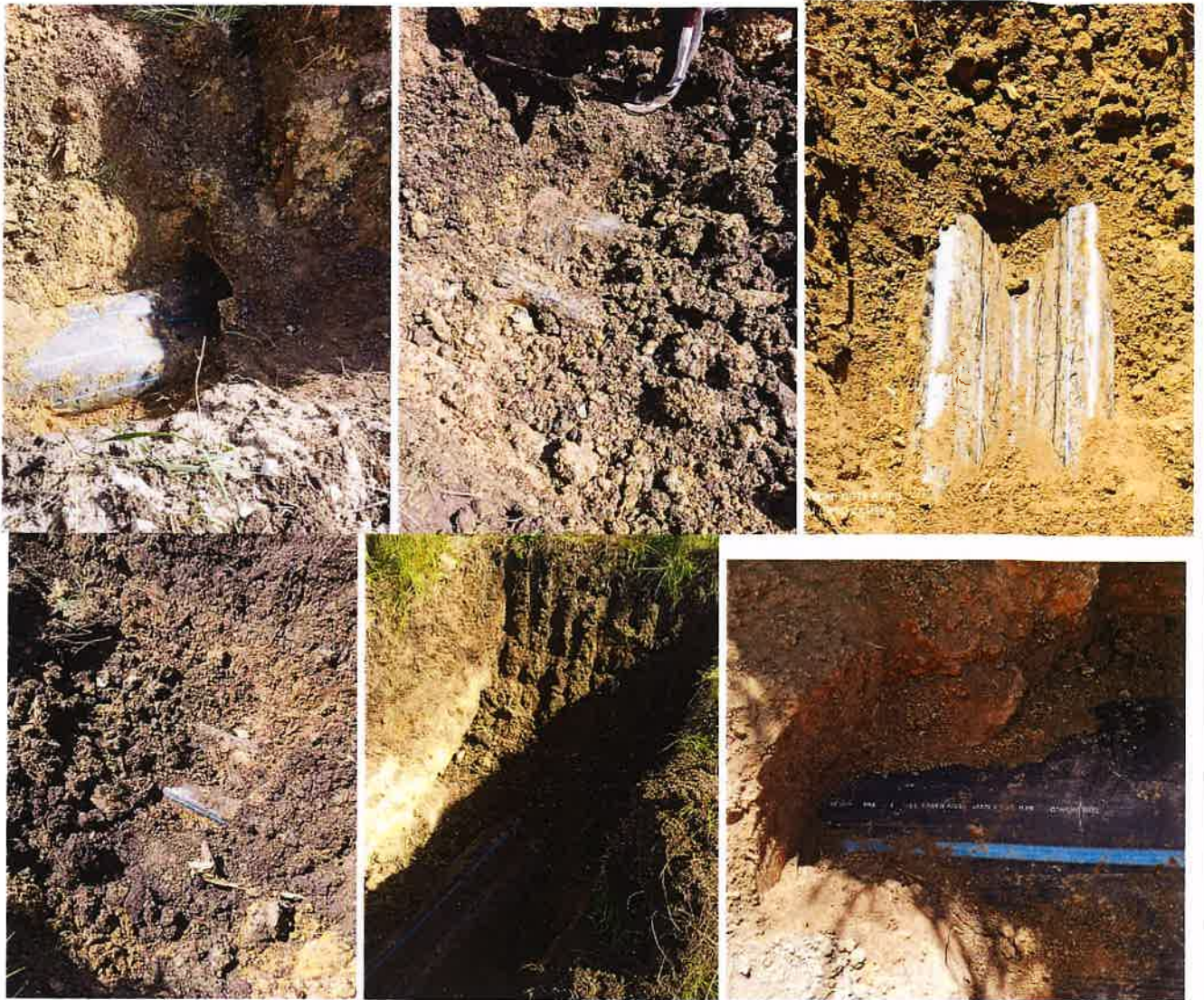
Figura 3.23. Starea conductei de apă în tranșeu (SP-2 până la stația de tratare)
