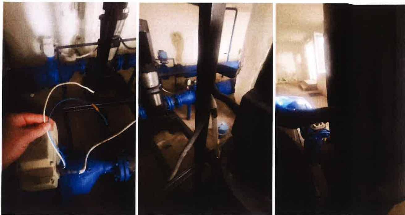
Figura 3.20. Cablaj în cadrul stației de pompare SP-2
