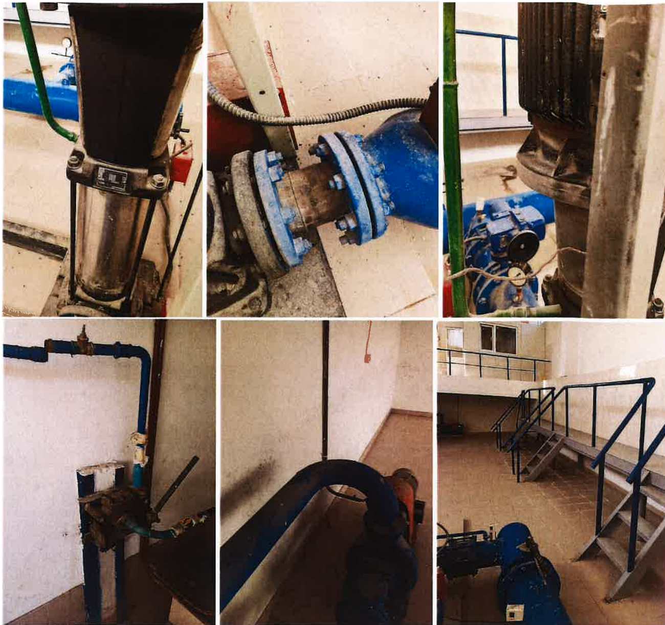
Figura 3.4. Armăturile / utilajele învechite din cadrul stației de pompare (SP-5)
