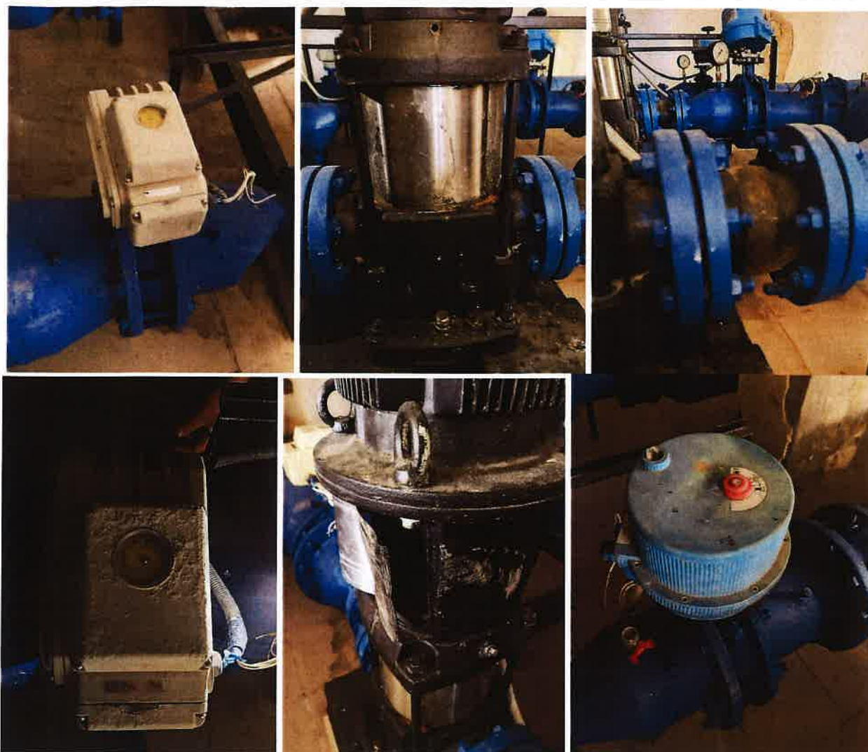
Figura 3.17. Armăturile / utilajele învechite din cadrul stației de pompare (SP-2)
