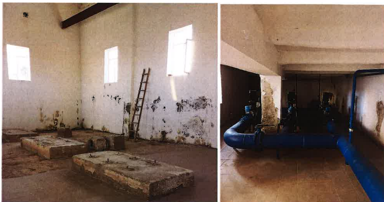
Figura 2.11. Stația de pompare SP-2. Vedere din interior
