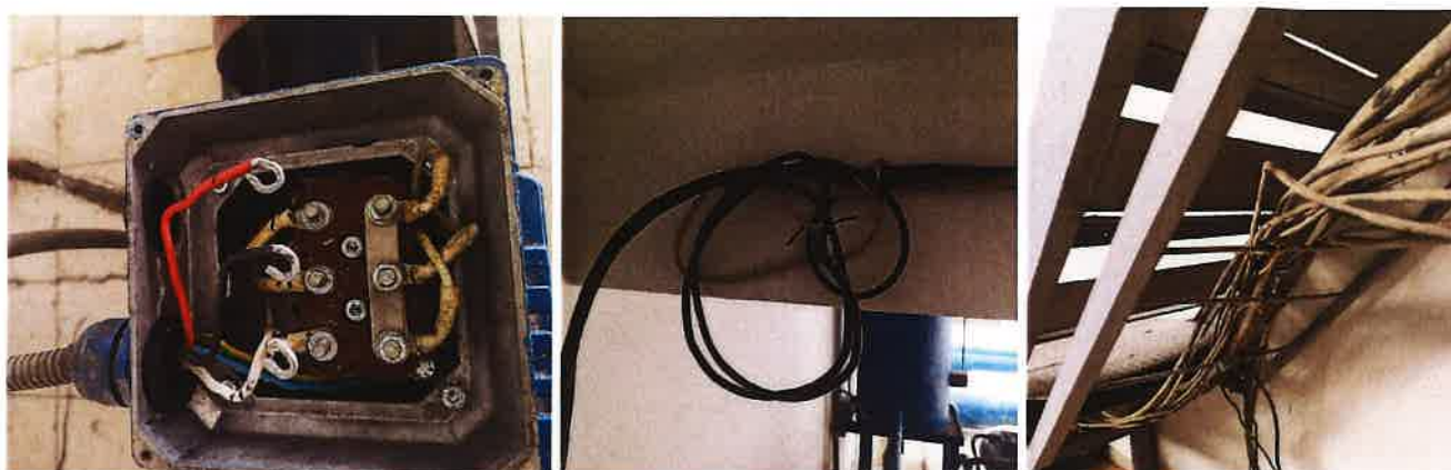
Figura 3.8. Cablaj în cadrul stației de pompare SP-5
