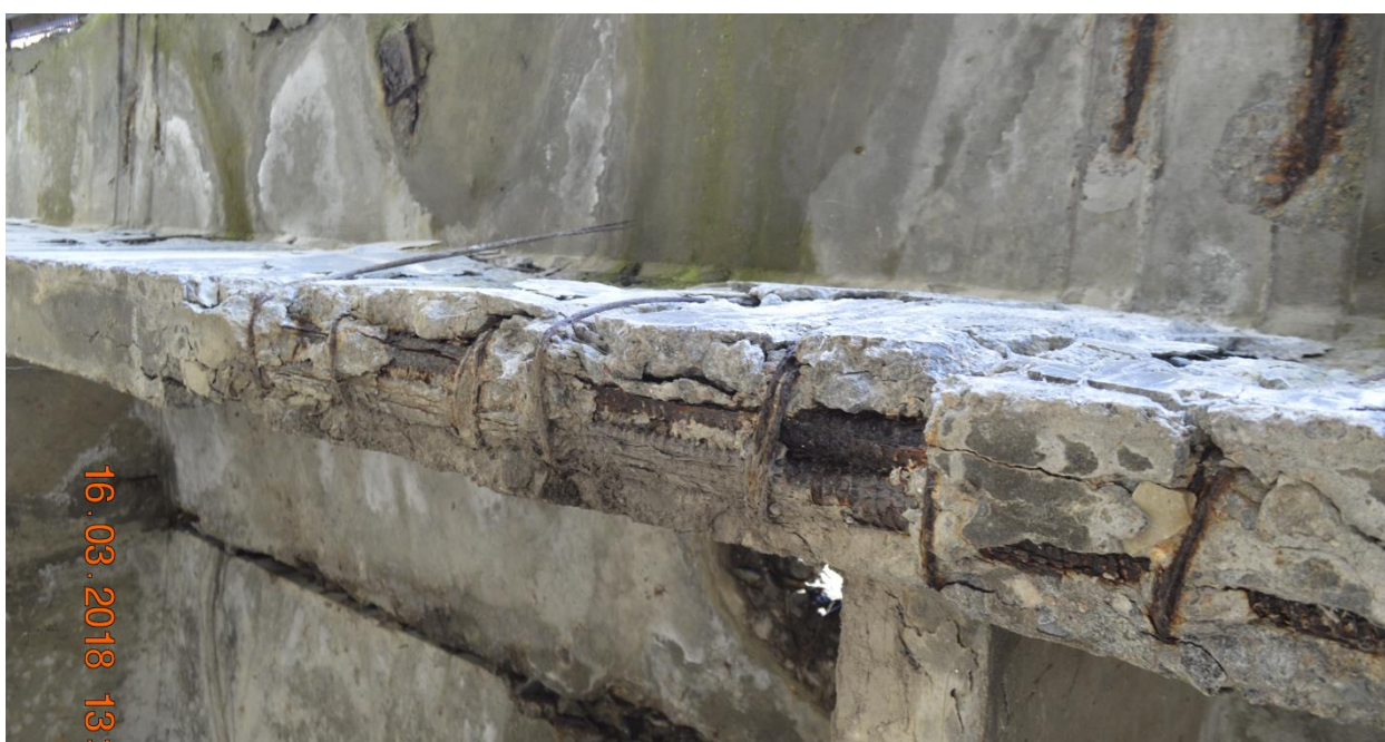
Fig. 3.5.16 Degradarea 100% a elementului suprastructurii deschiderii Nr.2. Grinda nr.10. Corodarea armăturii de lucru cu 35-40%. Degradarea 100% a stratului de protecție și armăturii constructive. Degradarea 100% a gurilor de scurgere a apelor de pe carosabilul de pod.
