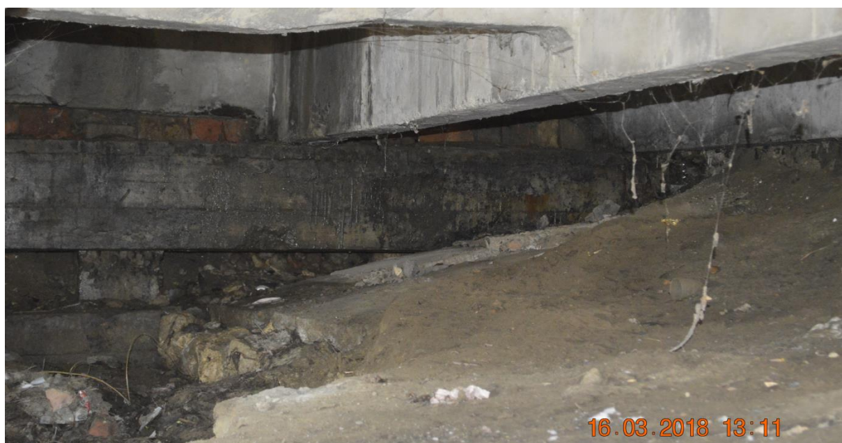
Fig.3.4.1.2 Starea tehnică a zonei de reazem a construcției de pod.
