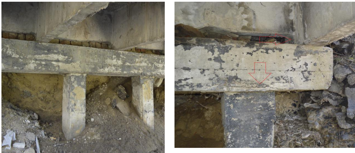
Fig.3.4.2.3. Starea tehnică culee C2. Degradare afuieră terasamentului din spatele culeei.
