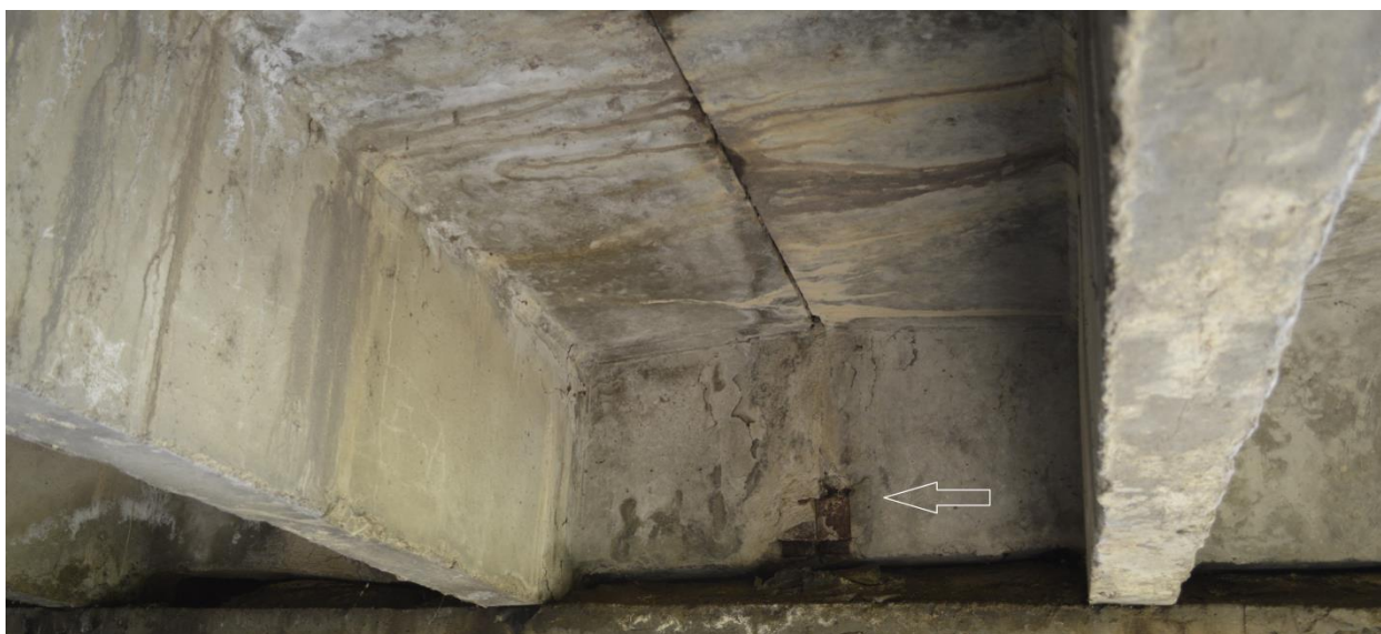
Fig.3.5.4 Degradarea și corodarea rosturilor de îmbinare a grinzilor. Corozia îmbinărilor sudate. Pete de săruri și de culoare cafenie, datorate lipsei hidroizolației și coroziei elementelor armate a plăcii suprastructurii.
