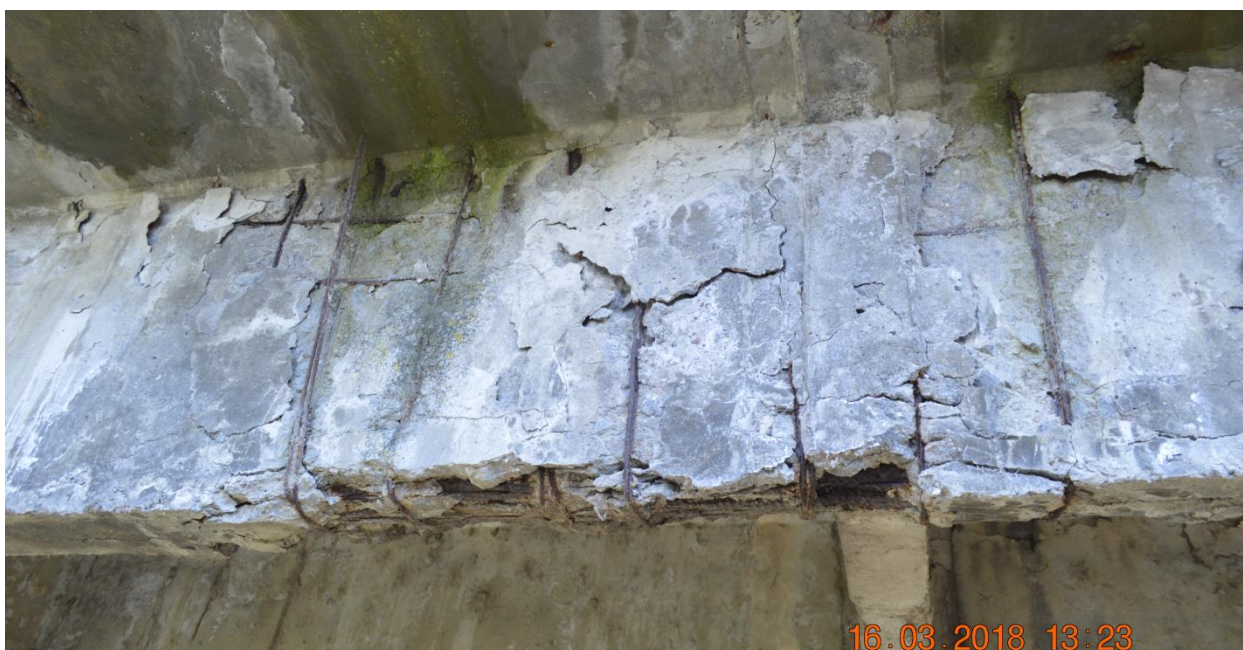
Fig. 3.5.15 Degradarea 100% a elementului suprastructurii deschiderii Nr.2. Grinda nr.10. Corodarea armăturii de lucru cu 35-40%. Degradarea 100% a stratului de protecție și armăturii constructive.
