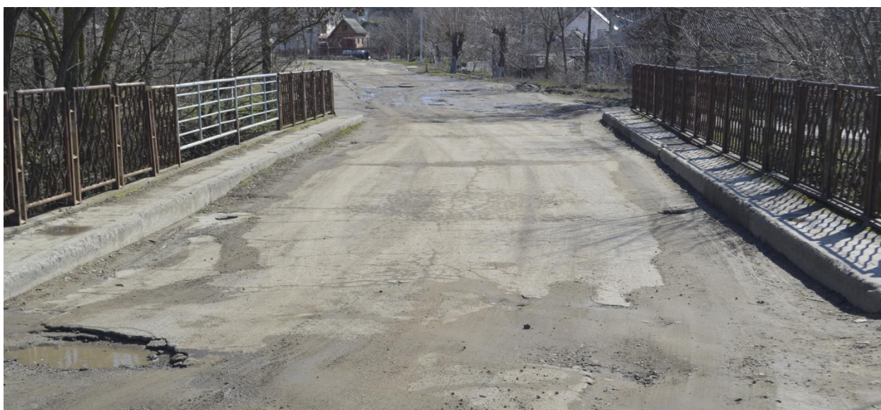
Fig. 3.6.3 Situația existentă a carosabilului de pe pod.
