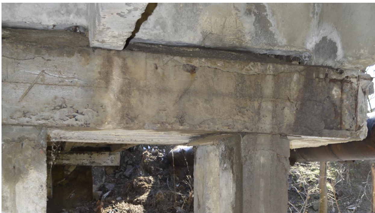
Fig.3.4.3.3 Pila P1. Degradarea capelor de pilă. Fisuri. Dislocări și aschieri a stratului de protecție. Corodarea armăturii. Înoroirea zonei de cuzenet.
