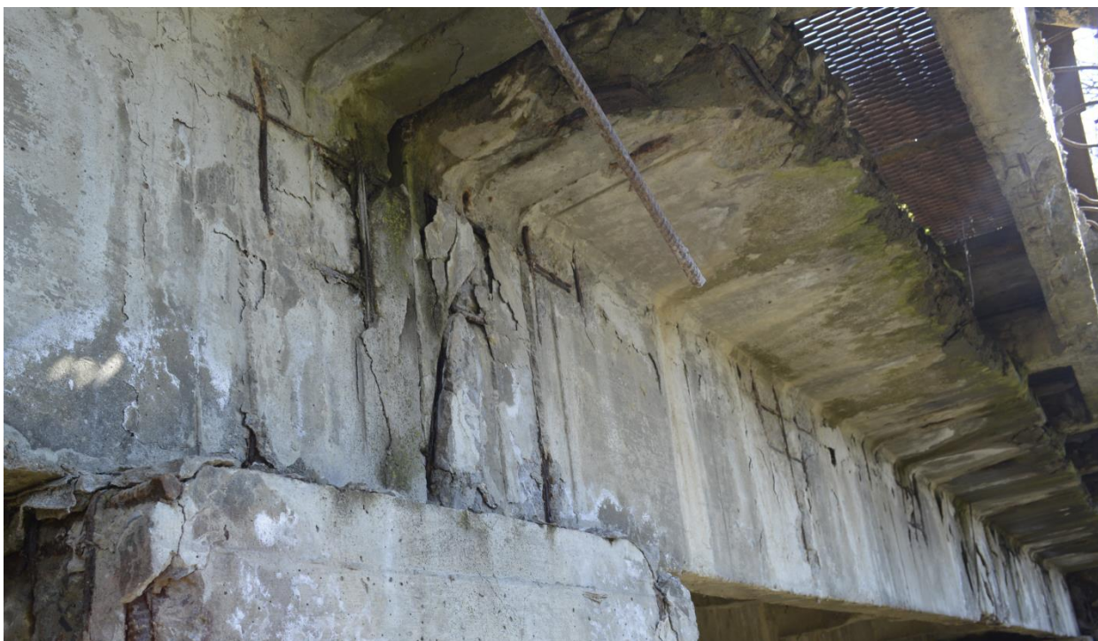
Fig.3.5.3 Degradarea grinzii marginale deschiderea Nr.2 Grinda 10. Degradarea grinzilor Nr.5 și Nr.10 în zona de reazem.
