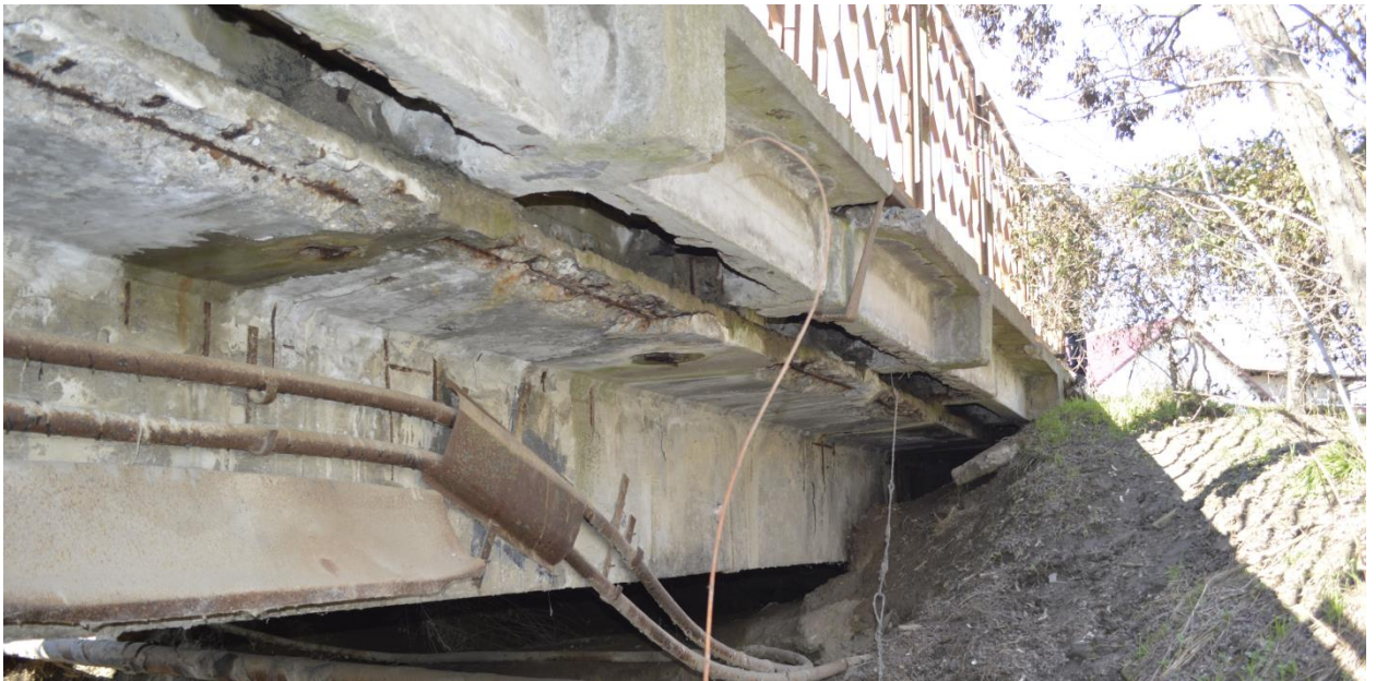
Fig.3.5.8. Degradarea grinzii marginale G1 deschiderea Nr.1, vedere amonte. Ancorarea de rețele ingineresti-cabluri electrice, optice etc., inoroirea grinzii cu pământ și gunoi, degradarea zonei de racordare grindă-placa de trotuar.
