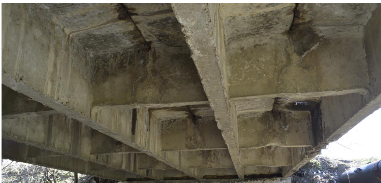
Fig. 3.5.11 Starea tehnică a suprastructurii deschiderii Nr.2. Grinzile nr.6-nr.10, degradare rosturi, infiltrarea de săruri și corodarea armăturii elementelor suprastruturii, contasăgeata, lipsa gurilor de captare și scurgere a apelor.
