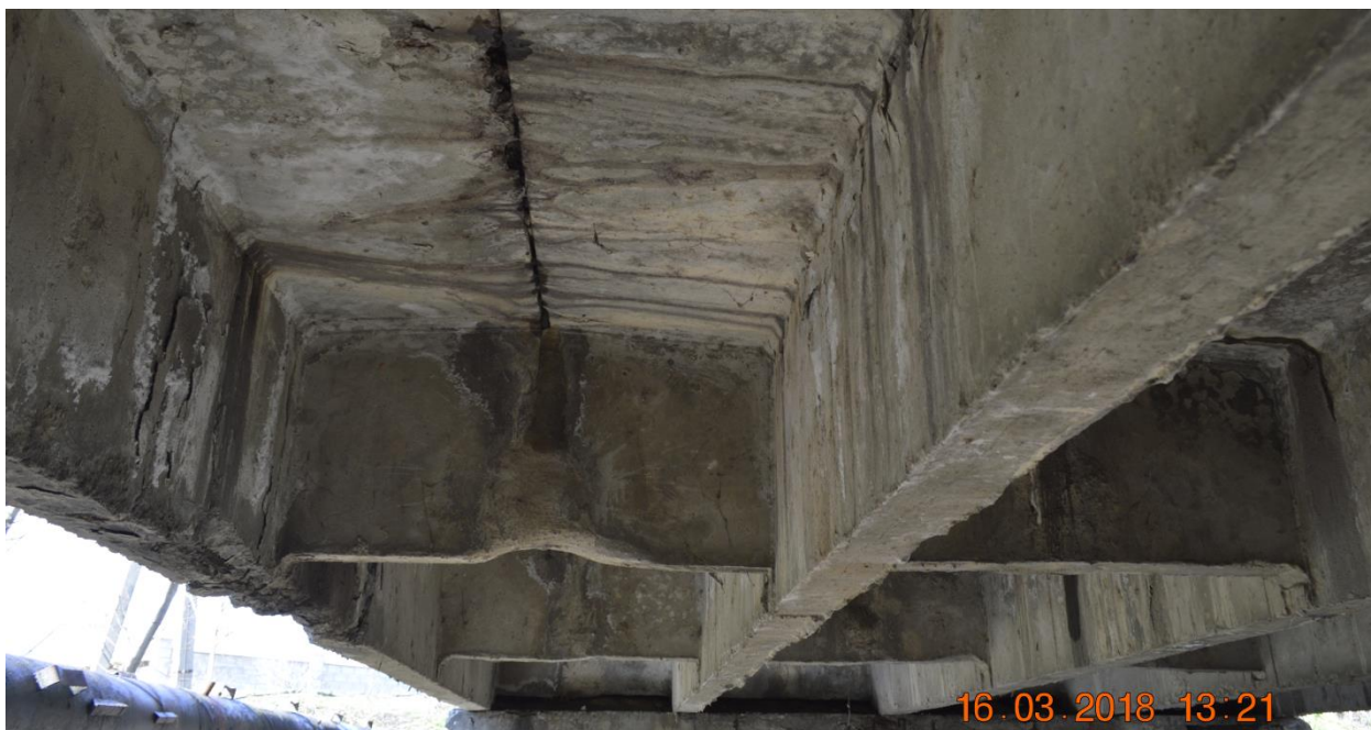
Fig. 3.5.12 Starea tehnică a suprastructurii deschiderii Nr.2. Grinzile nr.9-nr.10, degradare rosturi, infiltrarea de săruri și corodarea armăturii elementelor suprastruturii, contasăgeata, lipsa gurilor de captare și scurgere a apelor.
