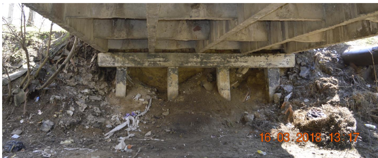
Fig. 3.4.2.1 Starea tehnică a culeei C2. Vedere generală.
