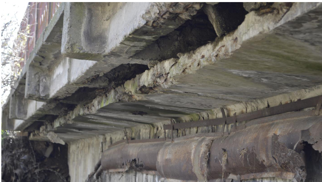
Fig.3.5.10. Degradarea 100% a zonelor de racordare grindă marginală placa prefabricată a trotuarelor. Disloarea și ruperea betonului, corodarea armăturii, infiltrarea de săruri, lipsa elementelor hidroizolante și de captare și evacuare a apelor.
