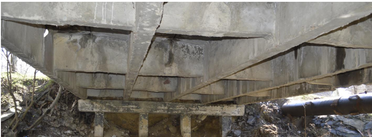
Fig. 3.5.5 Starea tehnică a suprastructurii deschiderii Nr.2. Grinzile nr.6-nr.10, degradare rosturi, pete albe de săruri și rugină, pete umede, contasăgeata.
