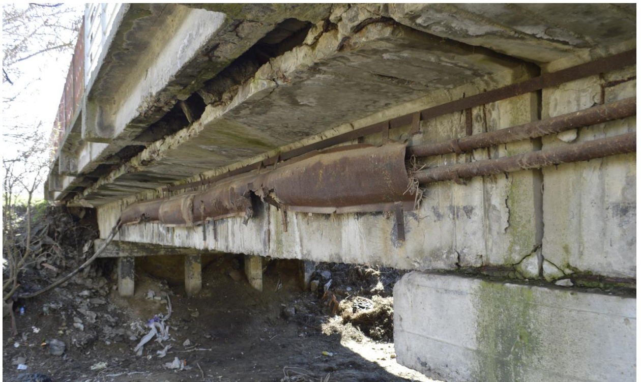
Fig.3.5.9. Degradarea grinzii marginale G6 deschiderea Nr.2, vedere amonte. Ancorarea de rețele ingineresti-cabluri electrice, optice etc., degradarea zonei grindă-placa de trotuar, degradarea consolii grinzii marginale și a zonei de reazem a grinzilor G1 și G6-ruperea și așchieria betonului.
