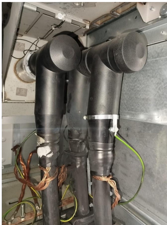
Vederea generală manșoanele terminale 10 kV f.C cablu de racord (până la demontare)
