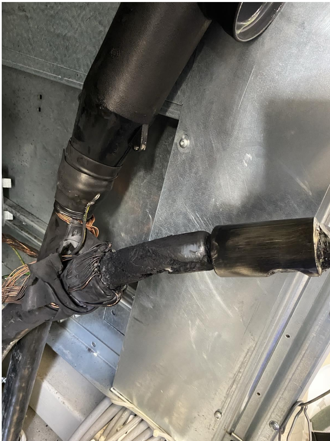
Manșonul terminal defect cu izolația exterioară demontată
