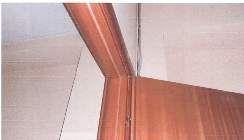
Foto nr. 25; 26; 27. Fisuri pe suprafețele interioare a pereților despărțitori.
