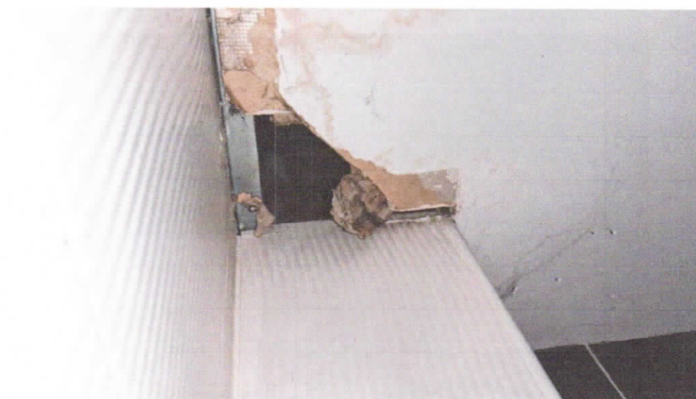
Foto nr. 81; 82; 83. Deteriorări ale tavanului în urma și pătrunderii apelor meteorice prin acoperișul deteriorat.
