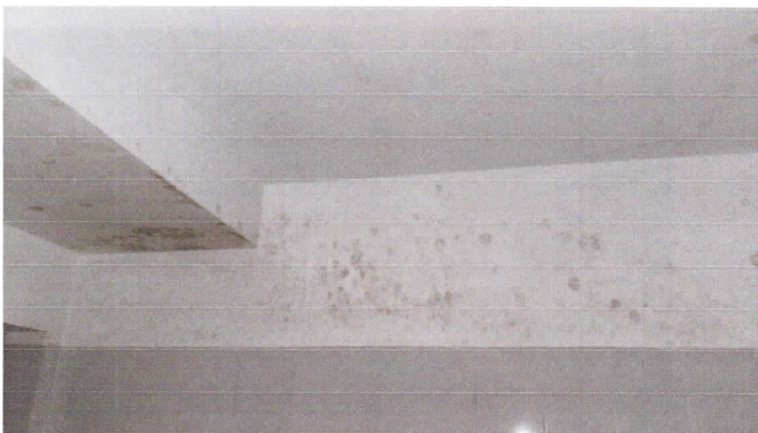
Foto nr. 30; 31. Distrugerea finisajului și stratificarea tencuiei în lipsa hidroizolării pereților de la demisol de la infiltrarea apelor pluviale și de la scurgeri ale rețelilor ingineresti din interiorul demisolului.
