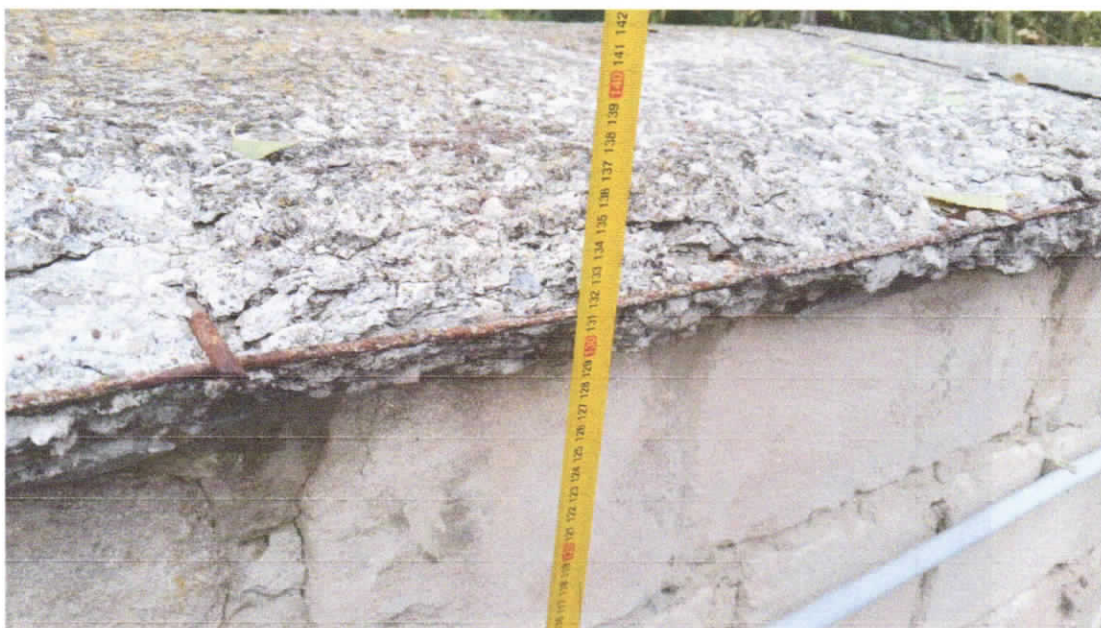
Foto nr. 131; 132. Starea tehnică a parapetului acoperișului.
