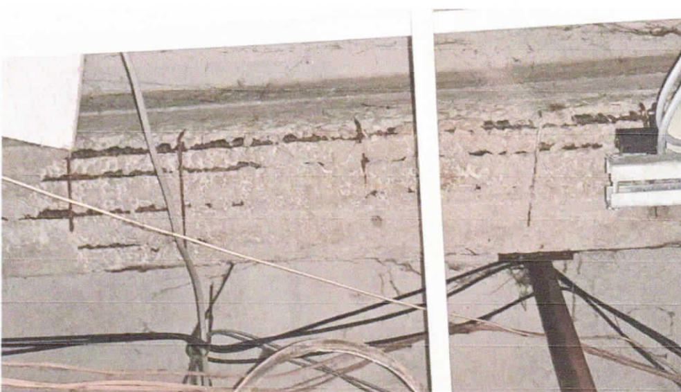
Foto nr. 102; 103; 104. Starea tehnică a elementelor structurale ale planșeului intermediar (deasupra parterului). Deteriorări ale betonului și armăturii grinzilor.
