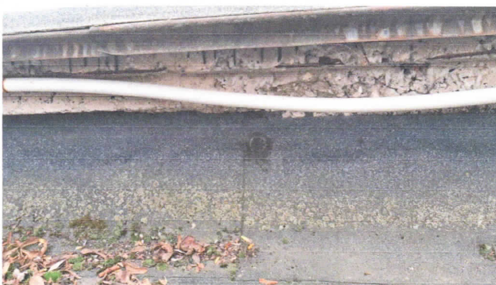
Foto nr. 148; 149; 150. Starea tehnică a parapetului acoperișului.
