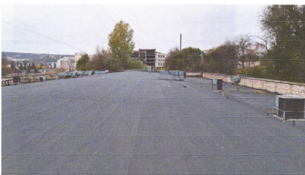
Foto nr. 113; 114; 115. Starea tehnică a acoperișului.
