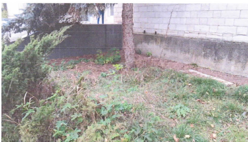
Foto nr. 41; 42; 43. Pereul din asfalt-beton deteriorat (fisurat). Amenajarea necorespunzătoare a terenului adiacent.
