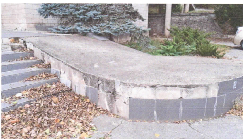
Foto nr. 20; 21; 22. Degradări și deteriorări ale finisajelor scării și rampei de la intrarea principală în clădire din partea de Sud-Est.
