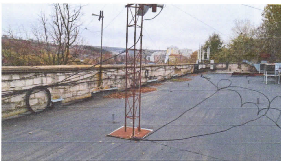
Foto nr. 119; 120; 121. Starea tehnică a acoperișului.
