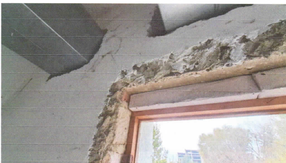
Foto nr. 153; 154; 155. Starea tehnică a anexei clădirii (vederi generale).
