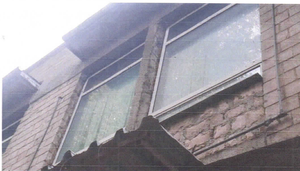
Foto nr. 46; 47 Degradări ale stratului de protecție și deteriorări prin dezgolirea armăturii porțiunilor pereților intergol executate din beton armat monolit.
