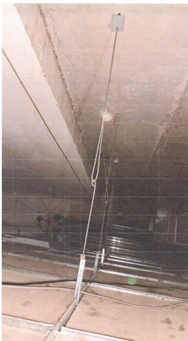
Foto nr. 92; 93. Starea tehnică a elementelor structurale ale planșeului intermediar (deasupra parterului). Zona de joncțiune a planșeului edificat inițial cu planșeul edificat în anul 1998.
