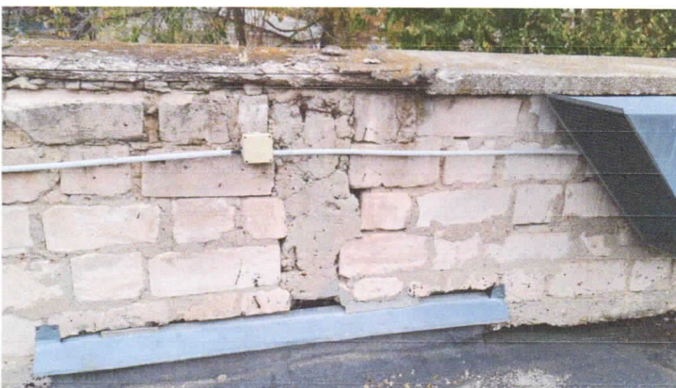
Foto nr. 136; 137; 138. Starea tehnică a parapetului acoperișului.
