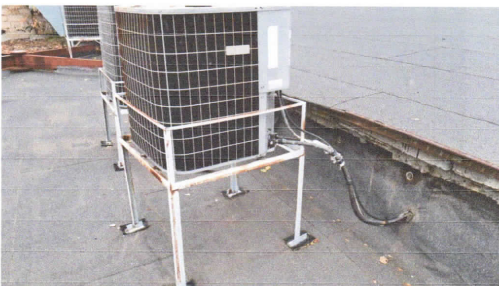
Foto nr. 125; 126; 127. Starea tehnică a acoperișului și utilajului de ventilare.
