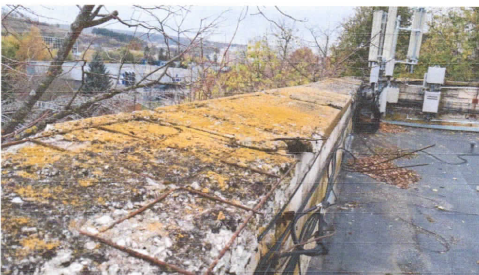
Foto nr. 142; 143; 144. Starea tehnică a parapetului acoperișului.
