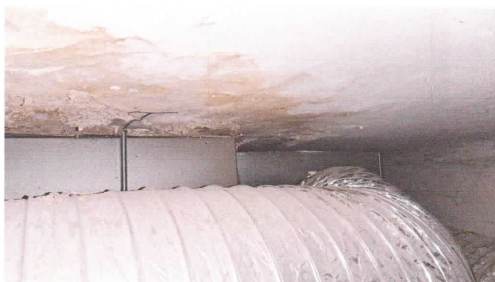
Foto nr. 75; 76; 77. Starea tehnică a elementelor structurale ale acoperișului. Deteriorări ale tencuielii planșeului în urma spargerii straturilor acoperișului și panourilor de planșeu, și pătrunderii apelor meteorice.
