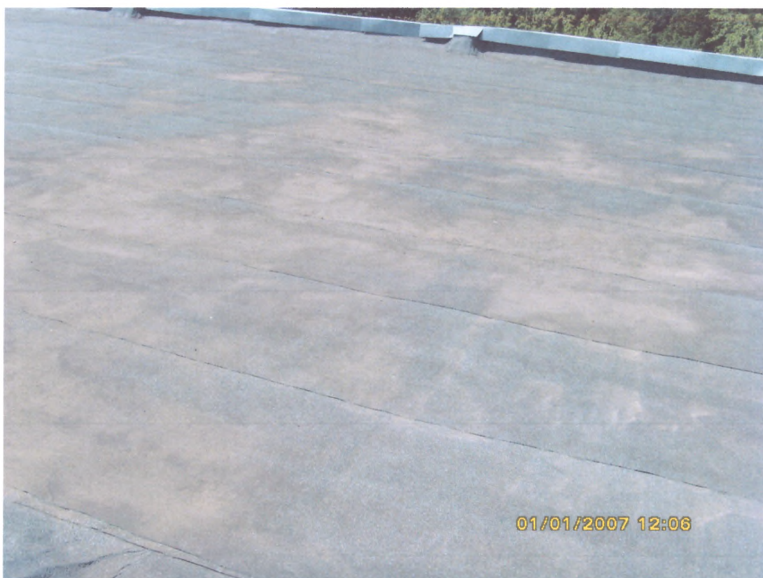
c: Anexa 6: Deformații/inconveniențe alcătuire/execuție acoperiș.
