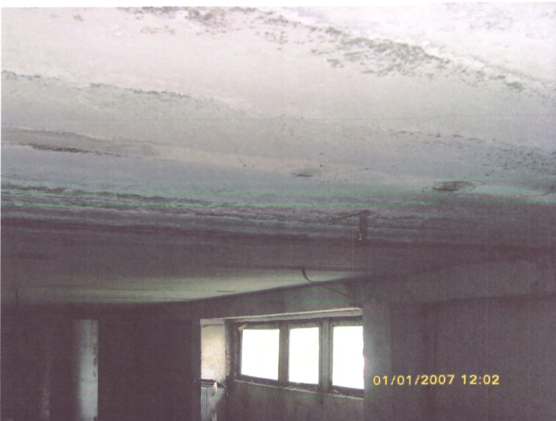
c: Anexa 5: Structură planșeu acoperiș - Construcția de sănătate, asistență socială cu nr. cadastral 00300209.961.01 (lit. B) din complexul IMSP CENTRUL MEDICILOR DE FAMILIE MUNICIPAL BĂLȚI de pe str. Decebal, 101/V, mun. Bălți.
