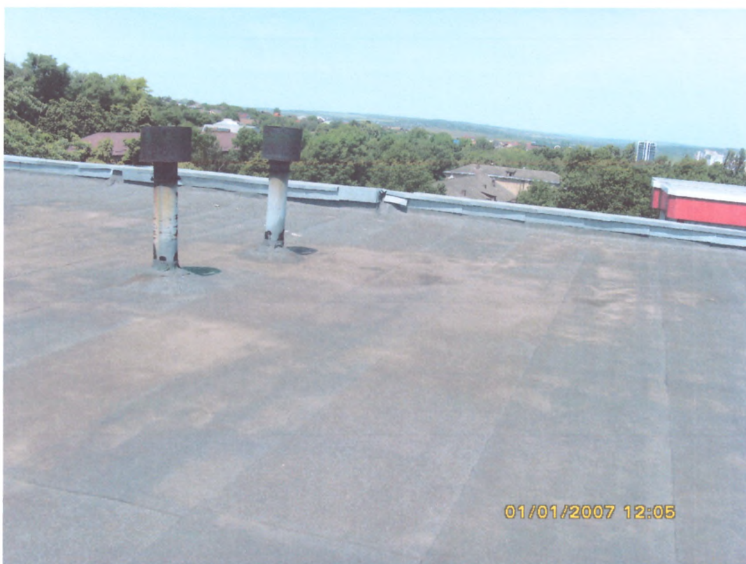
b: Anexa 6: Deformații/inconveniențe alcătuire/execuție acoperiș.
