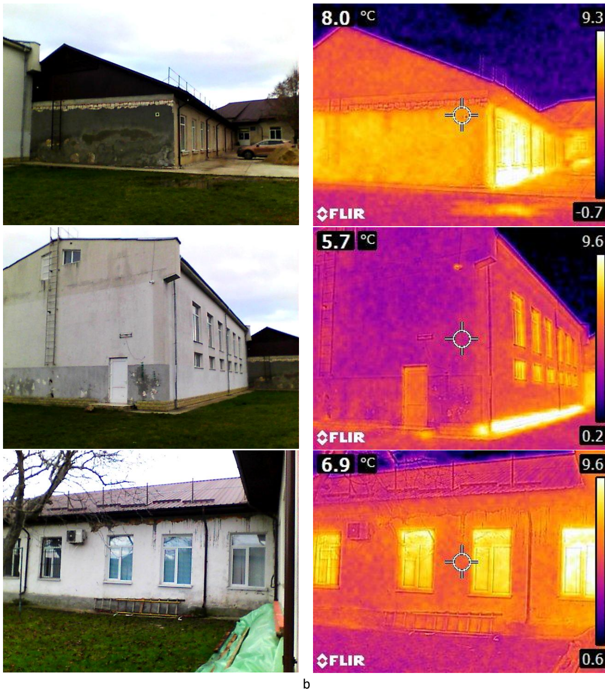
Figura 3. Poze luate cu camera de termoviziune
