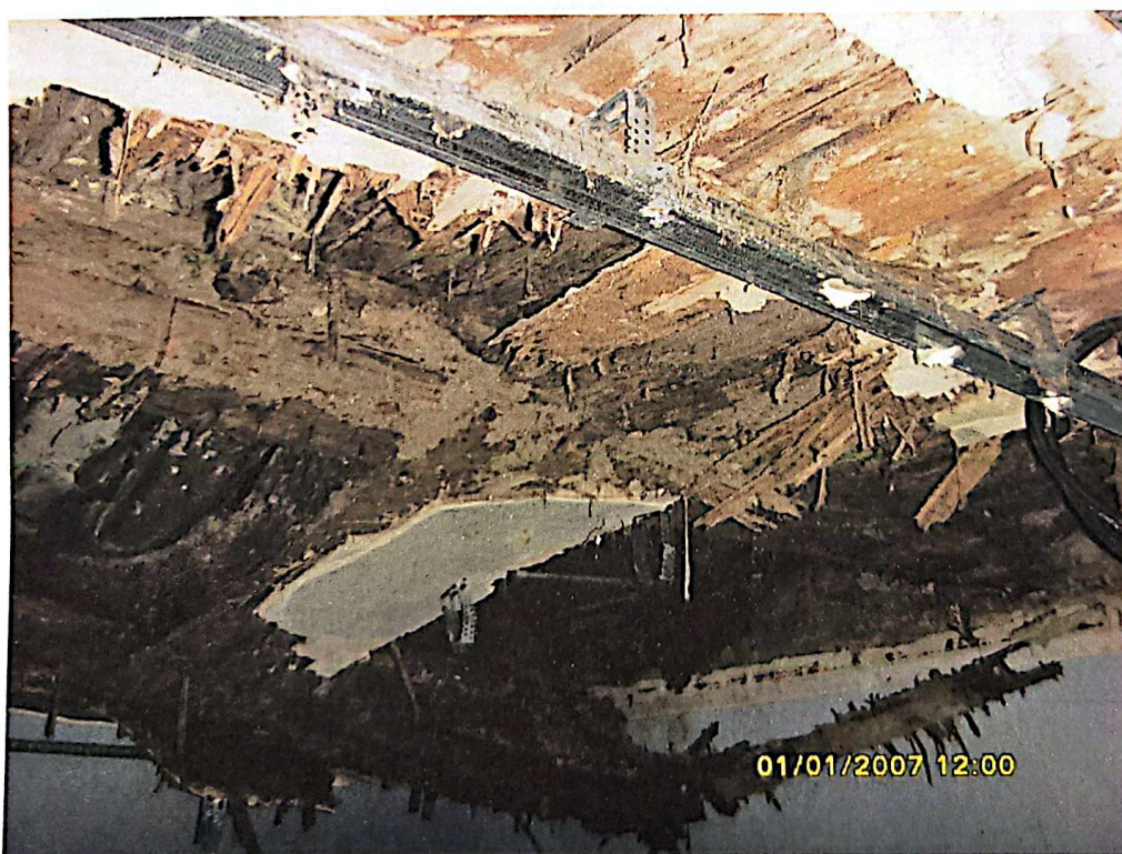
∴ Anexa 8: Deformații structură planșeu peste subsol - Sector în limita volumului examinat.
