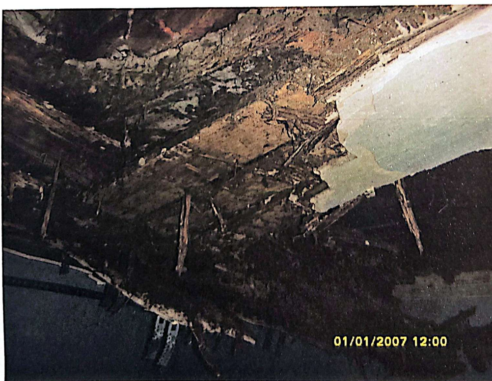
f: Anexa 8: Deformații structură planșeu peste subsol - Sector în limita volumului examinat.
