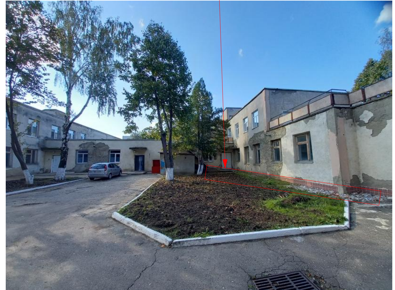
Pereul existent este în stare deplorabilă - se demontează
