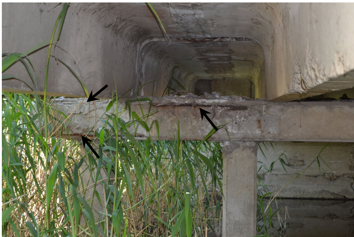
Foto 8. Pila 2. Rigla 2. Degradarea betonului.
