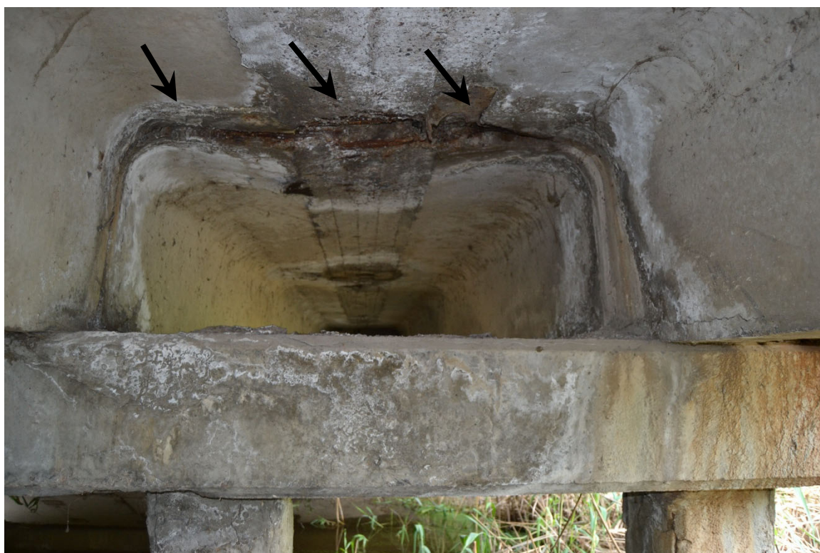
Foto 4. Suprastructura. Rost transversal nr.2. Grinda 5-6. Infiltrații de apă, pete albicioase, degradarea stratului de protecție a betonului.
