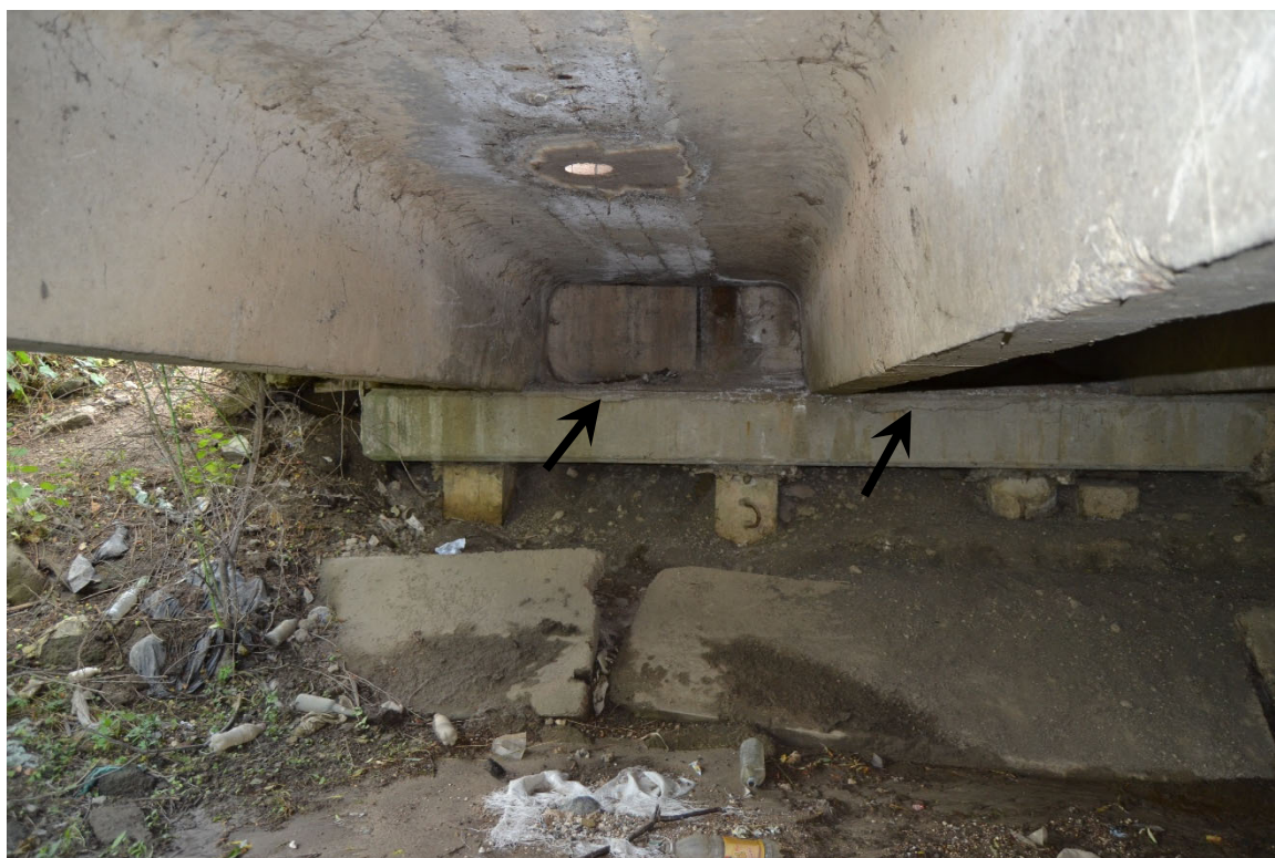
Foto 10. Culeea 3. Rigla 3. Fisuri și crăpături pe suprafața riglei.
