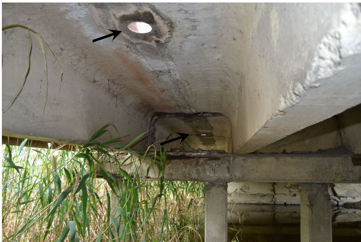
Foto 5. Deschiderea 2-3. Rost longitudinal. Grinda 7-8. Lipsa gurilor de evacuare apelor de pe carosabil.
