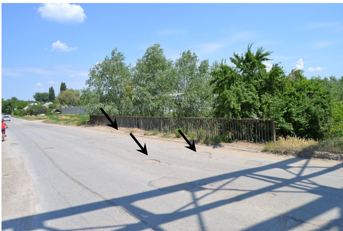
Foto 2. Calea podului. Neasigurarea pantei de scurgere a apelor de pe pod. Trotuar degradat, prezanța molozului și vegetației.
