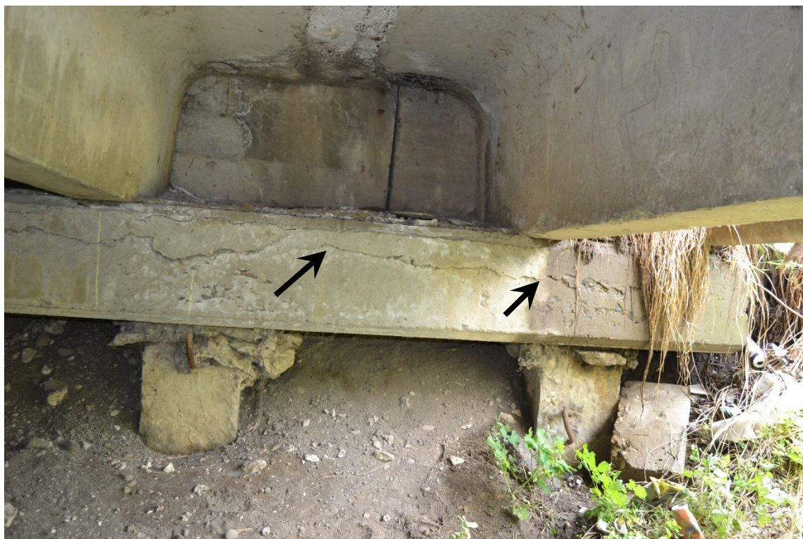
Foto 9. Culeea 3. Rigla 3. Fisuri și crăpături pe suprafața riglei.
