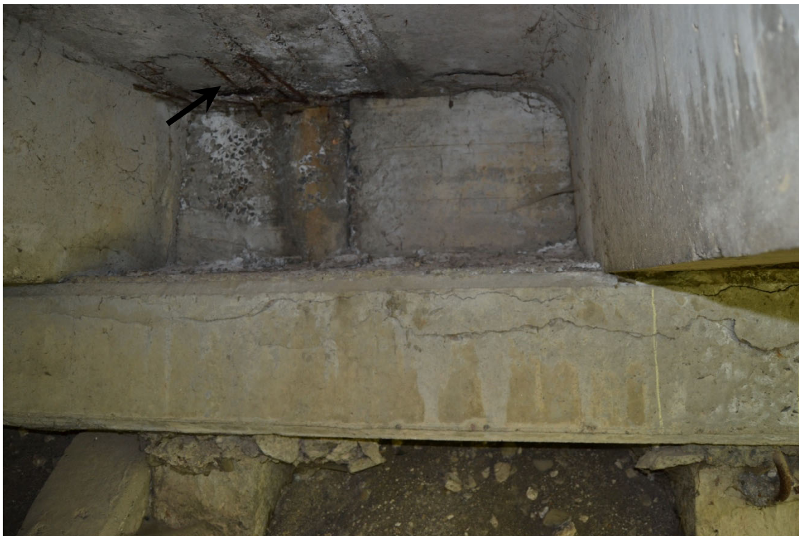
Foto 3. Deschiderea 2-3. Grinda 3. Infiltrații de apă, pete albicioase, degradarea stratului de protecție a betonului.
