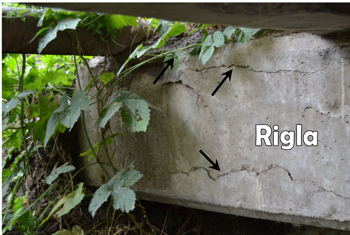
Foto 7. Culeea 1. Rigla 1. Degradarea betonului, prezența molozului pe riglă.
