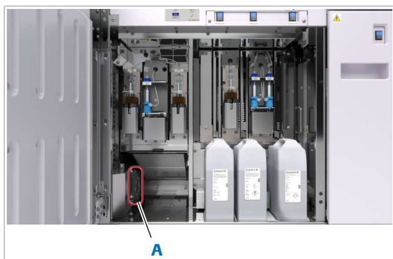
A Filtrul ventilatorului
