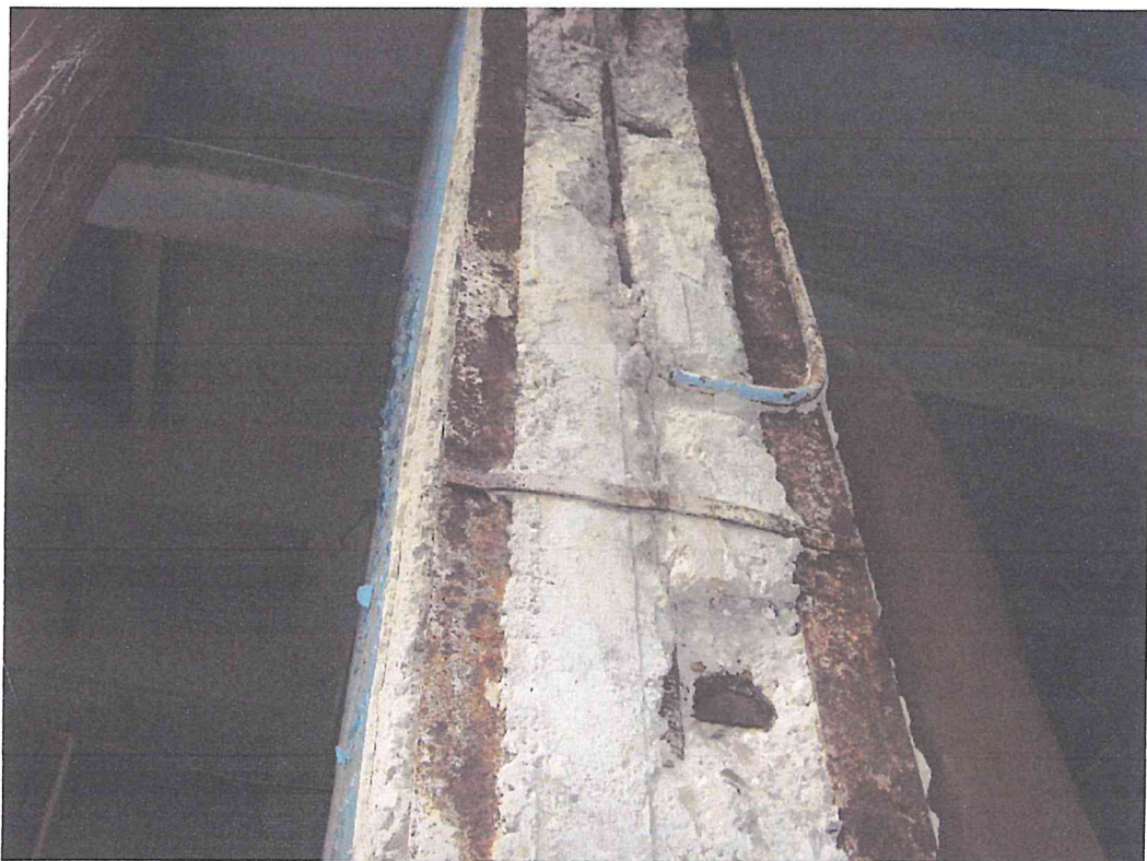
d : Anexa 4: Deformații/degradări în elementele de alcătuire ale coloanei din beton armat din rândul B, axa 24 – clădirea principală de producere cu nr. cadastral 0100424.045.51.
