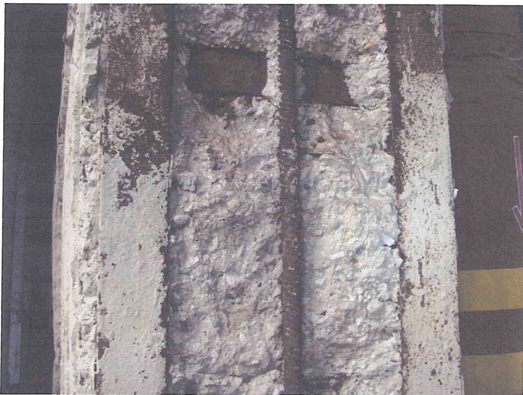
c : Anexa 4: Deformații/degradări în elementele de alcătuire ale coloanei din beton armat din rândul B, axa 24 – clădirea principală de producere cu nr. cadastral 0100424.045.51.
