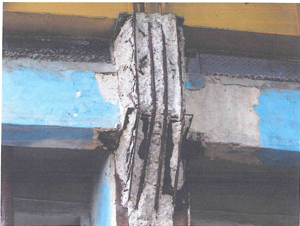
\alpha : Anexa 4: Deformații/degradări în elementele de alcătuire ale coloanei din beton armat din rândul B, axa 24 – clădirea principală de producere cu nr. cadastral 0100424.045.51.
