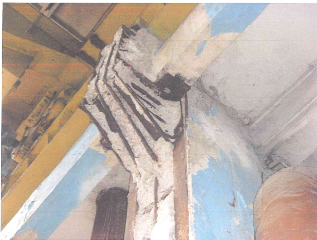
e : Anexa 4: Deformații/degradări în elementele de alcătuire ale coloanei din beton armat din rândul B, axa 24 – clădirea principală de producere cu nr. cadastral 0100424.045.51.
