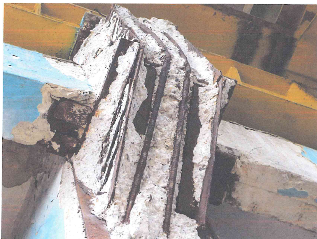
b: Anexa 4: Deformații/degradări în elementele de alcătuire ale coloanei din beton armat din rândul B, axa 24 – clădirea principală de producere cu nr. cadastral 0100424.045.51.
