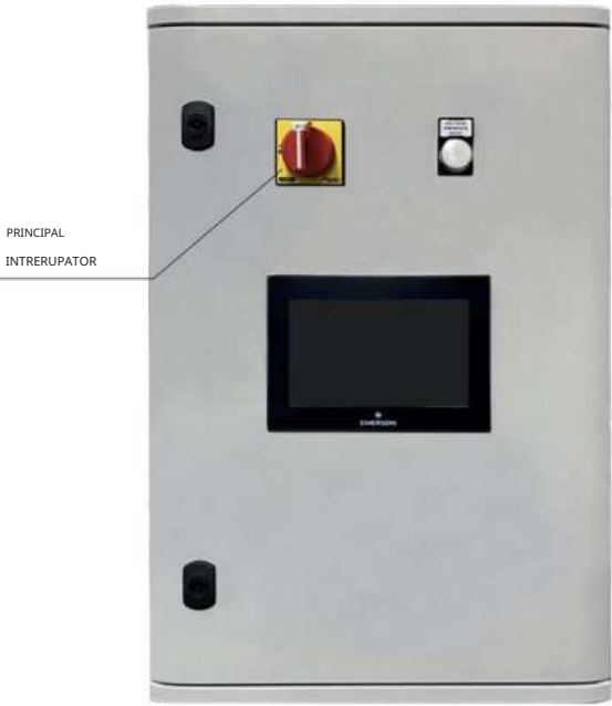
Figura 16. Comutatorul principal al panoului de control
