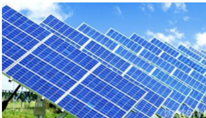
СОНЯЧНА ЕЛЕКТРОСТАНЦІЯ ООО «АСК Інжиниринг» Херсонська обл. 2019
