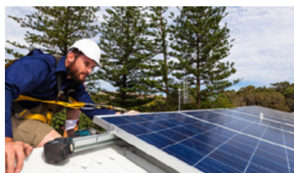
СОНЯЧНА ЕЛЕКТРОСТАНЦІЯ ООО «МІІА ГРУП» Дніпро 2019
