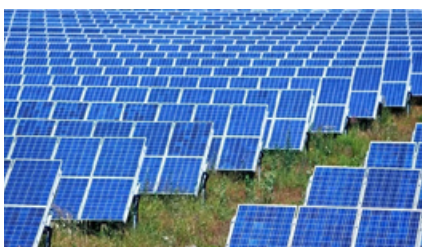
СОНЯЧНА ЕЛЕКТРОСТАНЦІЯ ООО «СОЛАР ЕНЕРЖІ-СКІФ» Вінниця 2019
