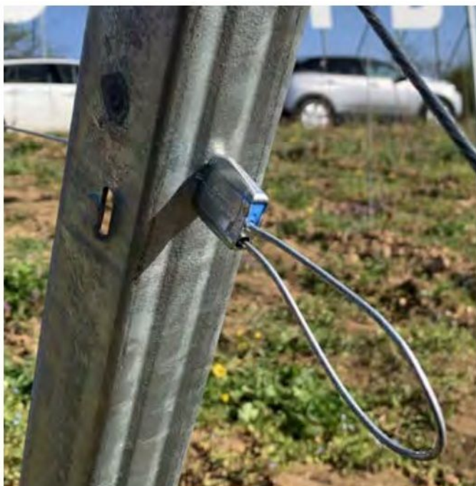
Instalat pe spalieri de metal
