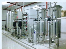
水处理中心 Water treatment center
