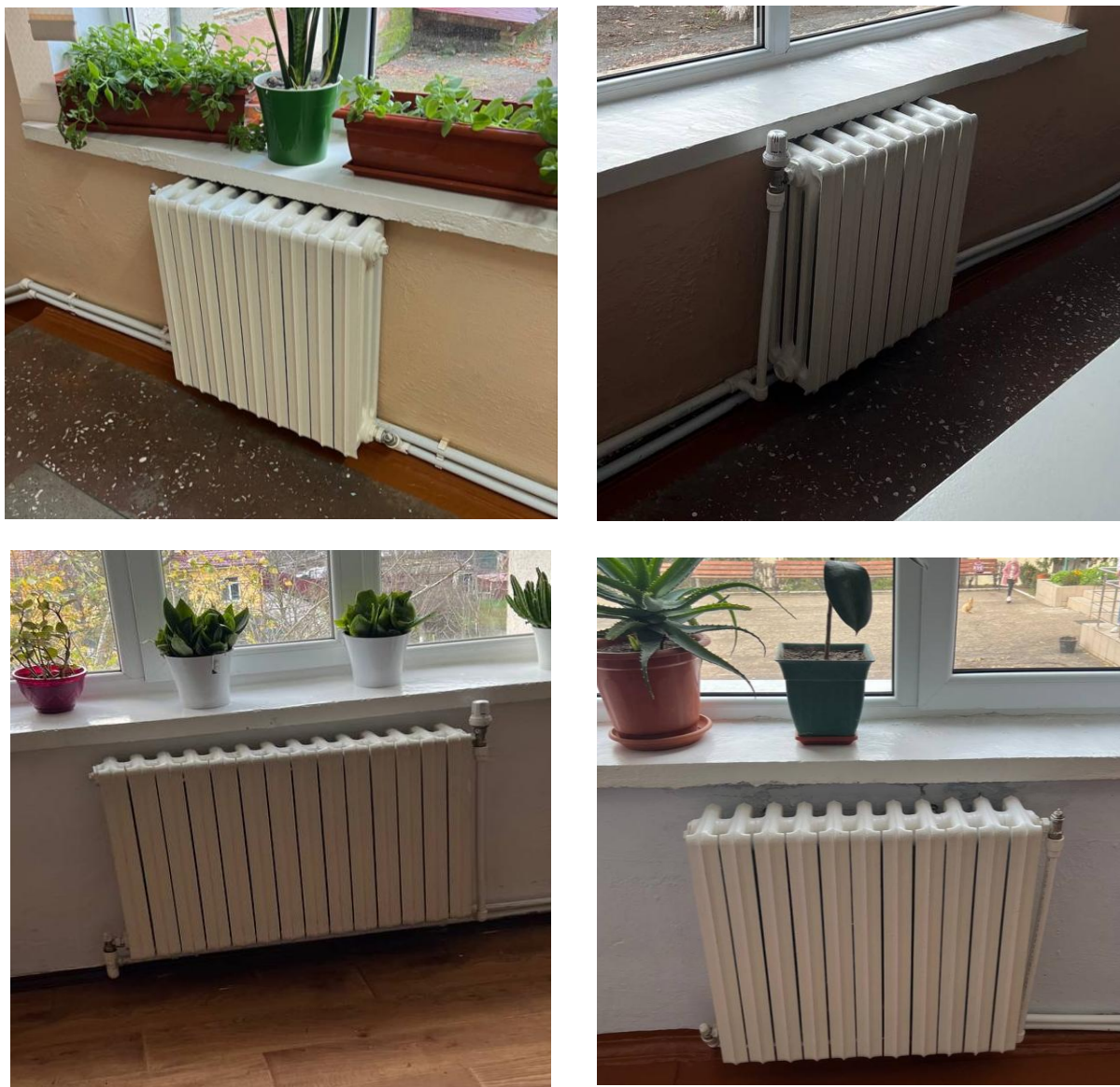
Figura 16. Sistemul interior de distribuție a energiei termice.
