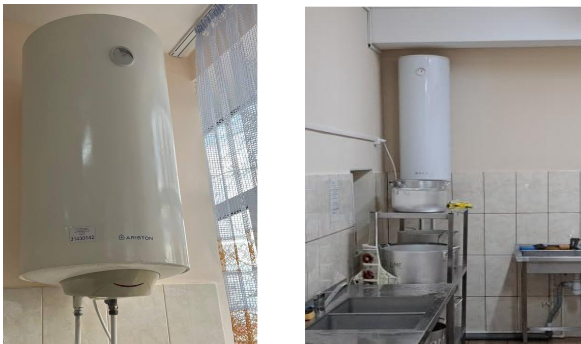
Figura 18. Vedere a sistemului de apă caldă menajeră
