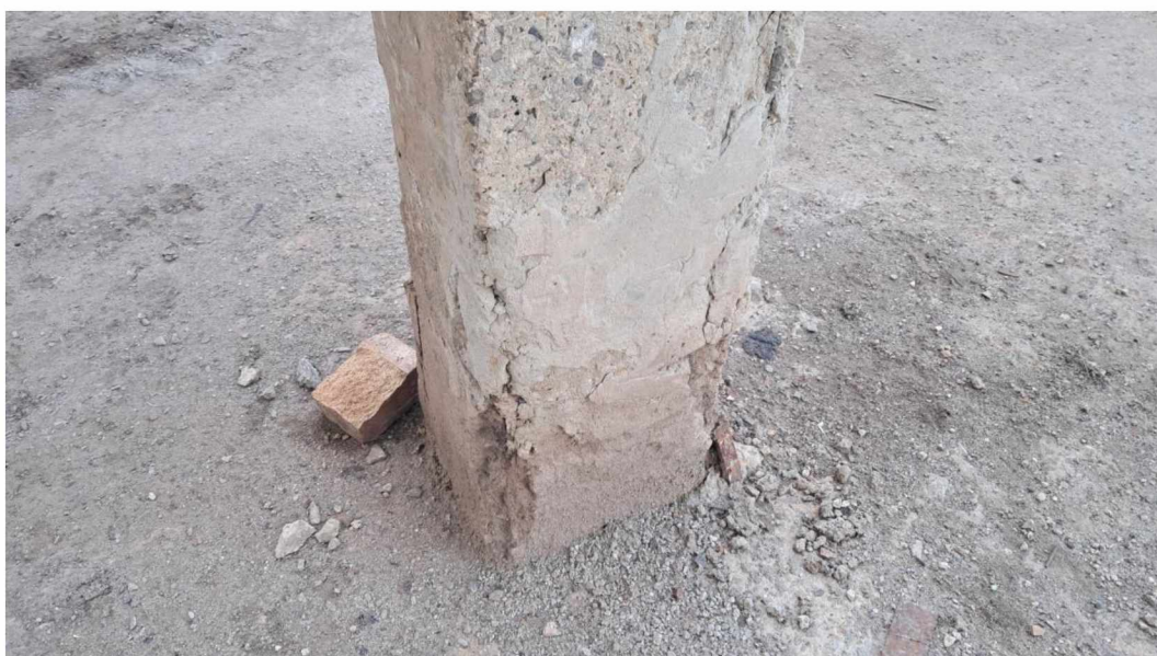
Foto nr. 28; 29; 30. Starea tehnică a pilonilor.
