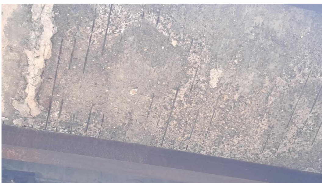
Foto nr. 73; 74; 75. Starea tehnică a planșeului intermediar.
