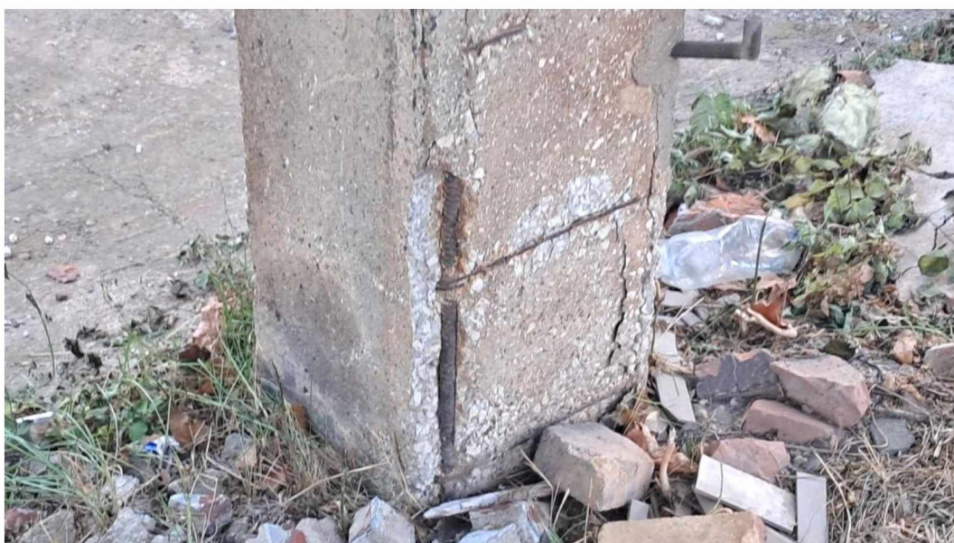
Foto nr. 43; 44; 45. Starea tehnică a pilonilor.
