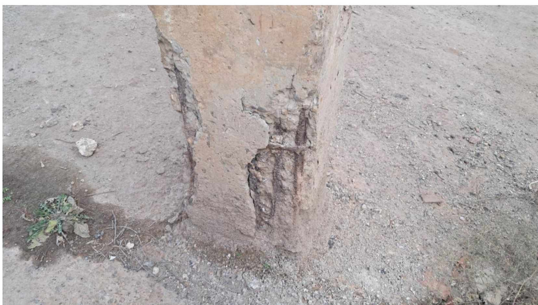
Foto nr. 25; 26; 27. Starea tehnică a pilonilor.
