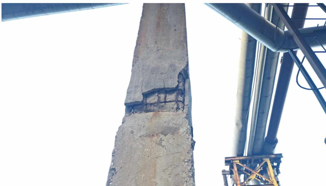
Foto nr. 52; 53; 54. Starea tehnică a pilonilor.
