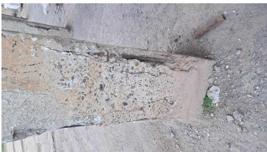
Foto nr. 34; 35; 36. Starea tehnică a pilonilor.
