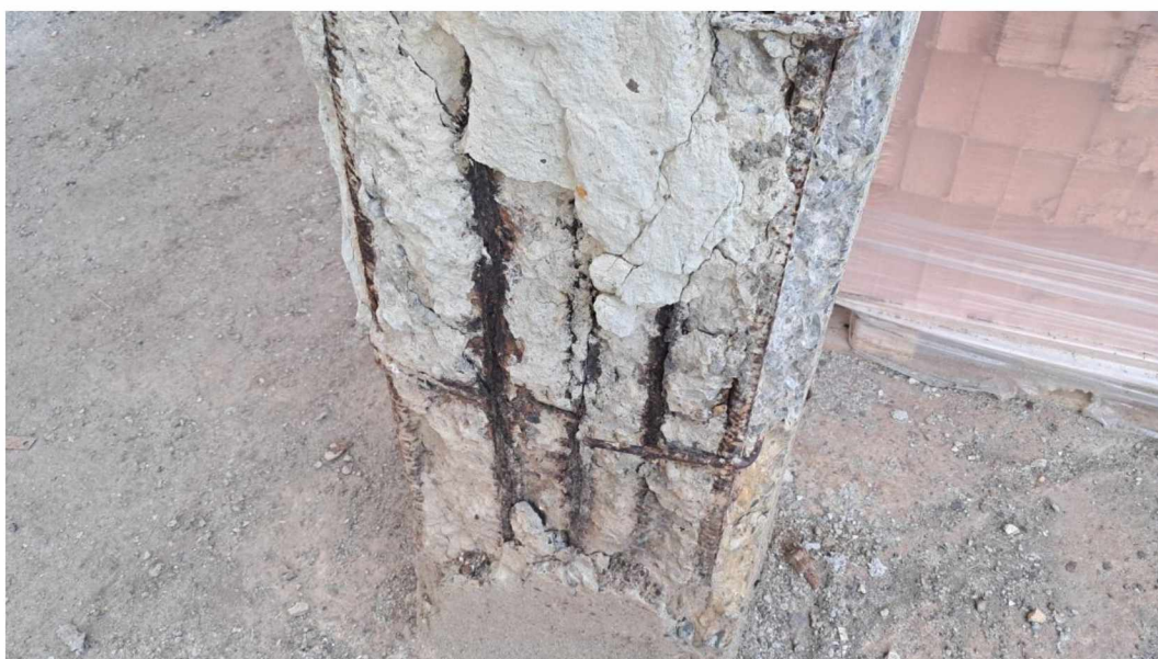
Foto nr. 31; 32; 33. Starea tehnică a pilonilor.
