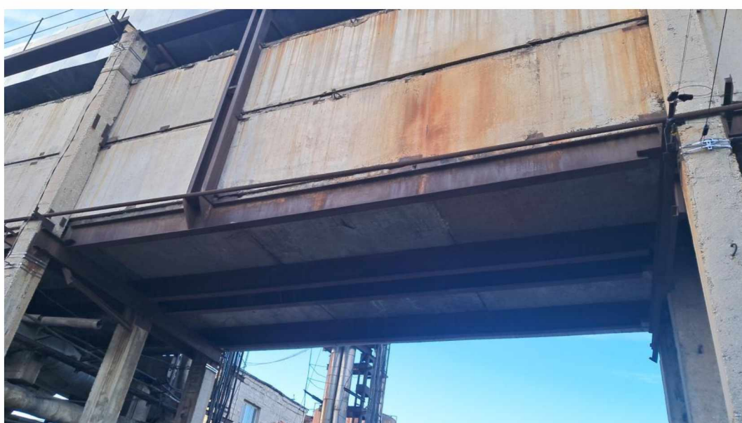
Foto nr. 61; 62; 63. Starea tehnică a grinzilor metalice, planșeului intermediar și pereților.
