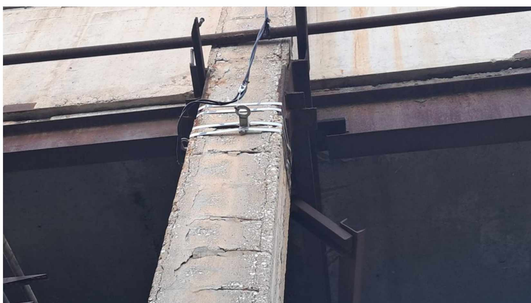
Foto nr. 70; 71; 72. Starea tehnică a nodurilor de îmbinare a grinzilor metalice cu pilonii.
