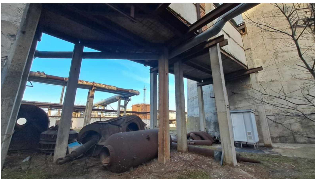
Foto nr. 9. Pilonii din partea de nord-est a canalului care se află în stare tehnică satisfăcătoare și nu necesită măsuri de consolidare.
