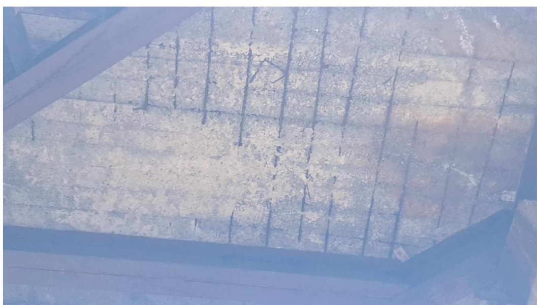
Foto nr. 79; 80; 81. Starea tehnică a planșeului intermediar.
