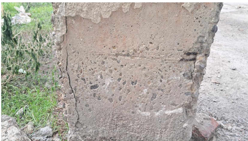
Foto nr. 22; 23; 24. Starea tehnică a pilonilor.
