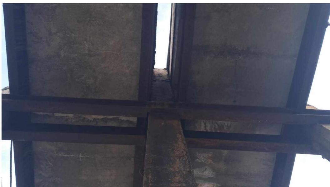
Foto nr. 55; 56; 57. Starea tehnică a grinzilor metalice și planșeului intermediar.
