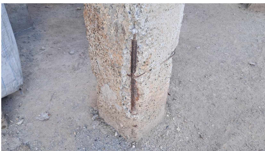
Foto nr. 37; 38; 39. Starea tehnică a pilonilor.
