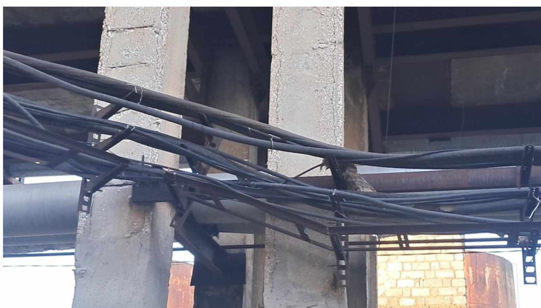
Foto nr. 40; 41; 42. Starea tehnică a pilonilor.
