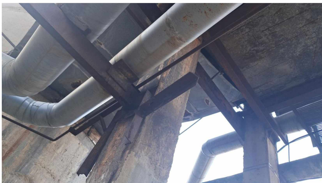
Foto nr. 58; 59; 60. Starea tehnică a grinzilor metalice și planșeului intermediar.
