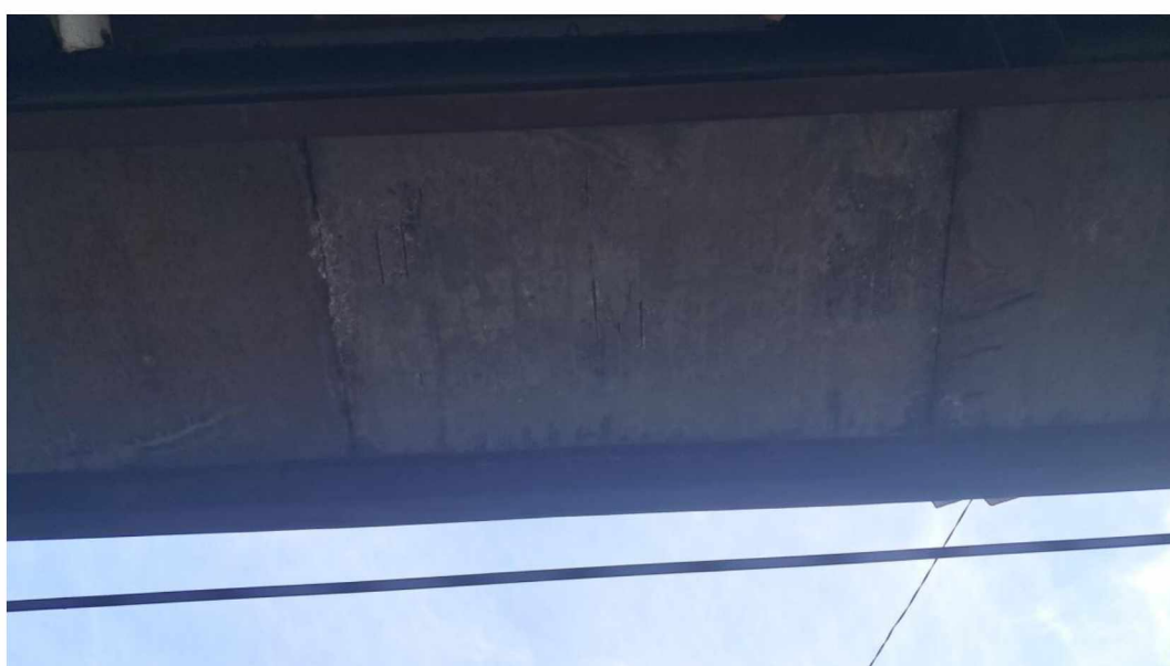
Foto nr. 76; 77; 78. Starea tehnică a planșeului intermediar.
