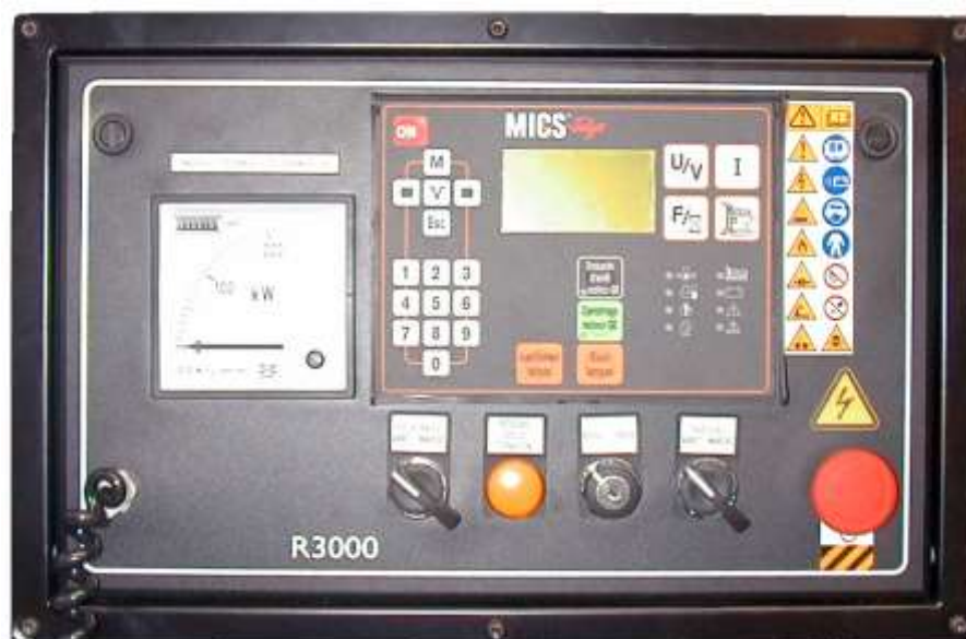
Figure 3 – Tableau de commande
