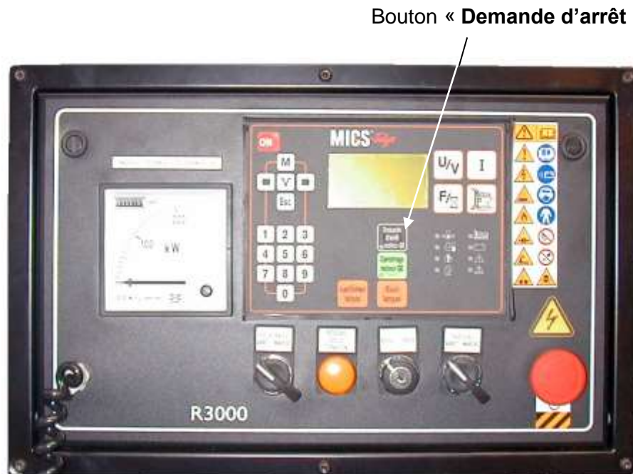
Figure 22 - Arrêt du groupe électrogène
