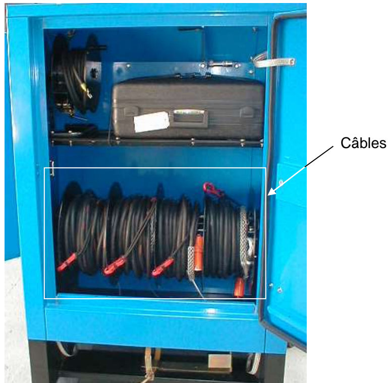
Figure 12 – Câbles de puissance
