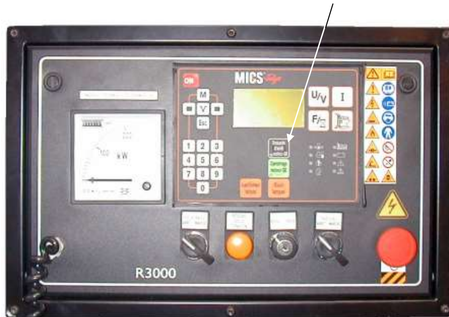
Figure 14 - Arrêt du groupe électrogène
