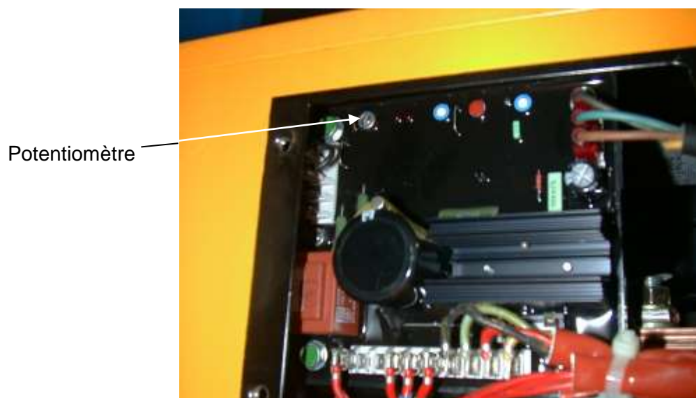
Figure 10 – Régulateur de tension
