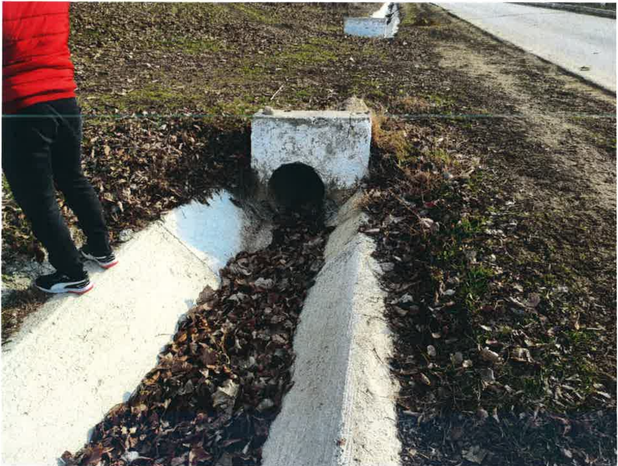
Podet reparat în anul 2017 – 2018.
