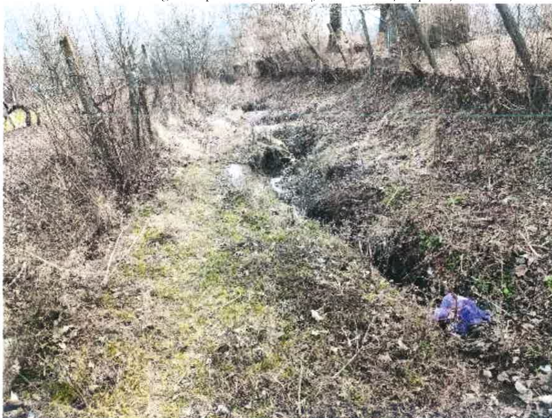
Vedere rigolă rapidă existentă, înfundată la ieșire podeț
