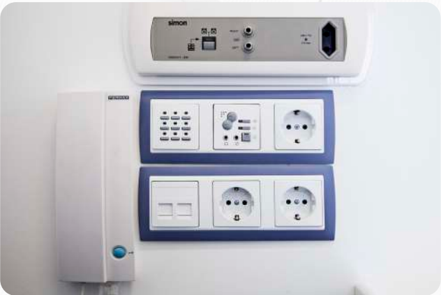
Instalación eléctrica adaptada Adapted electrical installation
