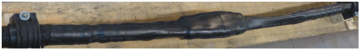
Fotografia 5. Widok mufy przelotowej typu CHMPP(H)SV 3
