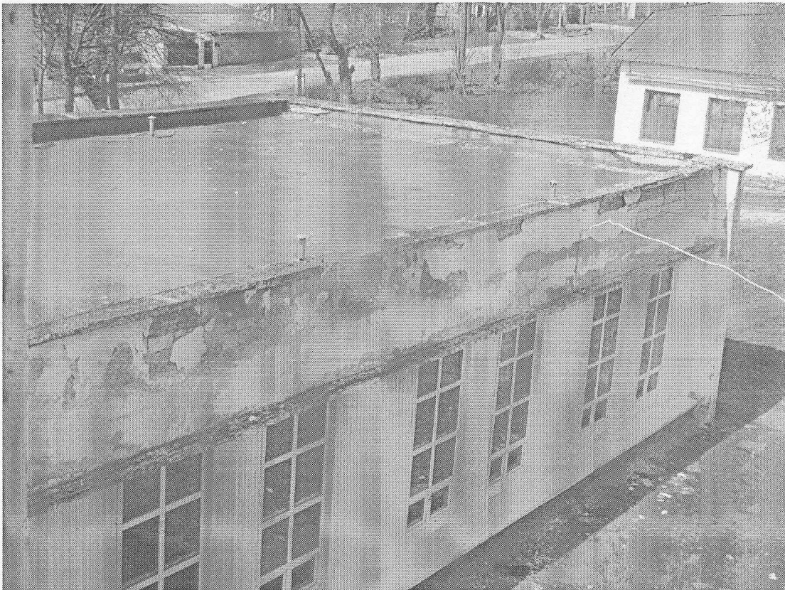
Anexa nr.20. Starea tehnică a acoperișului blocului lit.48
