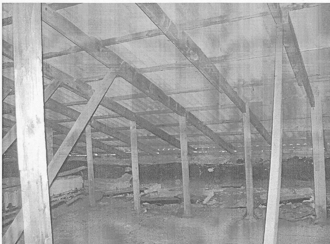
Anexa nr.28. Elemente lipsă în structura de rezistență a acoperișului blocului lit.A4
