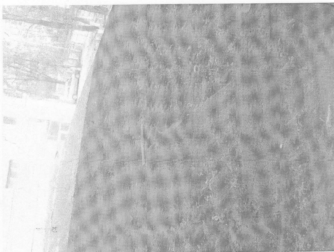
Anexa nr.22. Starea tehnică a acoperișului blocului lit.A5
