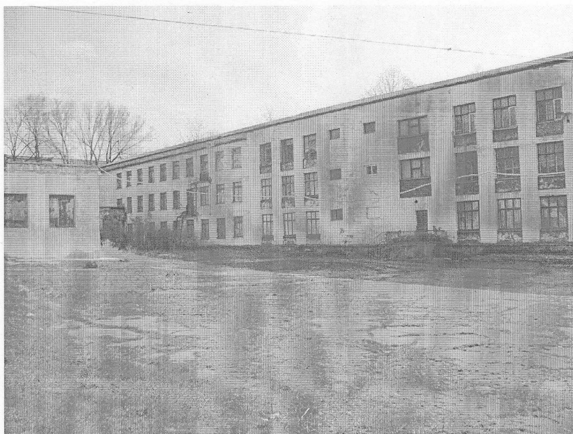
Anexa nr.24. Starea tehnică a acoperișului și fațadei din curte a blocurilor lit.A3 și lit.A4
