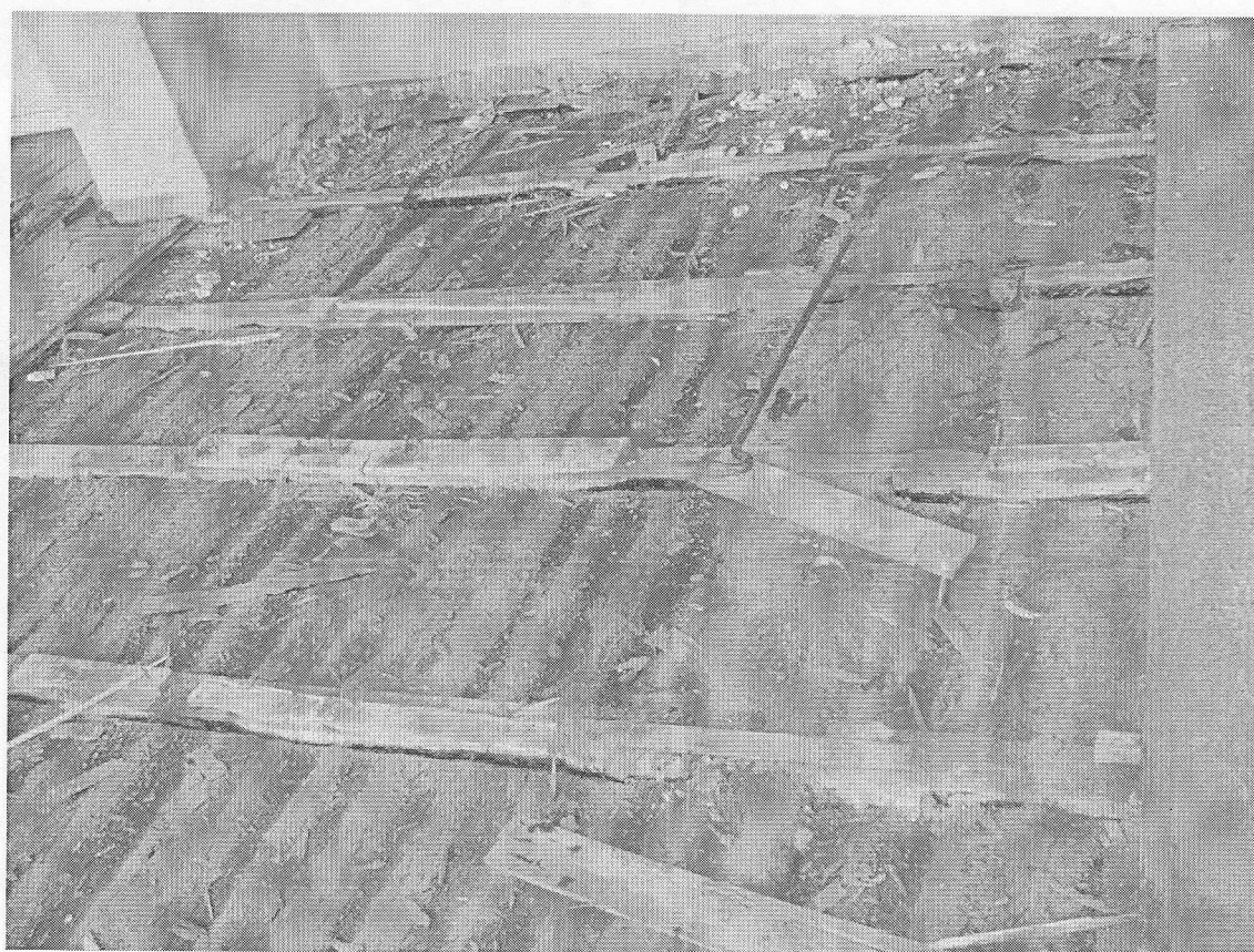
Anexa nr.9. Starea tehnică a grinzilor de lemn din structura planșeului dintre etajul 2 și 3 al blocului lit.A
