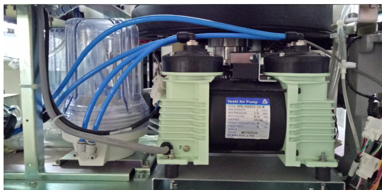
图 7-6 废液泵和废液负压罐
