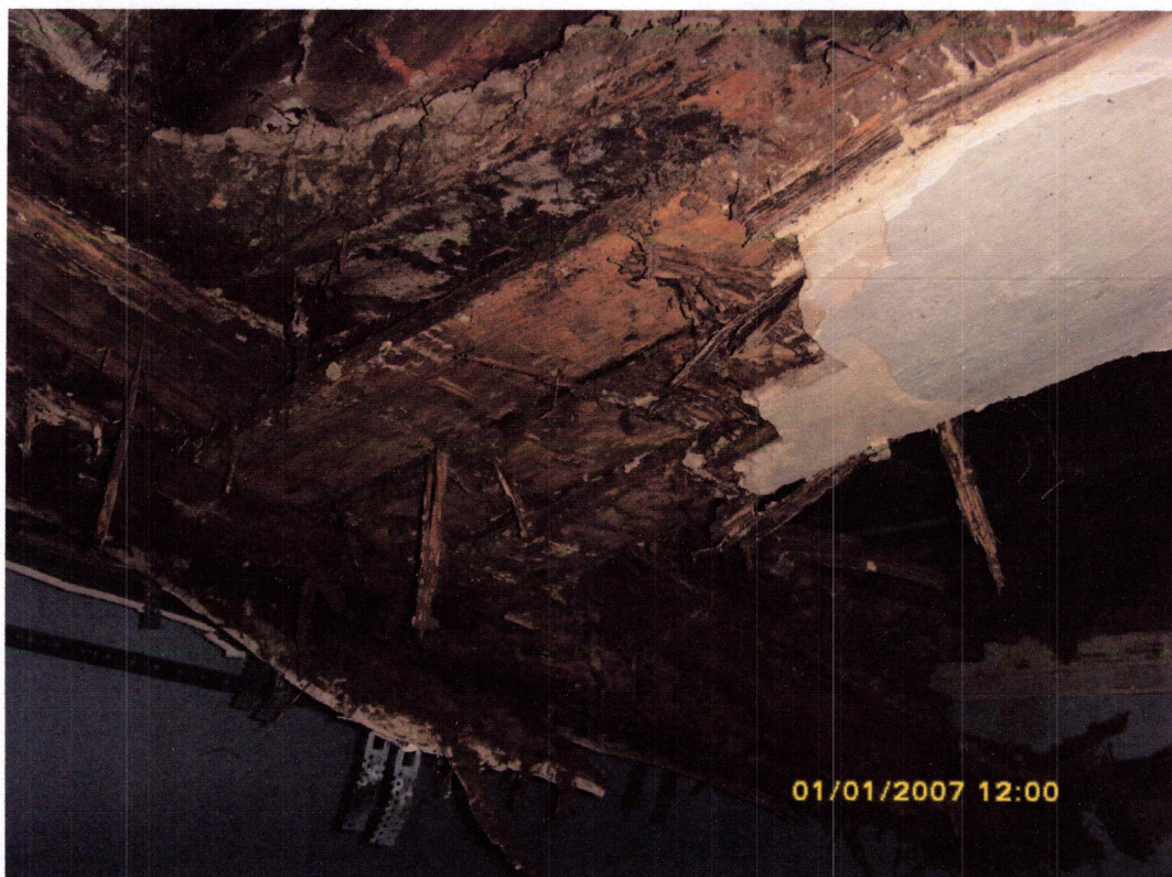
f : Anexa 8: Deformații structură planșeu peste subsol - Sector în limita volumului examinat.
