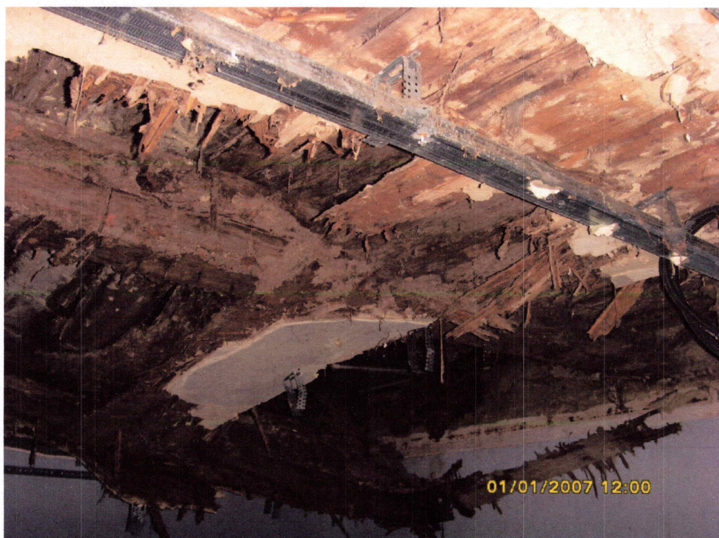
a: Anexa 8: Deformații structură planșeu peste subsol - Sector în limita volumului examinat.
