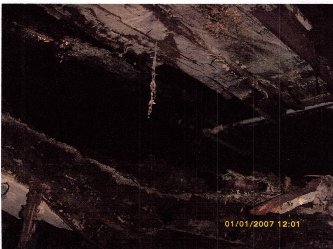
d: Anexa 8: Deformații structură planșeu peste subsol - Sector în limita volumului examinat.
