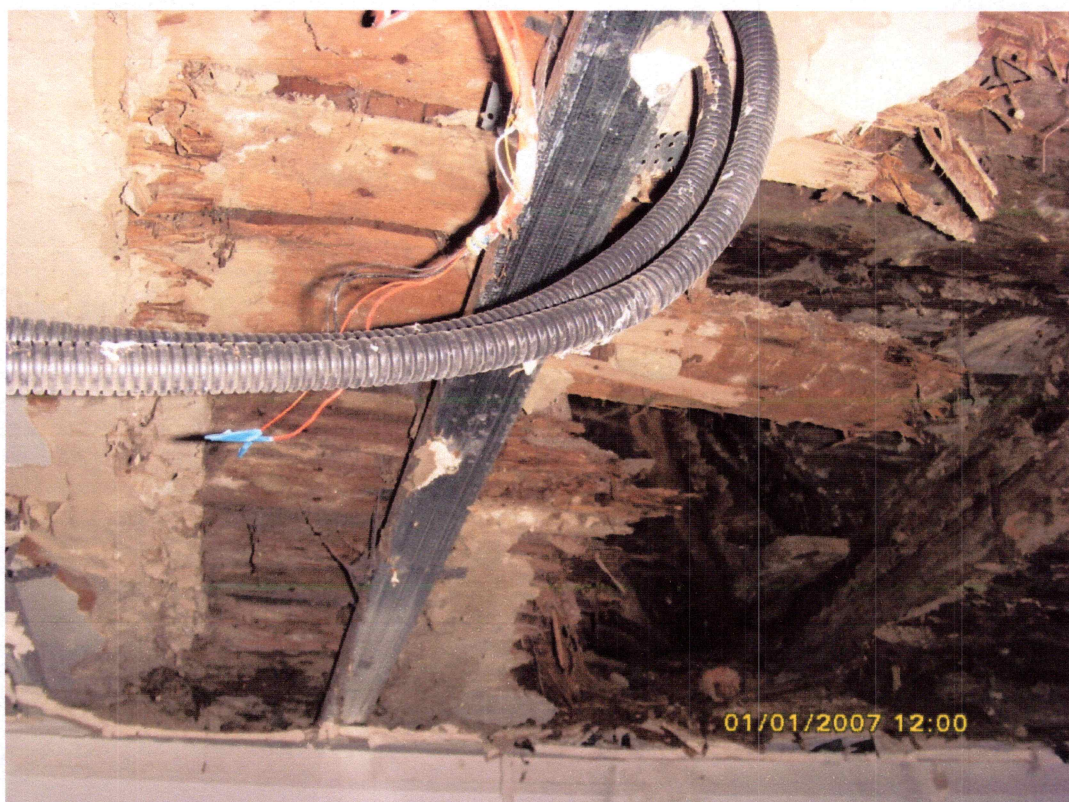
b: Anexa 8: Deformații structură planșeu peste subsol - Sector în limita volumului examinat.
