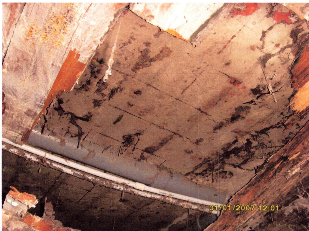
c: Anexa 8: Deformații structură planșeu peste subsol - Sector în limita volumului examinat.
