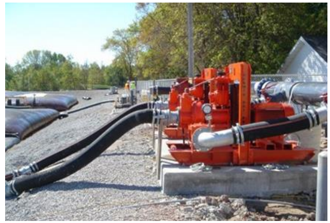
Pompele utilizate la tehnologia Geotube®
