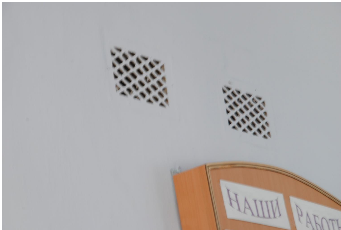
Figura 10 Tipul ventilării existente la obiectul de audit
