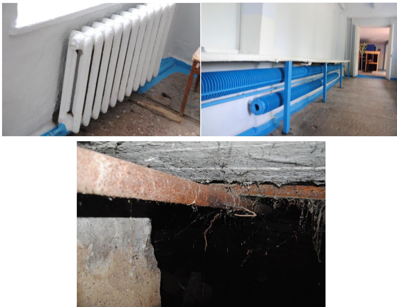
Figura 9 Corpurilor de încălzit și conductelor sistemului de încălzire
