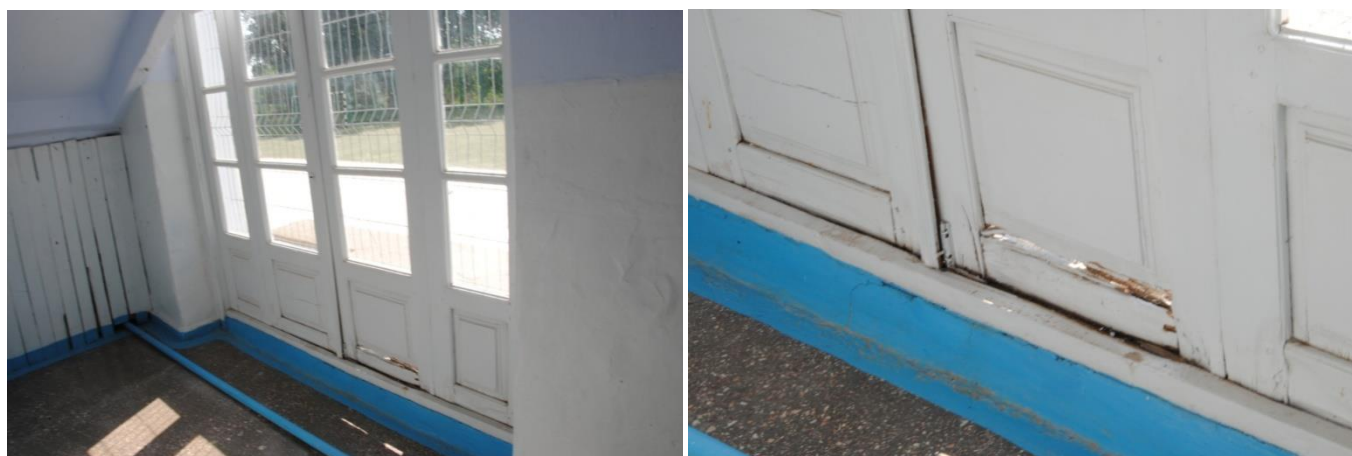
Figura 17 Tâmplărie veche cu defecțiuni ce se surpă
