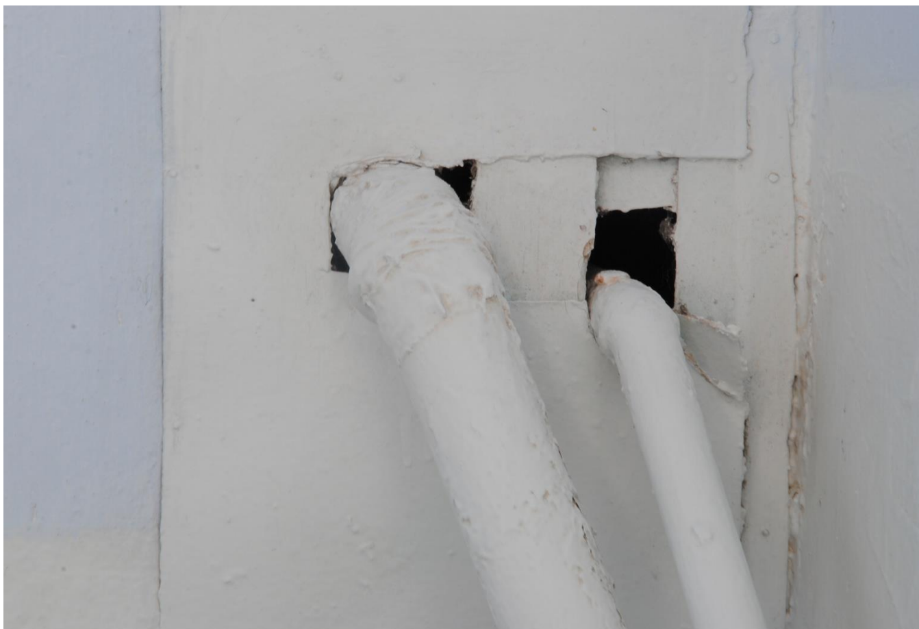
Figura 19 Imaginea conductelor defectate al sistemului de distribuție a agentului termic
