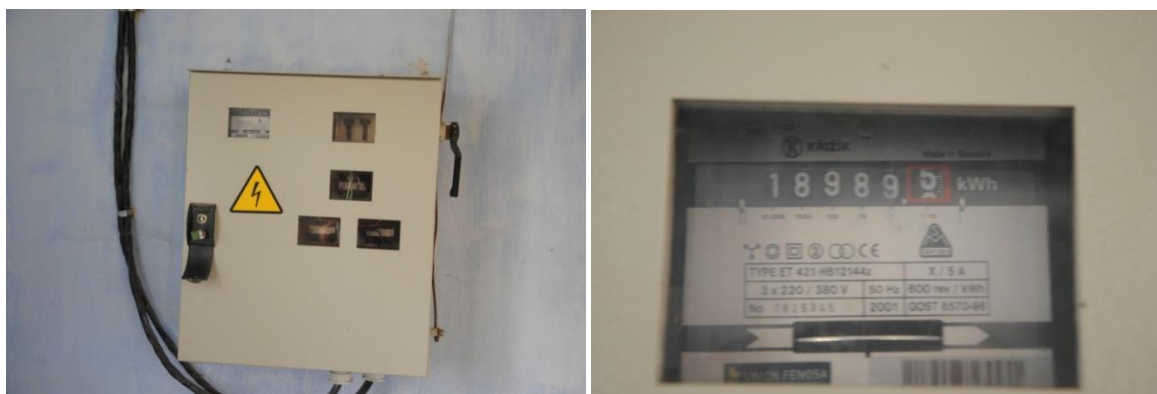
Figura 11 Imagine foto ale contorului de evidență a energiei electrice
