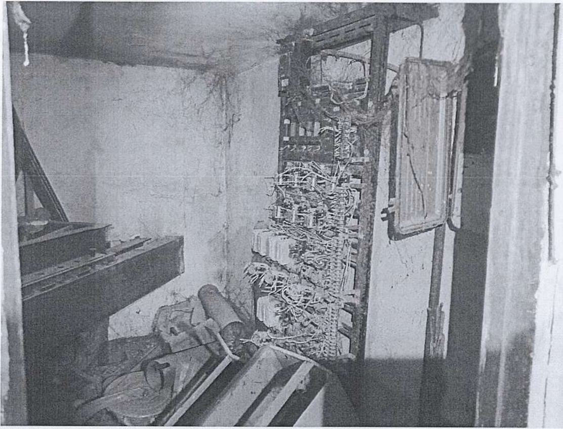
Foto nr. 9. Starea tehnică a încăperii tehnice și utilajului ascensorului.
