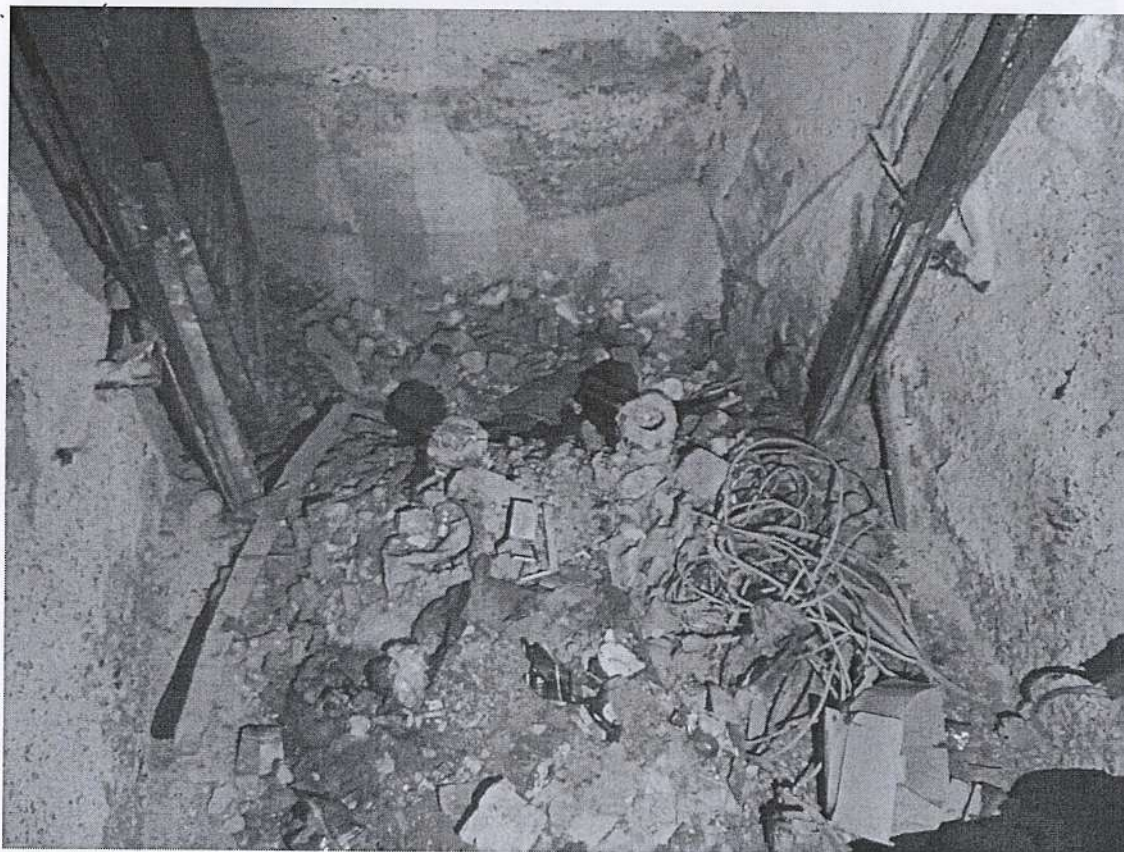
Foto nr. 2. Vedere a ascensorului în subsolul clădirii. Groapa de frinare.
