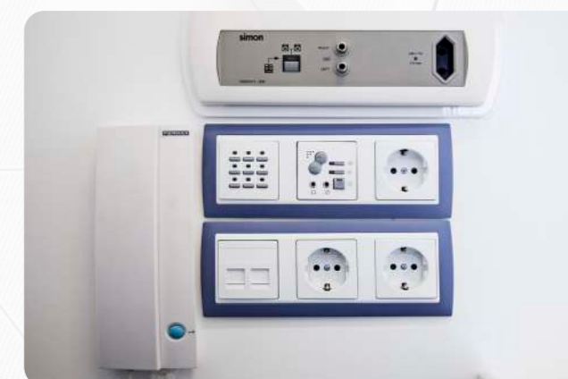
Instalación eléctrica adaptada Adapted electrical installation
