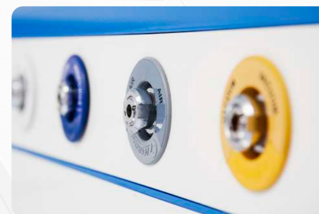
Instalación de gases medicinales Installation of medicinal gases
