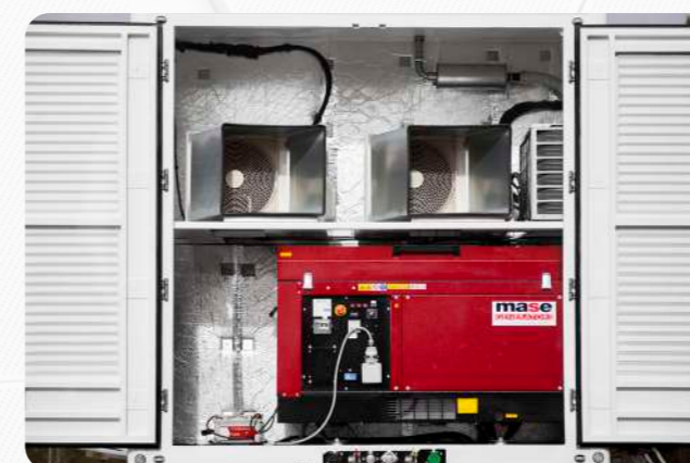
Funcionamiento autónomo: grupo electrógeno o conexión a red local Self-sufficient functioning: generator set or connection to local network
