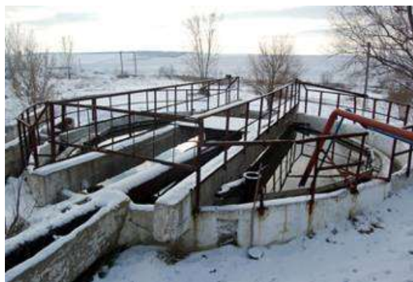
Stație de epurare pe timp de iarnă
