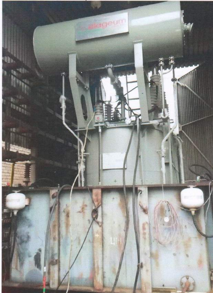
Трансформатор ТДН-16000/110 У1, зав. № 2104TDS004 во время испытаний
