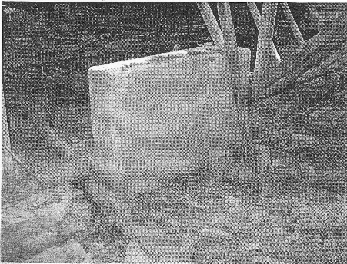
Anexa nr.12. Blocurile de ventilare blocate în spațiul de pód
