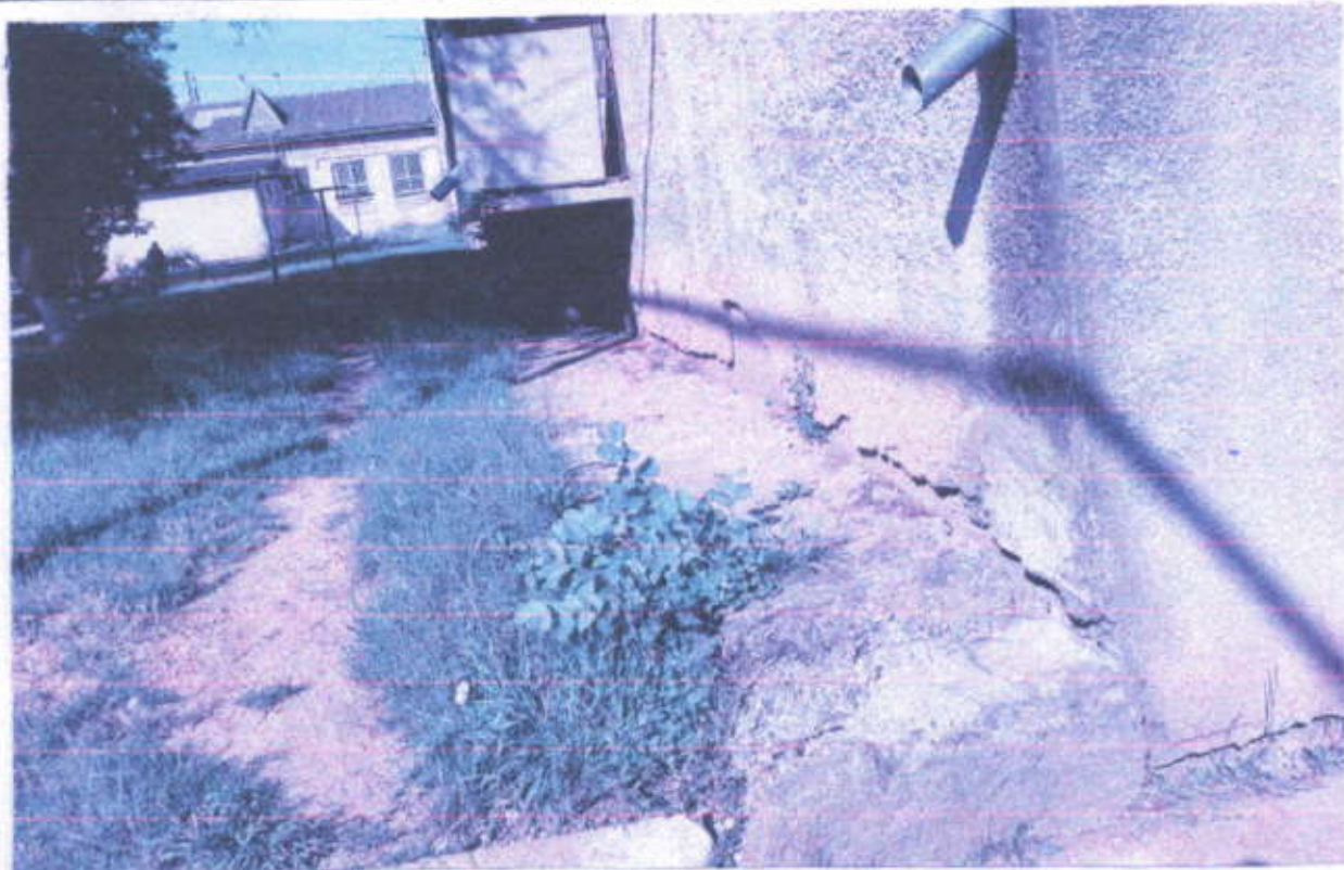
ФОТО 23. Вид просевшей отмости у стены блока 2 по продольной оси Д
