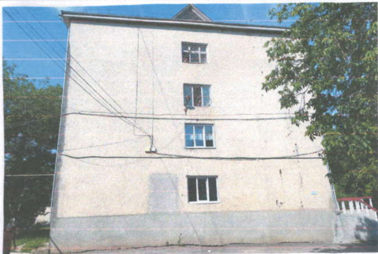
ФОТО 7. ВИД ТОРЦЕВОГО ФАСАДА БЛОКА 2; ОТМОСТКА ПОВСЕМЕСТНО ПРОСЕЛА
