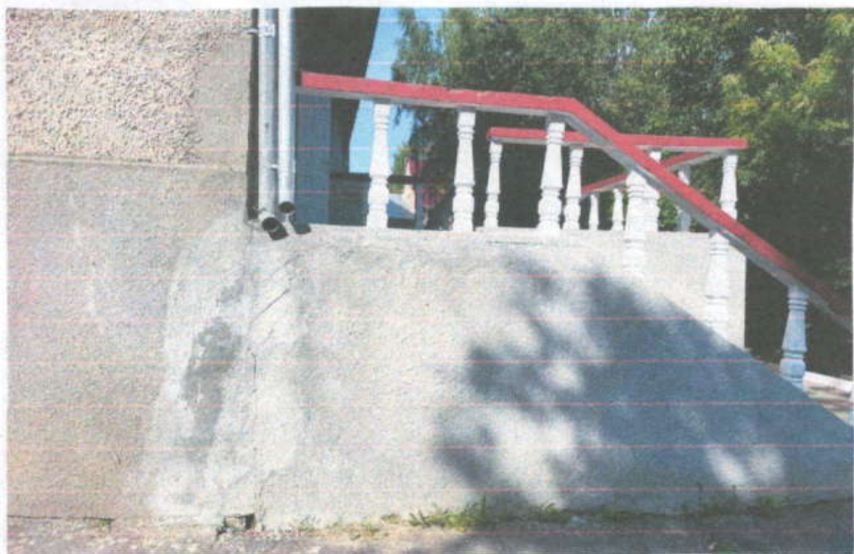
ФОТО 4. ВИД НАРУЖНОЙ ЛЕСТНИЦЫ С ПЛОЩАДКОЙ И ПАНДУСОМ, КОТОРАЯ ИМЕЕТ НЕКОТОРОЕ ПРОСЕДАНИЕ
