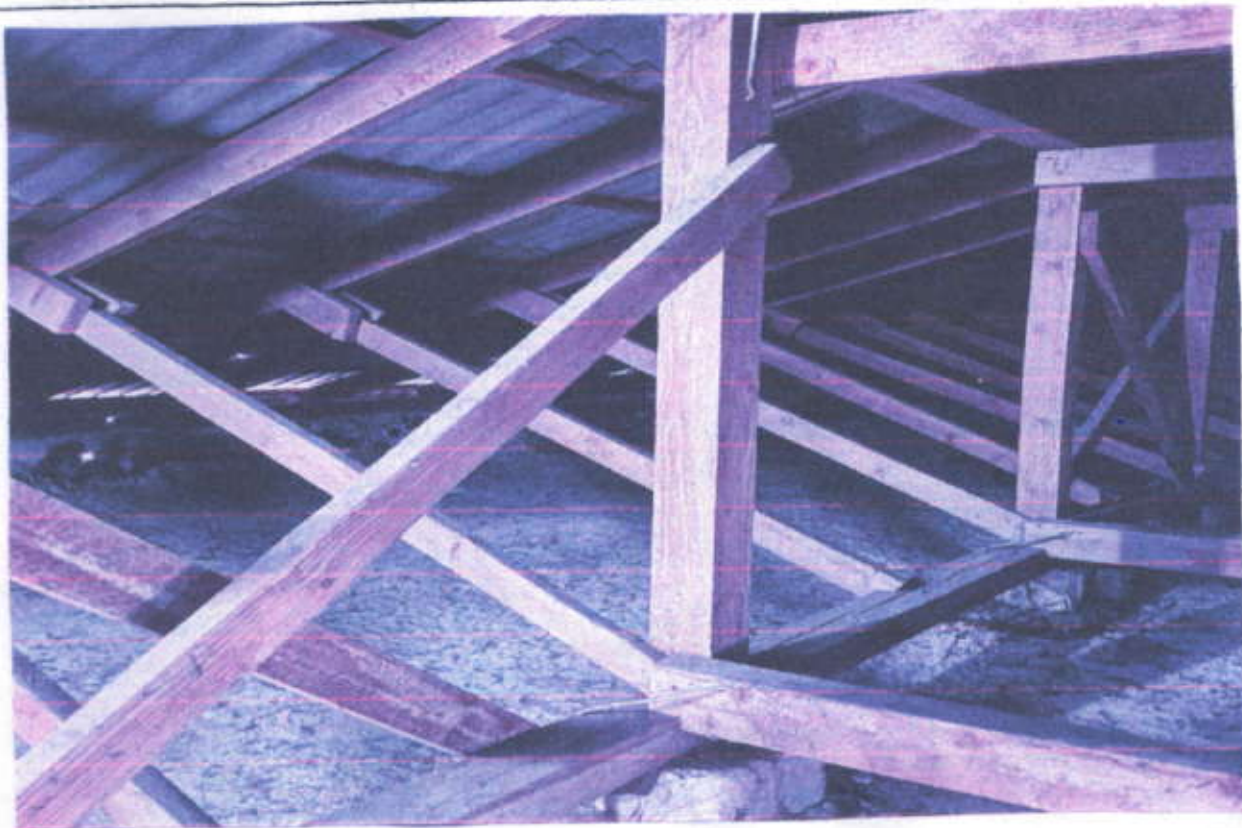
ФОТО 15. Вид состояния подкосов и стоек стропильной крыши над блоком 2
