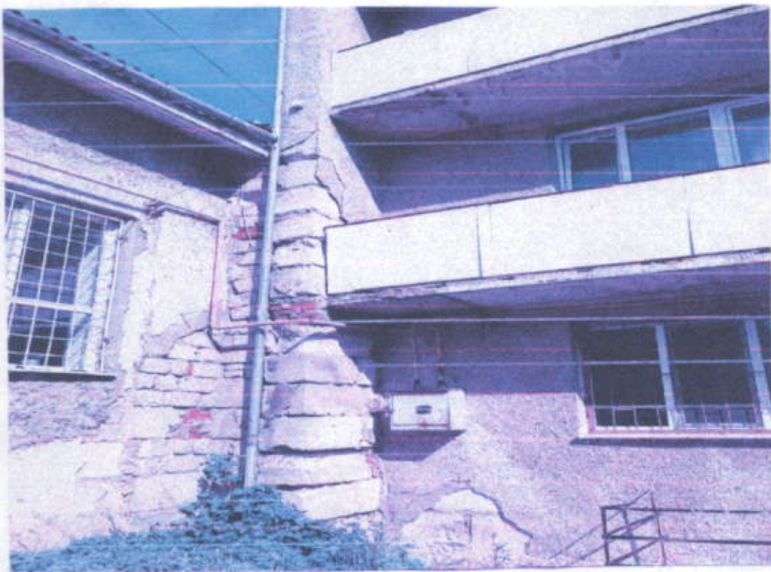
ФОТО 17. Вид состояния фрагмента торцевой стены по оси 8 у оси Д блока 2
