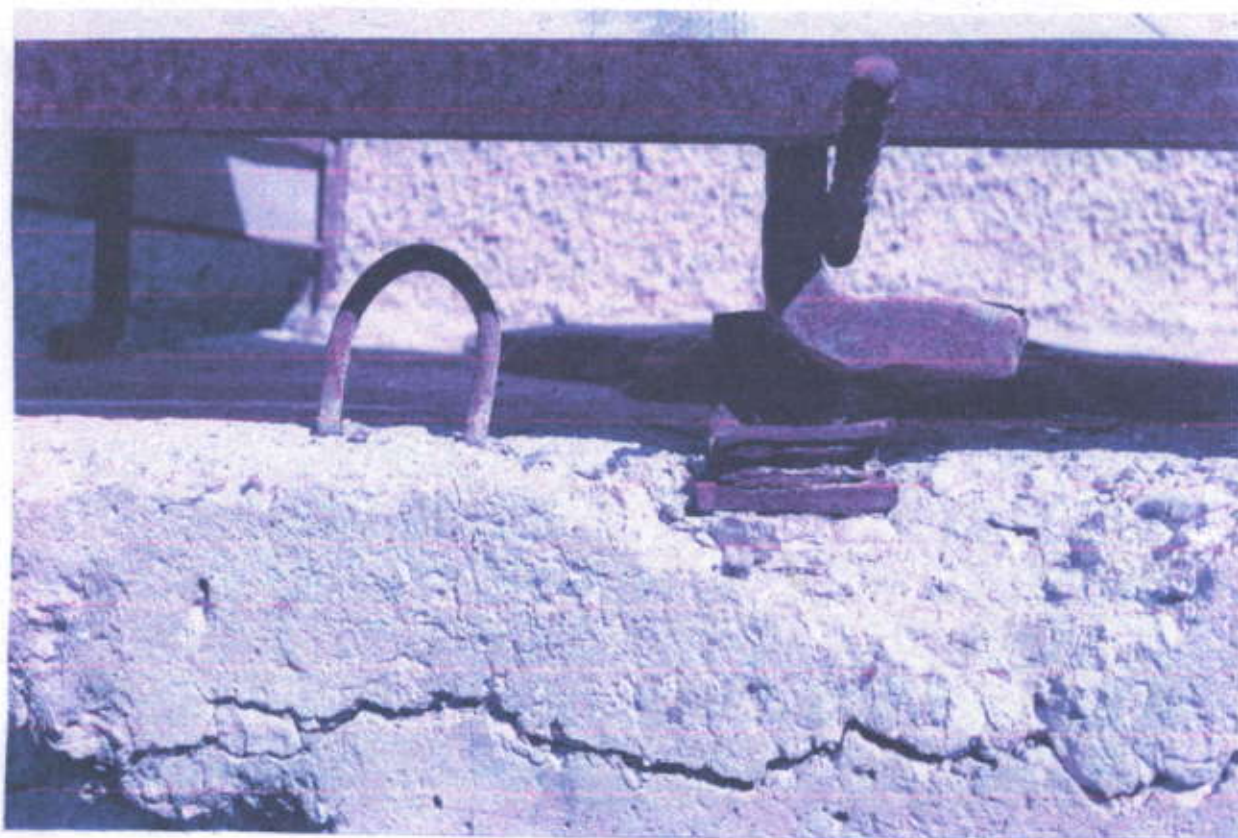
ФОТО 30. КОРРОЗИРОВАННЫЕ ЗАКЛАДНЫЕ ДЕТАЛИ ДЛЯ БАЛКОННОГО ОТРАЖДЕНИЯ УДАЛИТЬ И ВОССТАНОВИТЬ ЗАНОВО /ВОЗМОЖНО НА САМОАНКЕРУЮЩИХСЯ БОЛТАХ/
