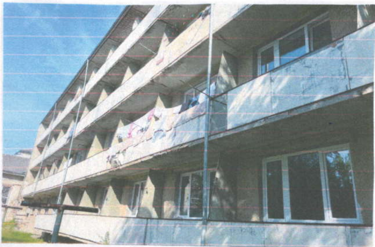
ФОТО 5. ФРАГМЕНТ СТЕНЫ БЛОКА 2 ПО ОСИ Д С НЕКОТОРЫМИ ПОБРЕЖАДЕННЫМИ БАЛКОННЫМИ ПЛИТАМИ
