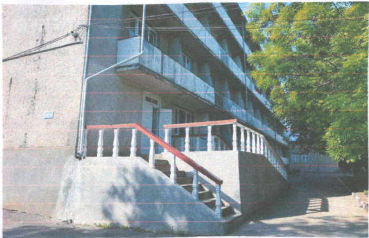
ФОТО 3. ФРАГМЕНТ СТЕНЫ ЖИЛОГО КОРПУСА /БЛОК 2/, ПО ПРОДОЛЬНОЙ ОСИ А
