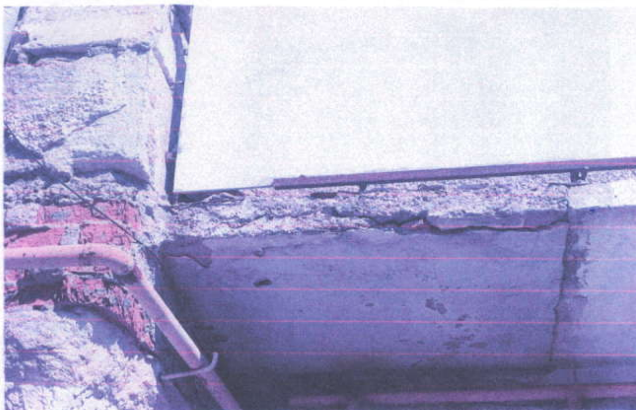
ФОТО 29. ПОВРЕЖДЕННЫЕ ТРЕЩИНАМИ КОНЦЕВЫЕ УЧАСТКИ БАЛКОННЫХ ПЛИТ РАСЧИСТЫТЬ ОТ ОТСЛАНВАННОГО БЕТОНА И ВОССТАНОВИТЬ ЗАНОВО ПОЛИМЕРНО-БЕТОННОЙ СМЕСЬЮ В20 В ТОЧНОЙ ОПАЛУБКЕ
