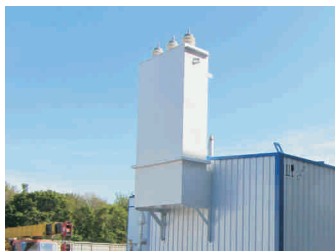
Рисунок 9. Башня ввода для подключения к воздушной линии
