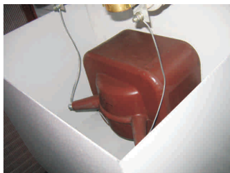
Рисунок 10. Трансформатор собственных нужд ОЛС
