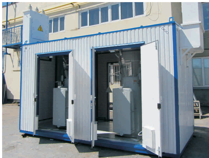
Рисунок 8. Блок автоматического регулирования 6-10 кВ
