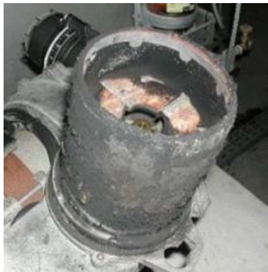
Пример грязной горелки
