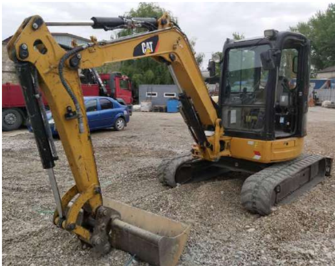
Figura 17. Vedere Nr.1 CAT-305 D
