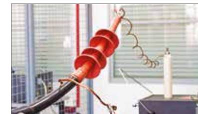
Высоковольтные испытания кабельных муфт
