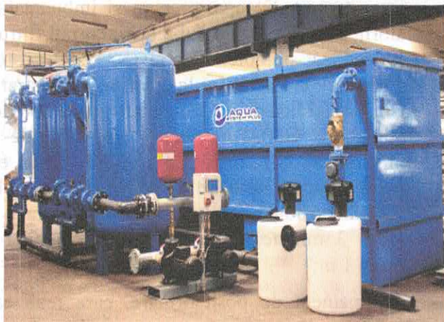
Stație compactă de tratare apă de suprafață SCT 50 mc - Barbatești, Valcea
