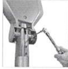
Grăm și greutate de față IzFix permite montajul lateral și în vârf de stâlp la orice înălțime și înclinare a aparatului de iluminat.
