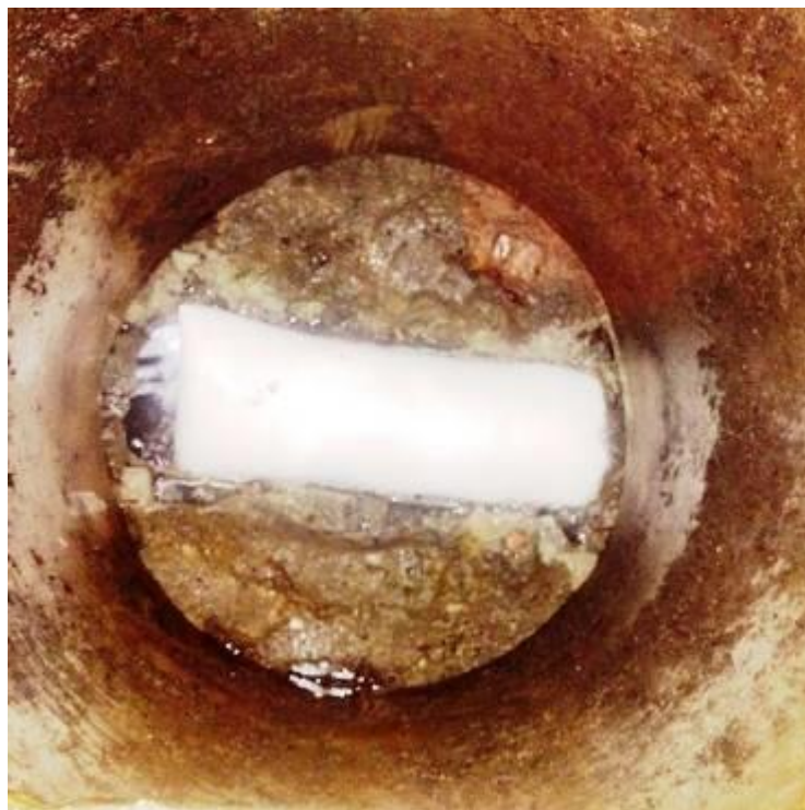
Material de camasuire inversat la trecerea prin camin de vizitare
