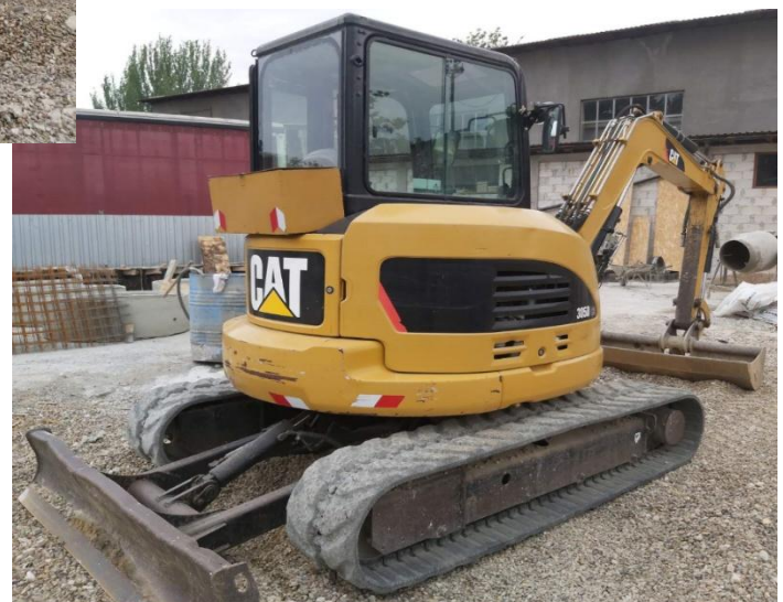
Figura 14. Vedere Nr.2 CAT-305 D
