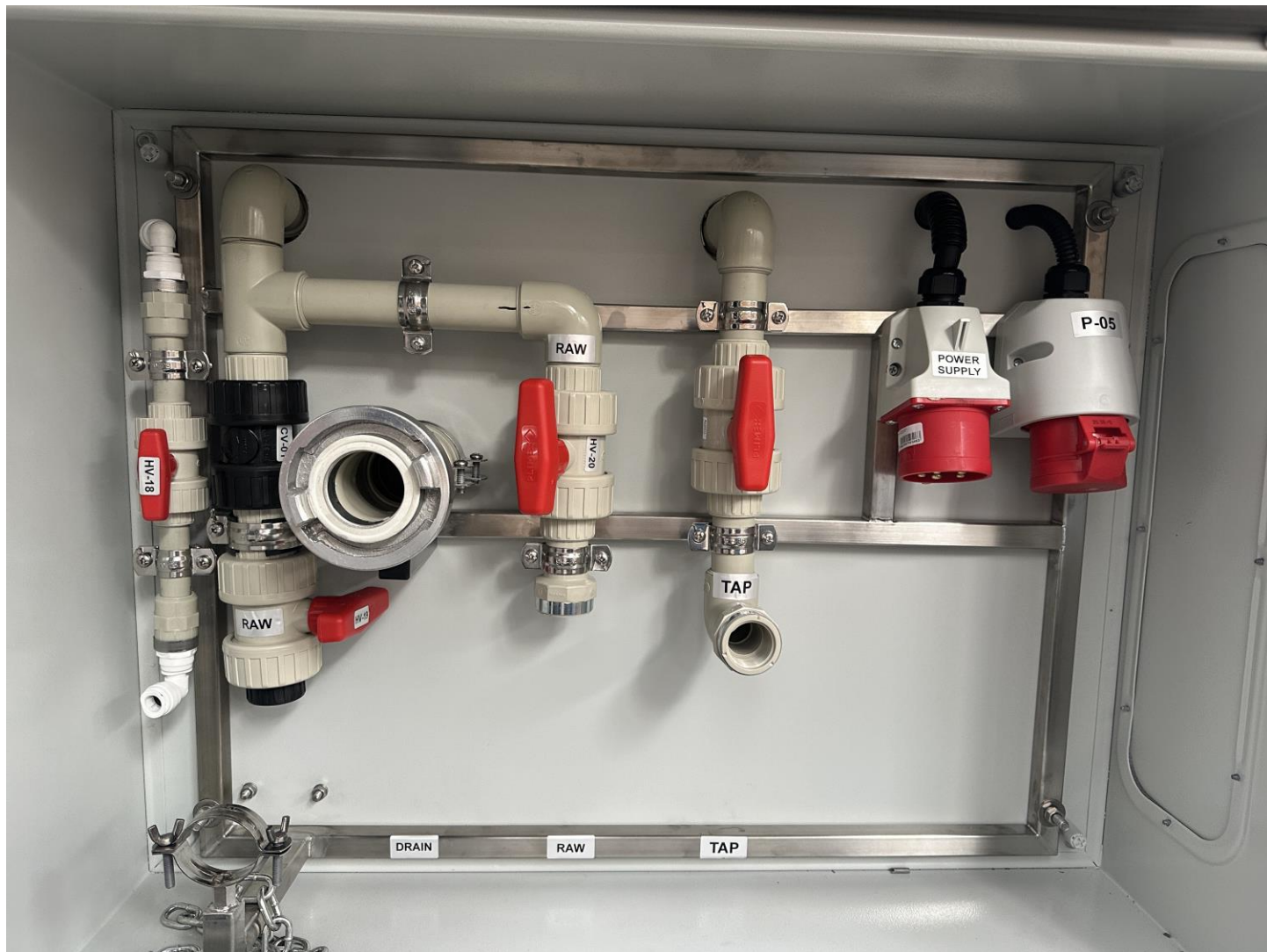
Узел подключения воды, дренажа и выхода очищенной воды.
