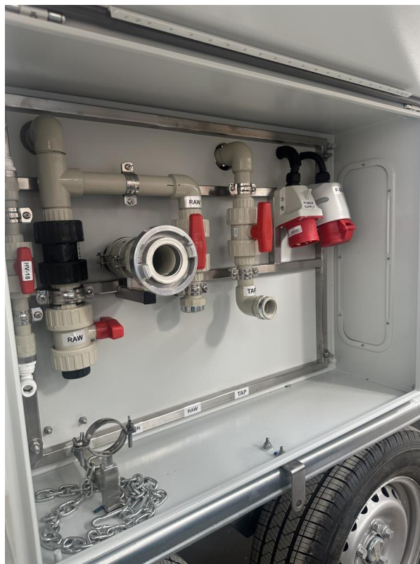
Ящик подключения электропитания (левая сторона фургона)
