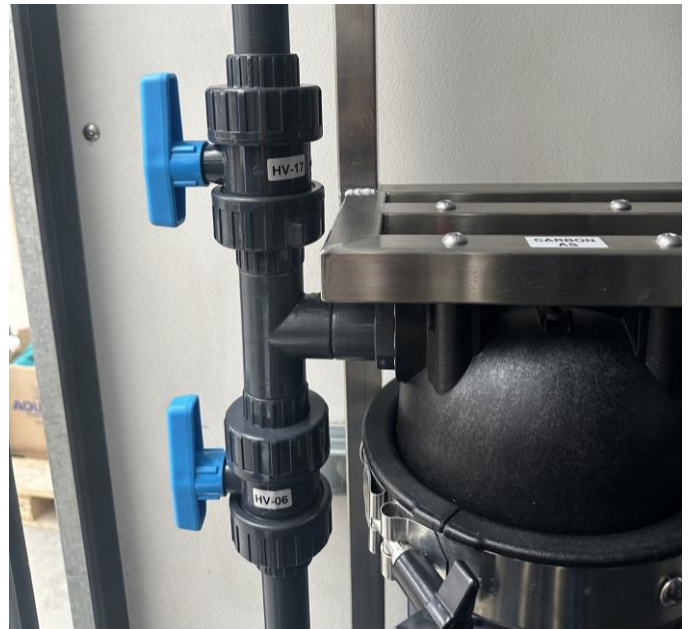
Положение крана HV-17 в открытом состоянии.
